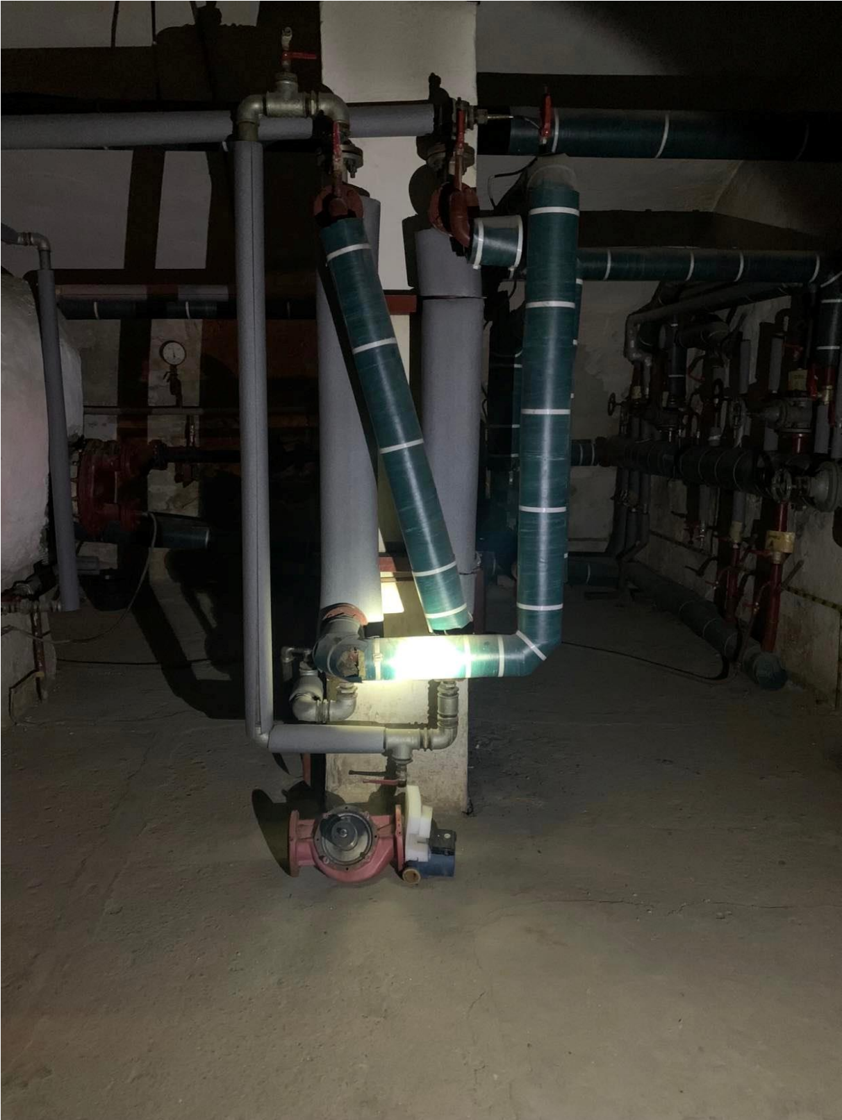
Pomieszczenie z zasobnikami c.w.u. - zdjęcia
