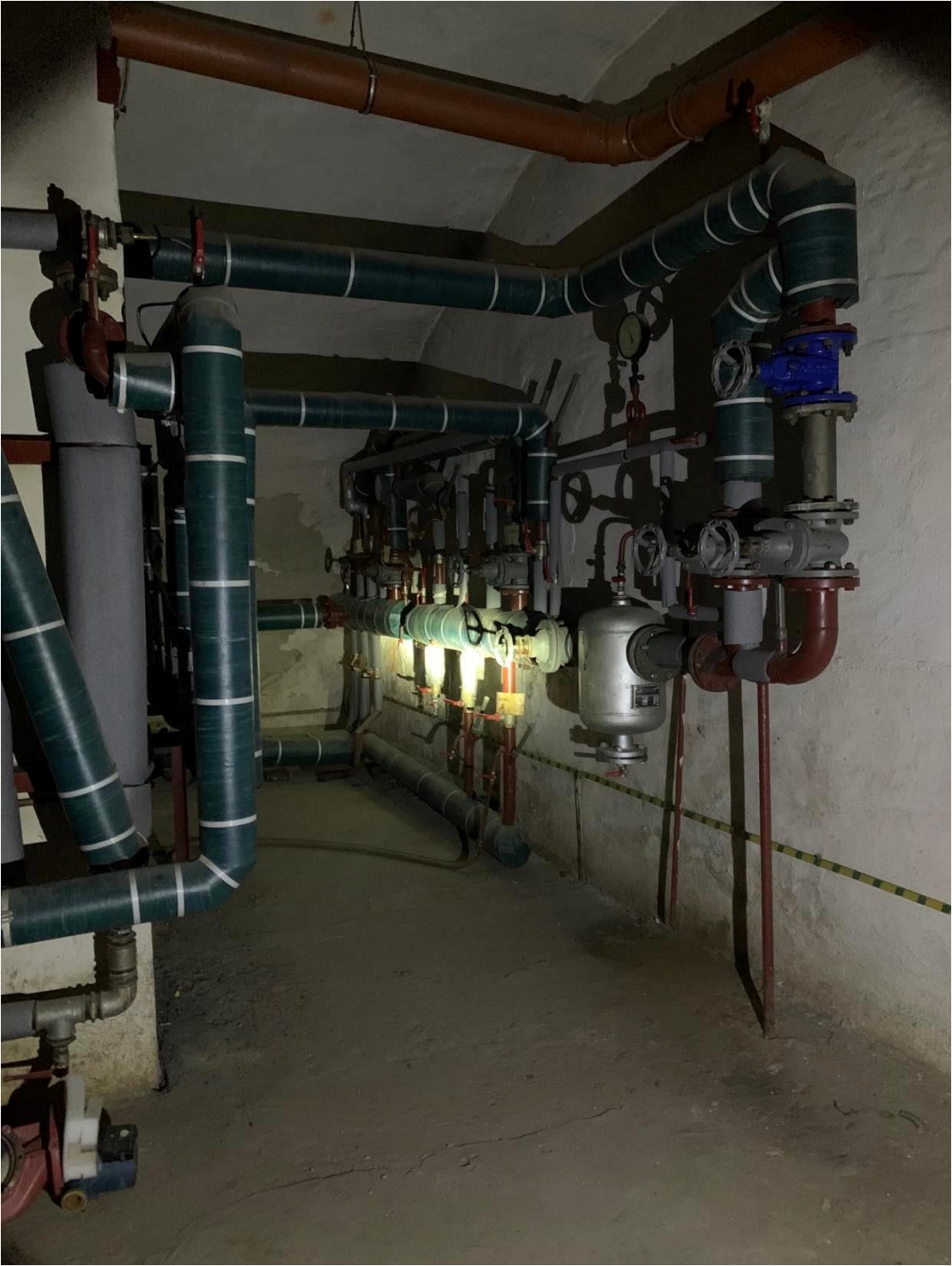
Pomieszczenie z zasobnikami c.w.u. - zdjęcia
