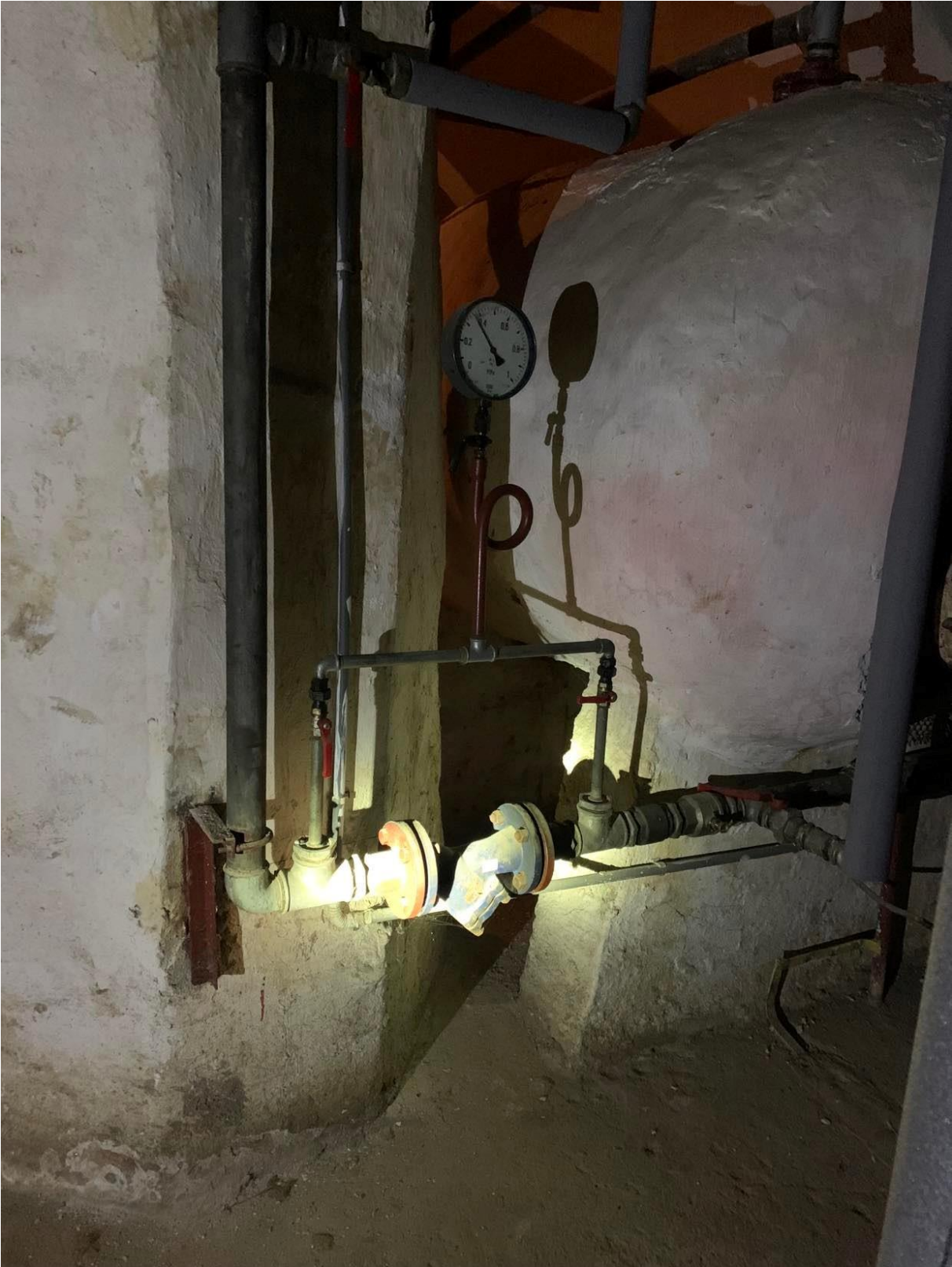
Pomieszczenie z zasobnikami c.w.u. - zdjęcia
