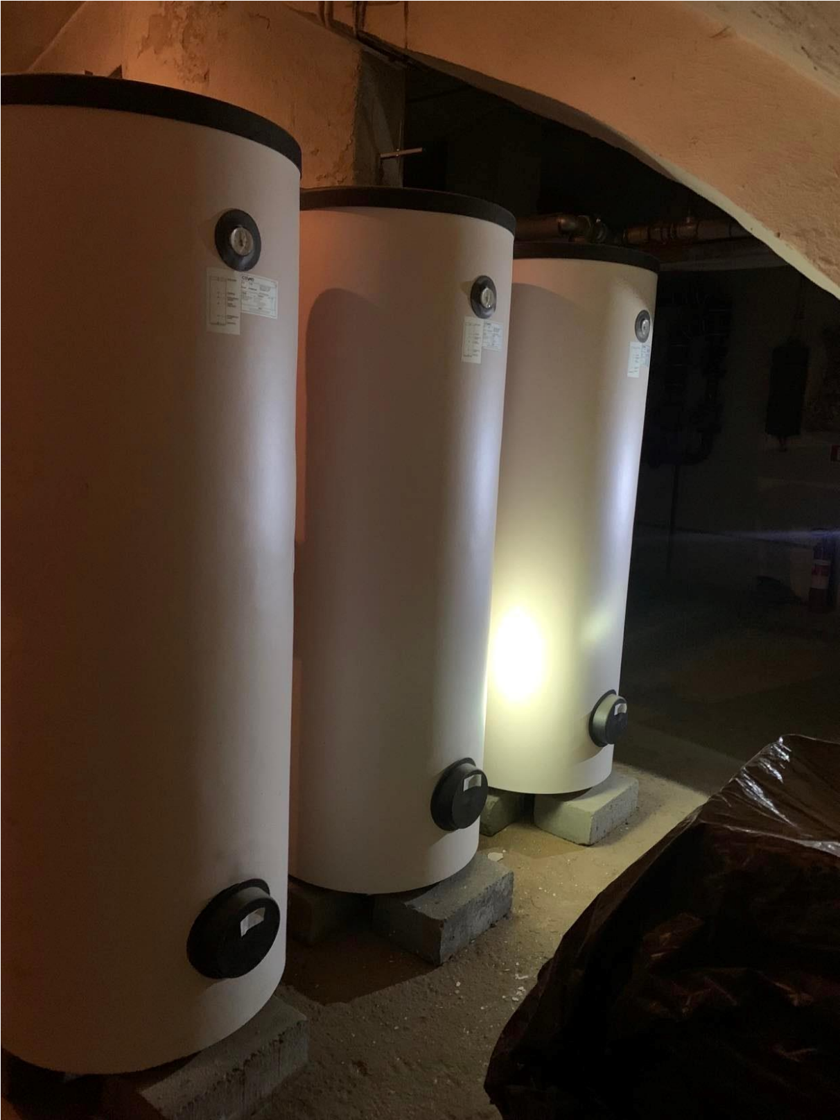
Pomieszczenie z zasobnikami c.w.u. - zdjęcia
