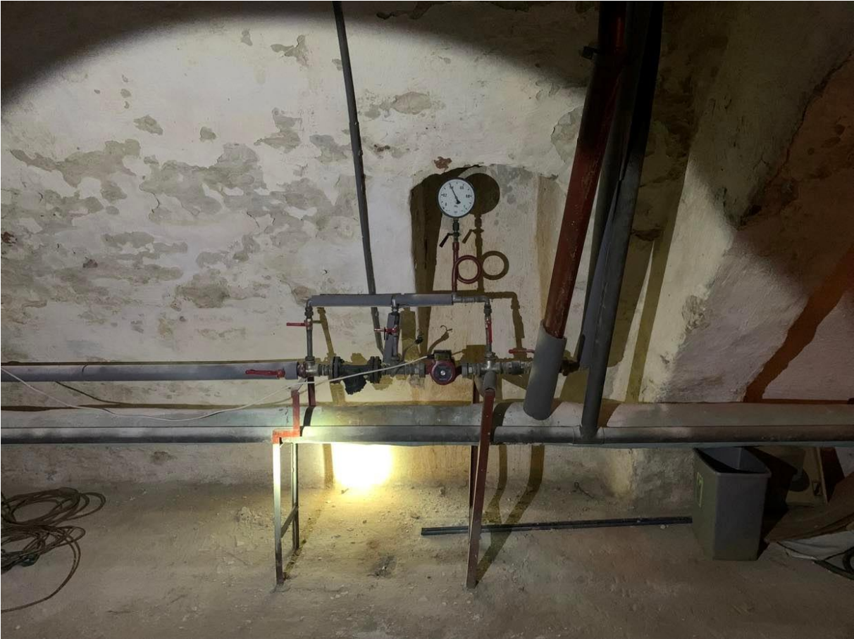
Pomieszczenie z zasobnikami c.w.u. - zdjęcia
