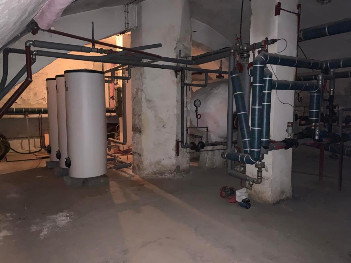
Pomieszczenie z zasobnikami c.w.u. - zdjęcia
