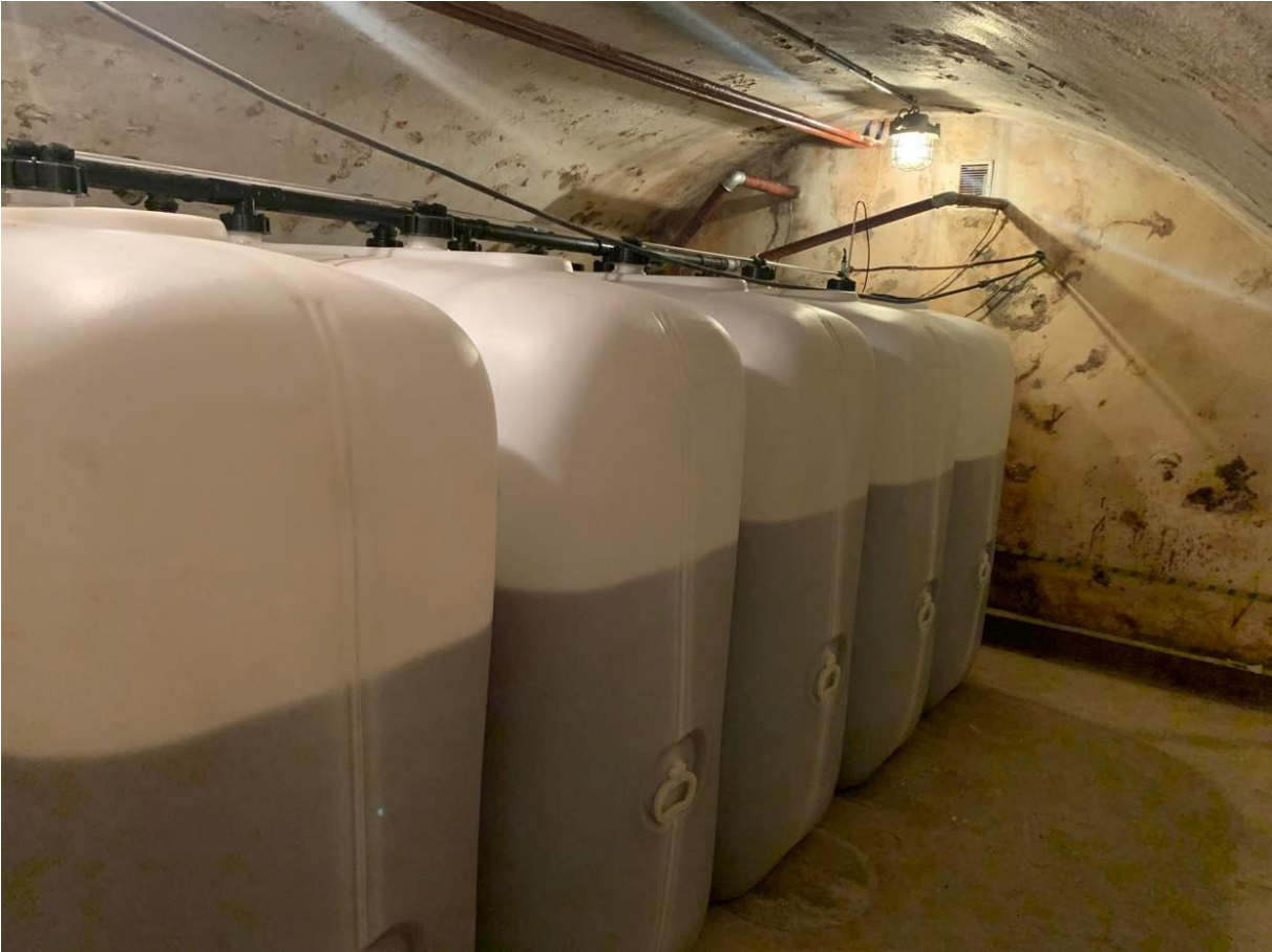
Pomieszczenie z zbiornikami oleju opałowego - zdjęcia
