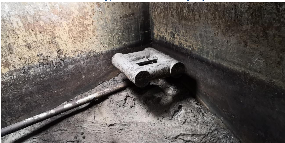
Fot. 22 Złogi piasku w komorze chemicznej
