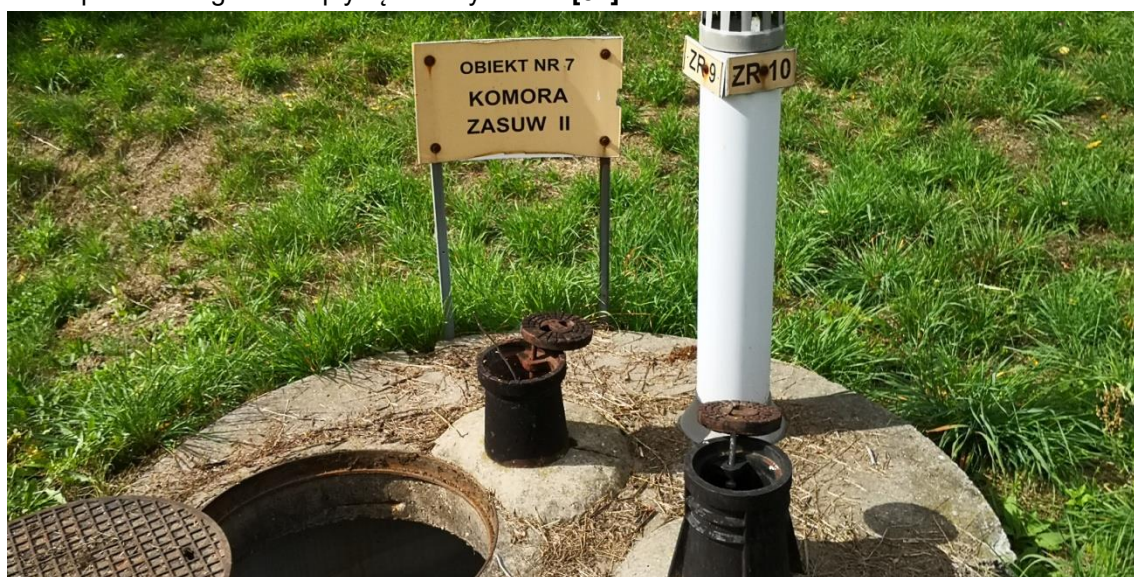
Fot. 12 Komora zasuw
