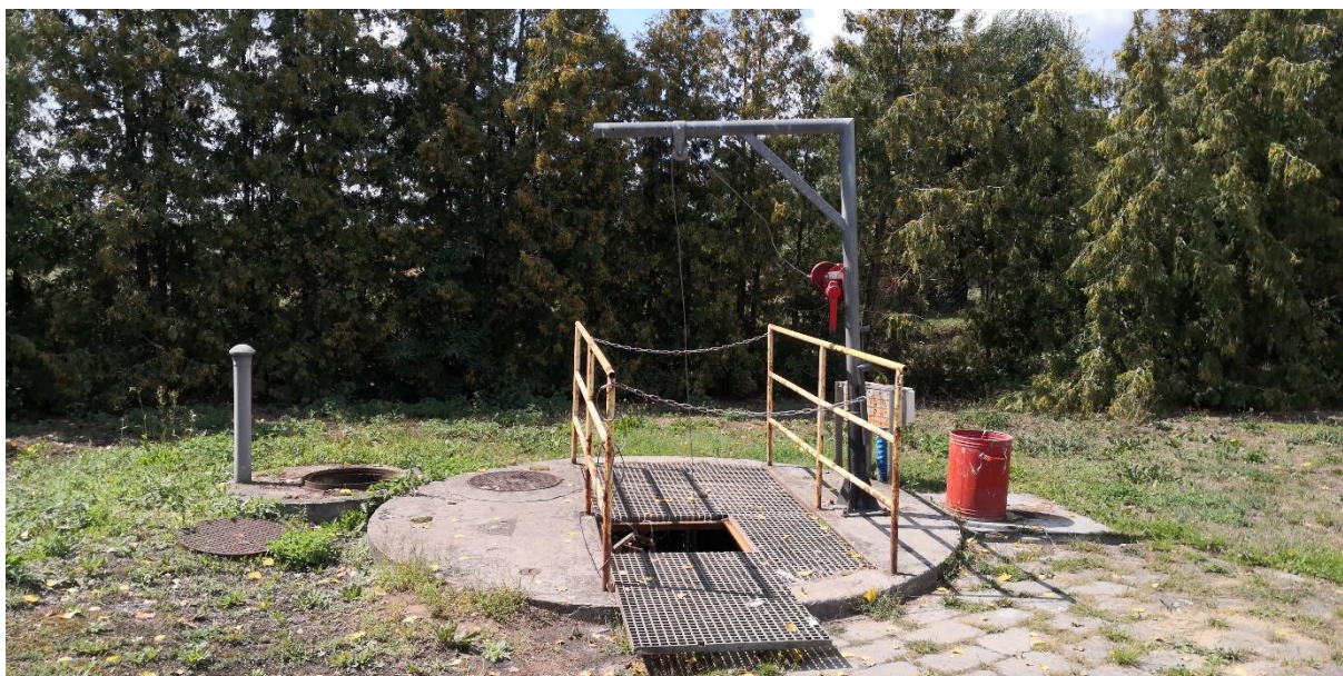
Fot. 23 Przepompownia przy ul. Szosa Bydgoska w Złotnikach Kujawskich
