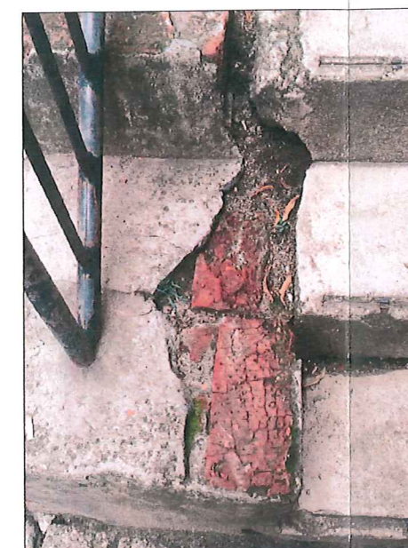
7. Szczegół uszkodzenia schodów
