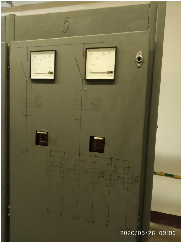
Pole 5 rozdzielni RG-2:
