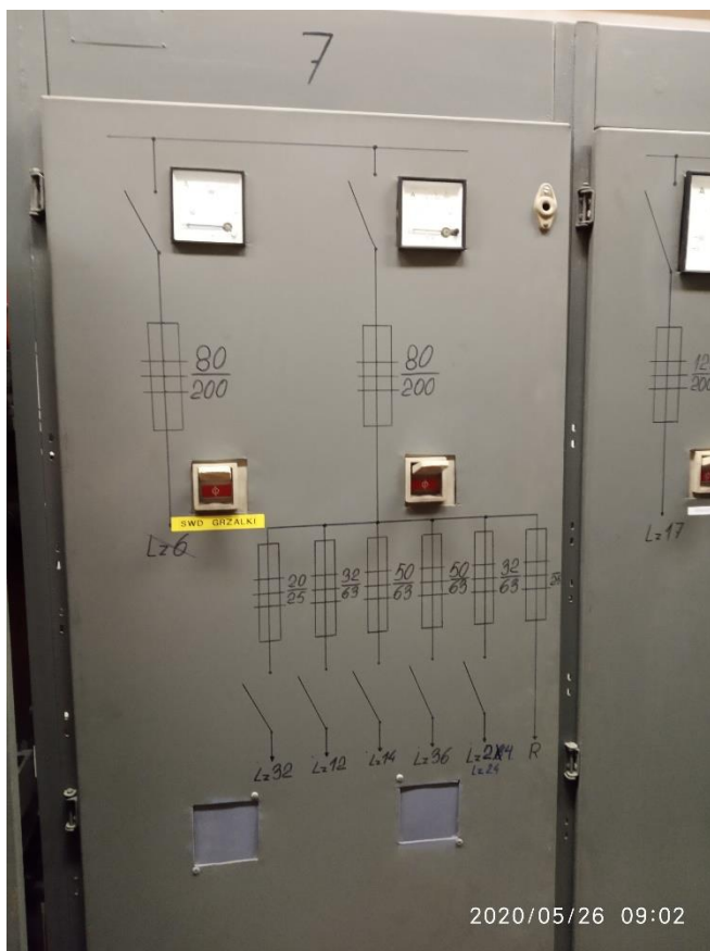
Pole 7 rozdzielnic RG-3:
