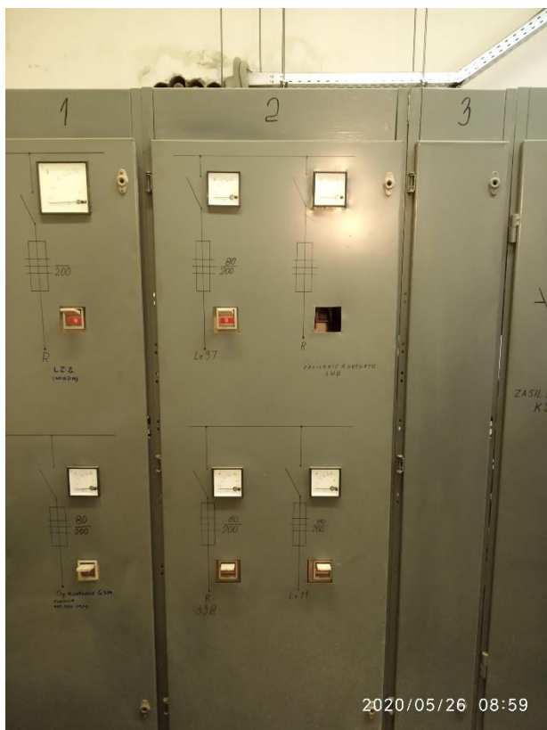
Pole 2 rozdzielni RG-3:
