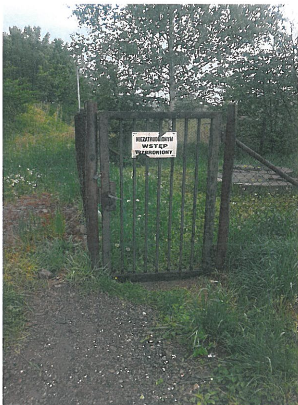
Punkt odczytu nr 5 - przepompownia
