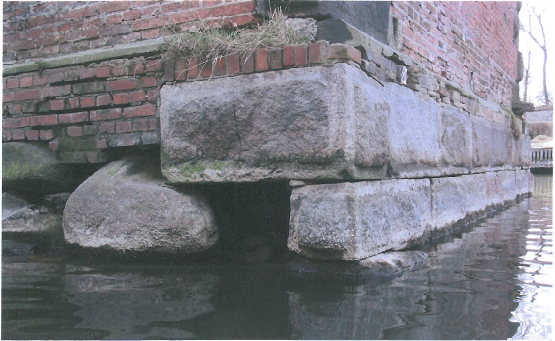
Fot. 9 Wnęki pomiędzy kamieniami w fundamencie Bastionu Południowo-Wschodniego
