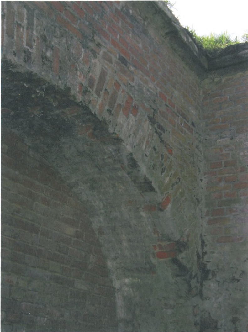
Fot. 15 Rozwarstwienia licówki na łukach w działobitni Bastionu Południowo- Wschodniego
