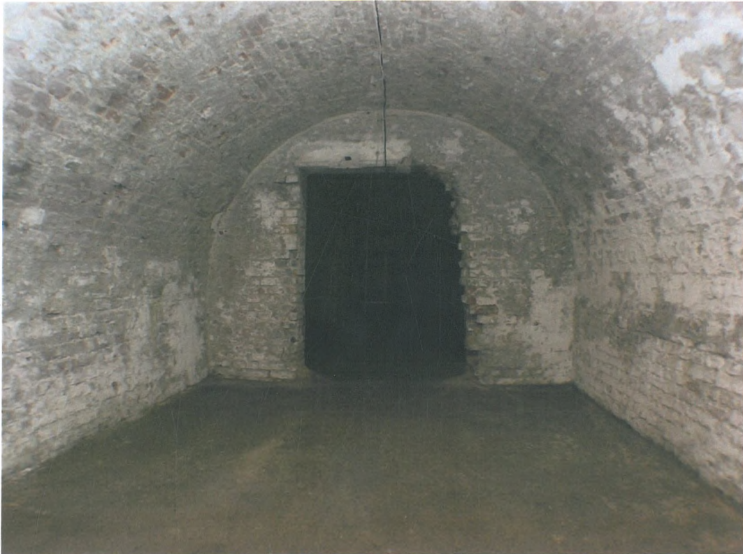
Fot. 11 Otwór prowadzący z tunelu wejściowego do kazamat; widoczne poszerzanie otworu wejściowego
