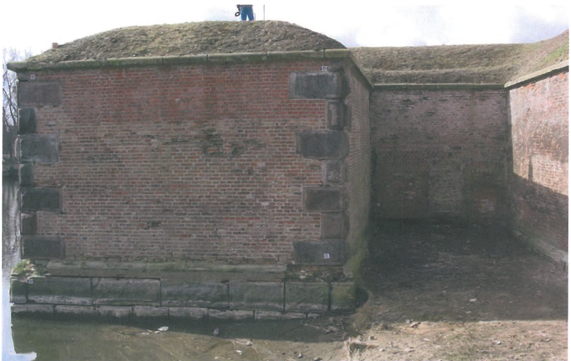
Fot. 2 Ucho pomiędzy Bastionem Południowo-Wschodnim a Murem Kurtynowym Wschodnim (od strony poterny)
