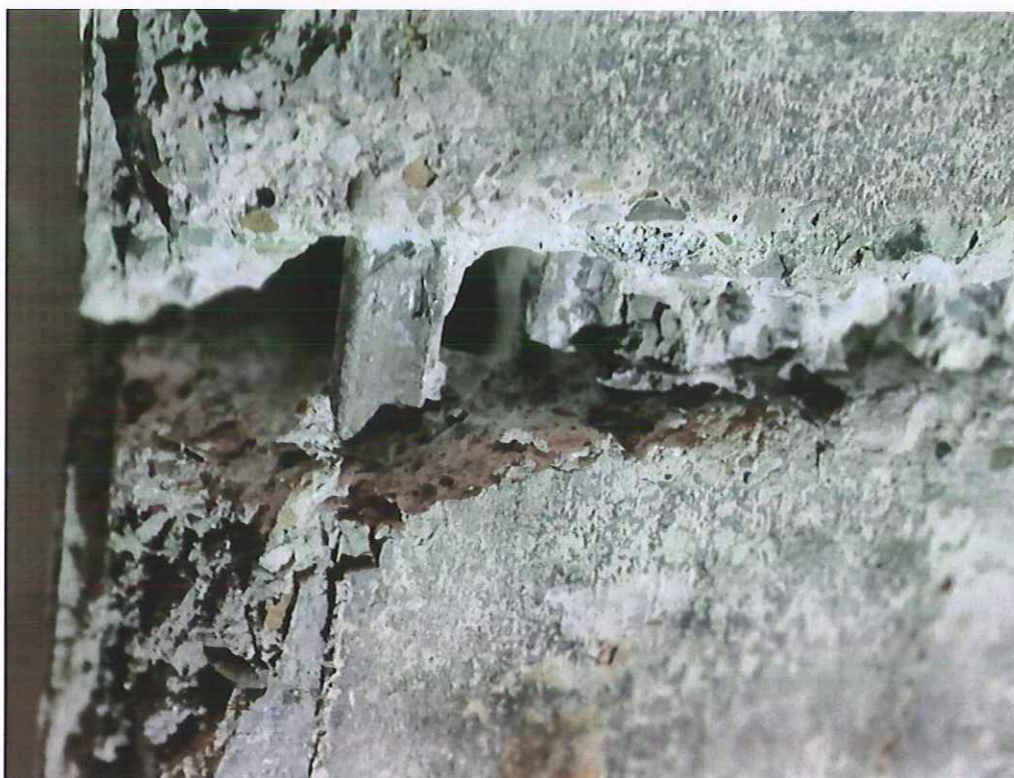
Fot.11. Szczegół odkrywki w ryglu. Widoczne zbrojenie.
