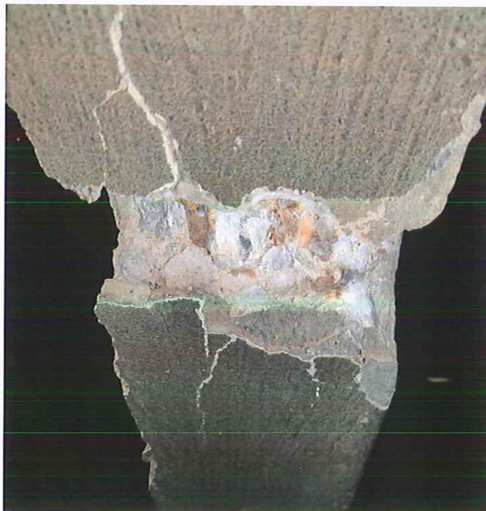
Fot.14. Odkrywka zbrojenia w słupie – widoczne pręty zbrojeniowe.
