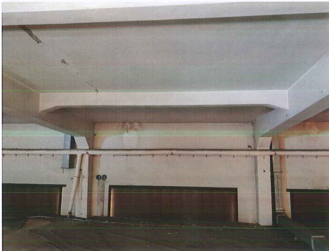
Fot.8. Szczegół oparcia rygli na słupach zewnętrznych. Widoczne spękania w płycie.
