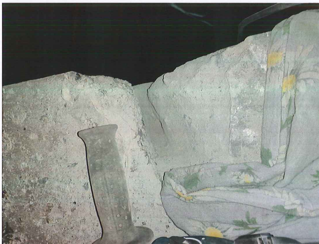
Fot.13. Odkrywka w ryglu nad podporą – głębokość odkrywki ~10cm – brak zbrojenia górnego.
