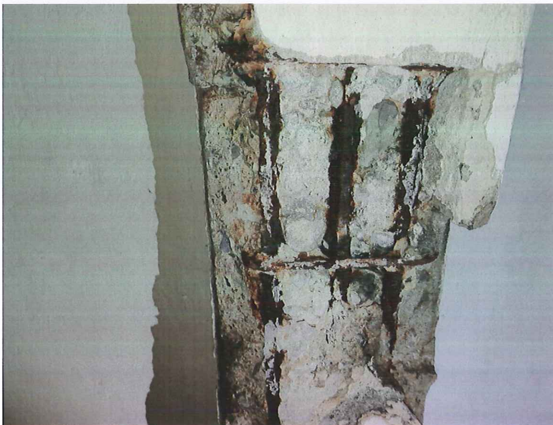
Fot.9. Odkrywka w zębrze. Widoczne pręty zbrojeniowe oraz strzemiona. Zaawansowana korozja zbrojenia.
