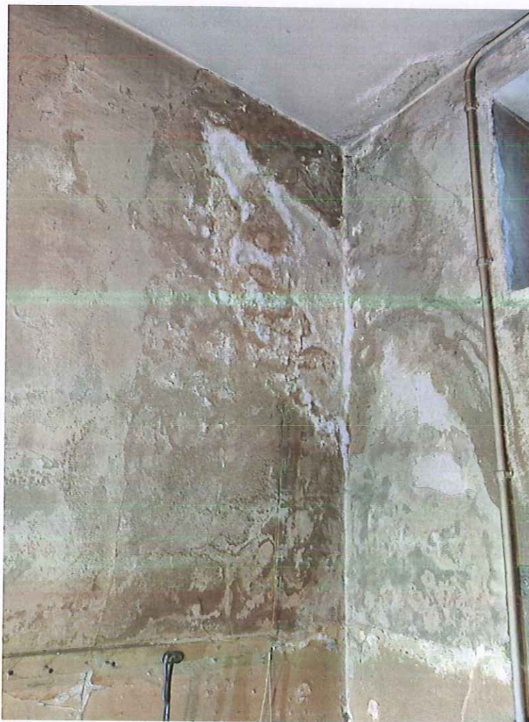
Fot.16. Przybudówka – widoczne zasolenie i zagrzybienie (grzyby rozkładu pleśniowego) ściany spowodowane zalewaniem.
