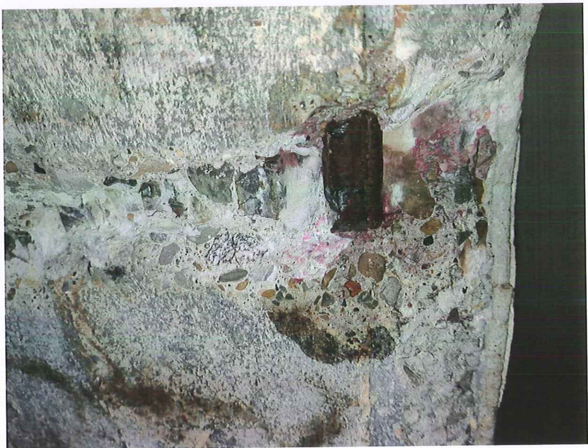
Fot. 1 Badanie stopnia karbonatyzacji metodą fenoloftaleiny - słup. Kolor fioletowy wskazuje na brak karbonatyzacji betonu od głębokości 1-1,5cm.
