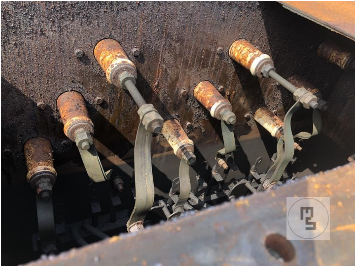
Fot. 12 Stan zachowania instalacji
