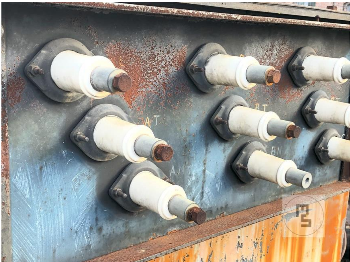
Fot. 3 Stan zachowania, izolatory przepustowe
