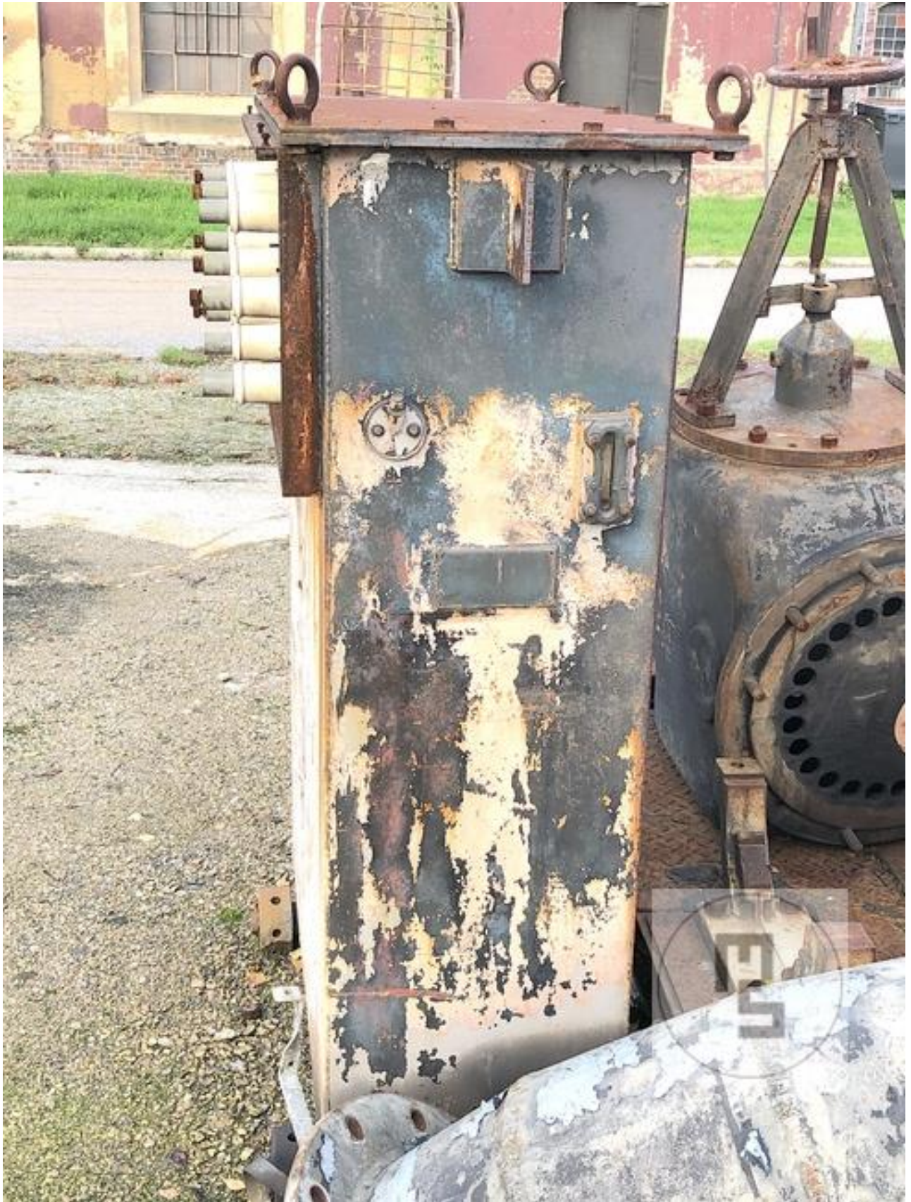
Fot. 1 Stan zachowania
