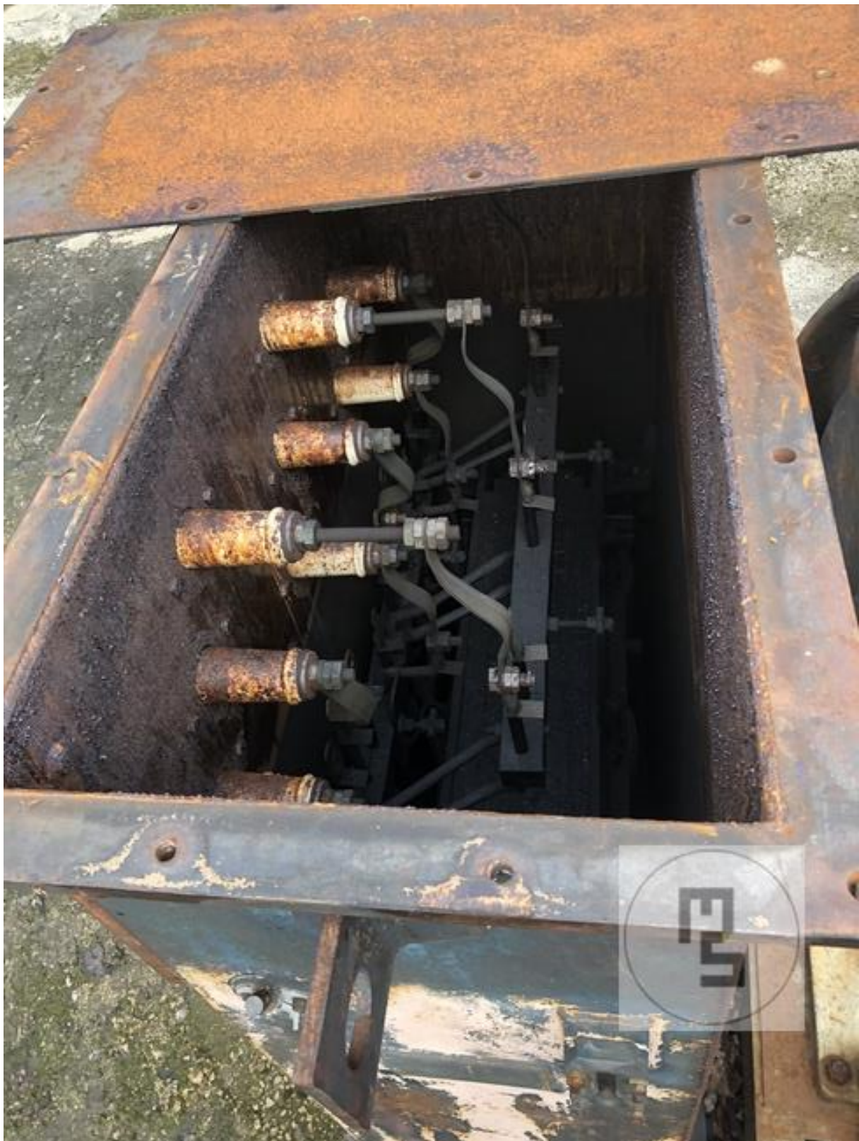
Fot. 11 Stan zachowania instalacji elektrycznej
