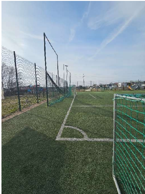
Fotografia 7. Siatki przeznaczona do wymiany.
