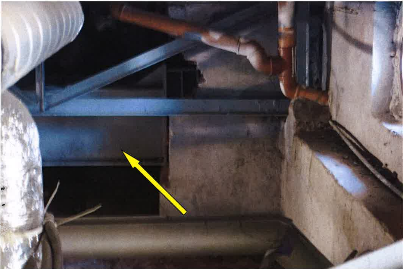
Fot. 41. Zagruzowana szczelna między belką a murem uniemożliwia swobodny (termiczny) przesuw belki.
