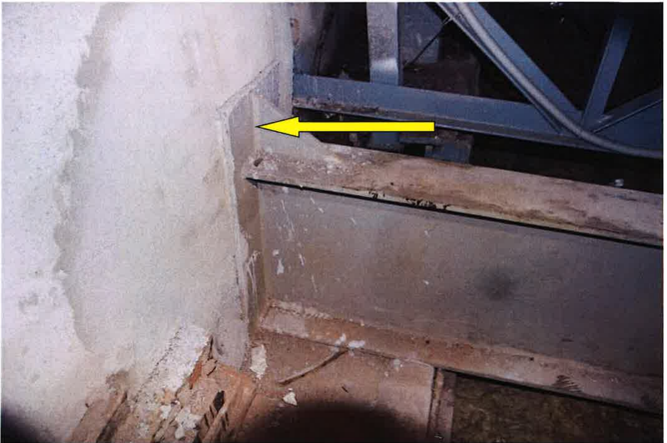
Fot. 38, 39. Poddasze nad Salą Króla Stan. Leszczyńskiego. Belka stalowa zamontowana czołowo do ściany nad stropem pomieszczenia. Poziome termiczne wydłużenie przesuwia ścianę.
