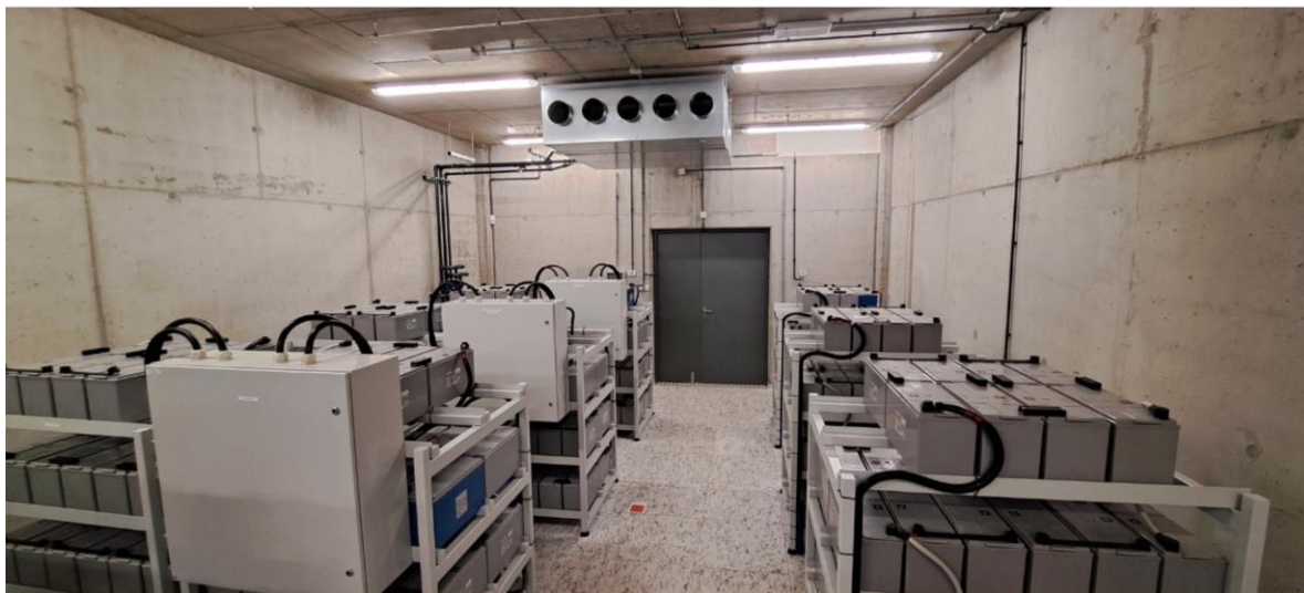
Rysunek 1 Pomieszczenie -1.09 wraz z bateriami
