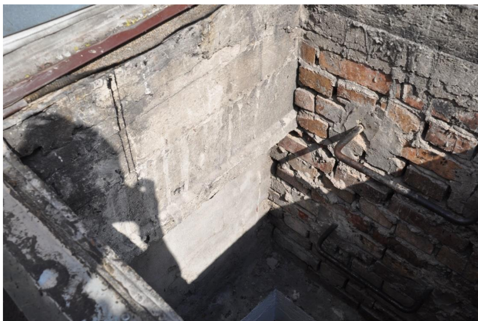
Fot. 6. Wyrwane z muru klamry schodowe, brak kabłąka zabezpieczającego „drabinę”
