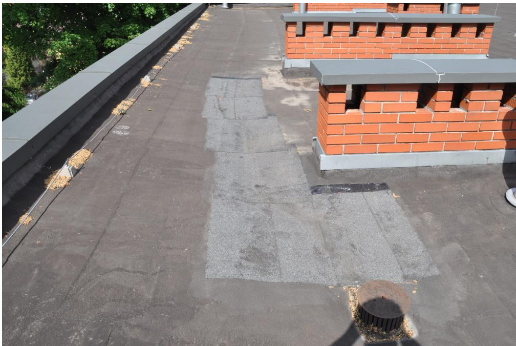
Fot. 8. Liczne naprawy nieszczelnego pokrycia dachowego, widoczne „purchle” powietrzne Wpust dachowy
