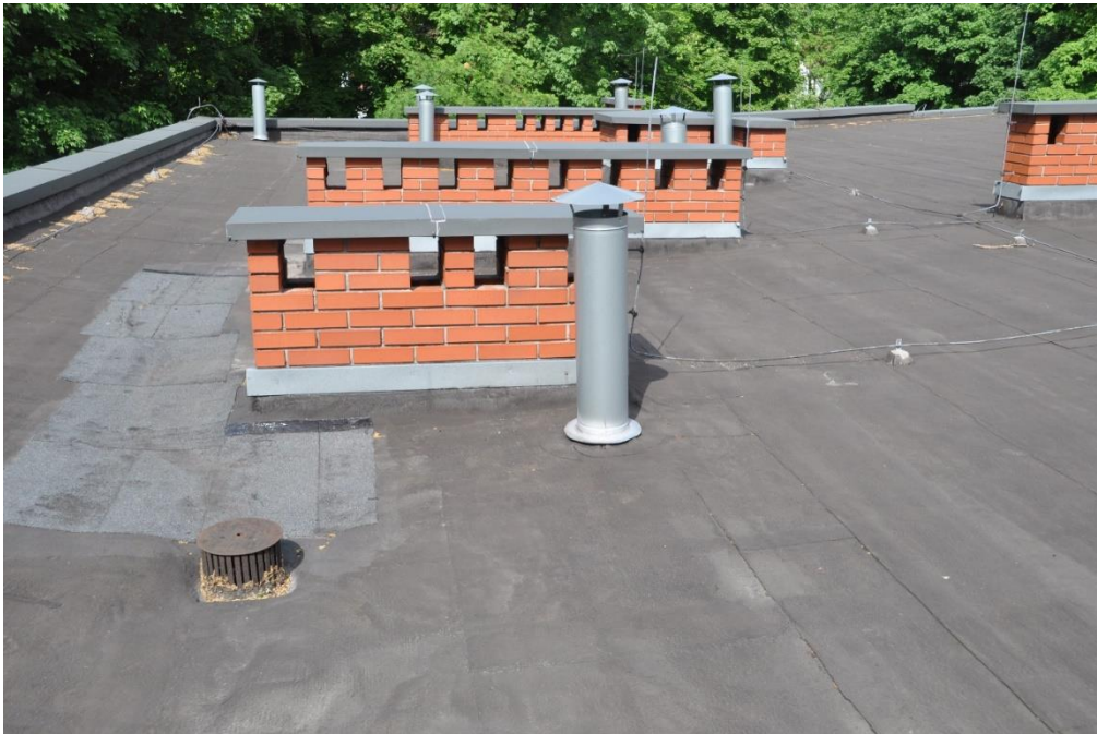
Fot. 7. Liczne naprawy nieszczelnego pokrycia dachowego, widoczne „purchle” powietrzne Wpust dachowy
