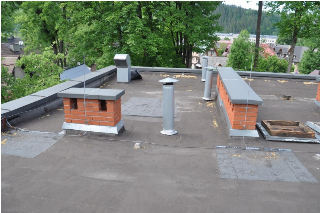
Fot. 3. Liczne naprawy nieszczelnego pokrycia dachowego, widoczne „purchle” powietrzne
