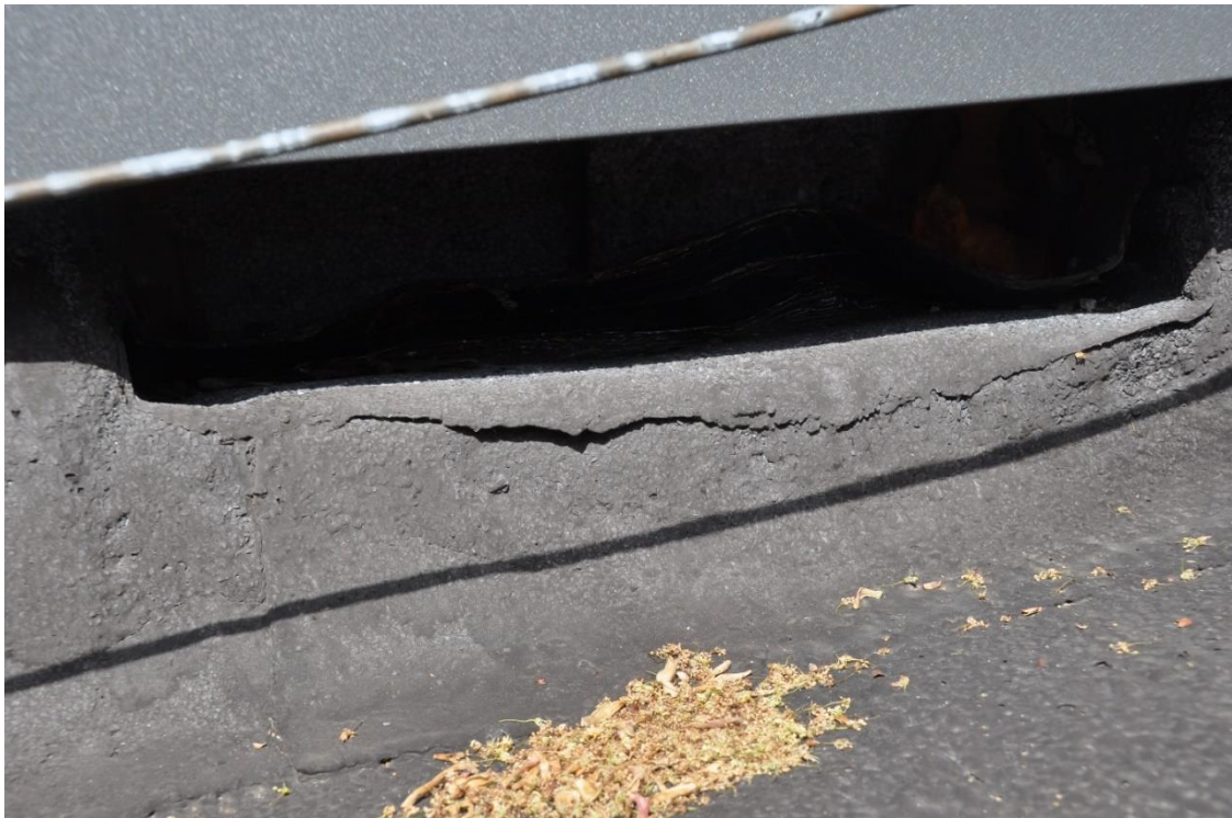
Fot. 10. Pęknięcia pokrycia dachowego
