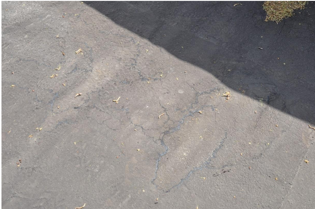
Fot. 11. Pęknięcia i zarysowania pokrycia dachowego w miejscach „purchli” dachowych
