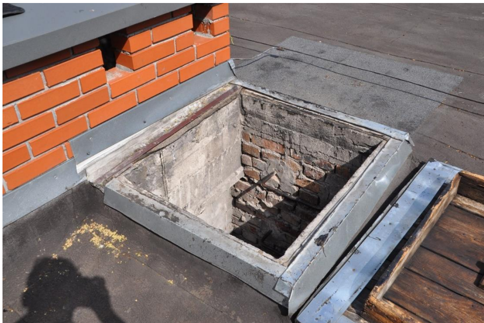
Fot. 5. Zniszczony wylaz dachowy – do wymiany
