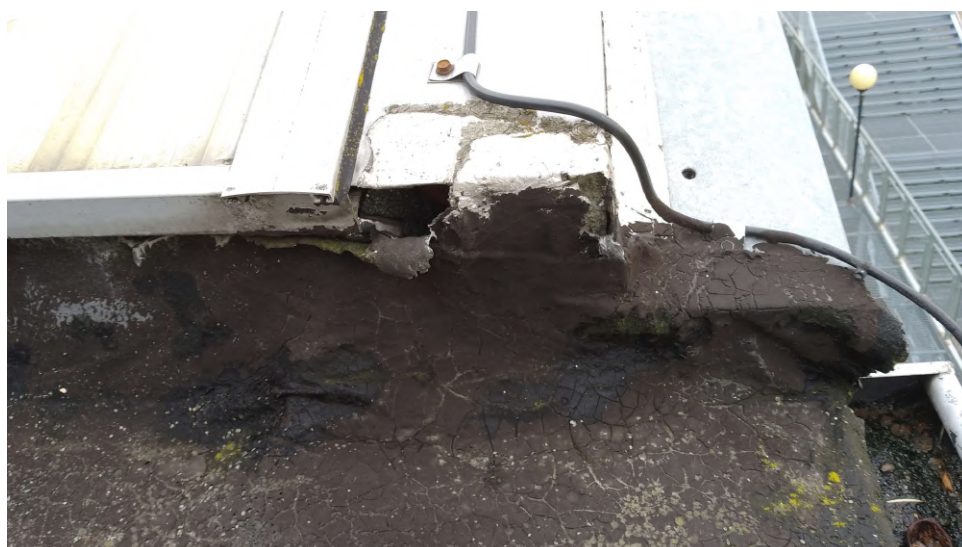
Zdjęcie nr 7. Stan świetlików i ich obróbek.
