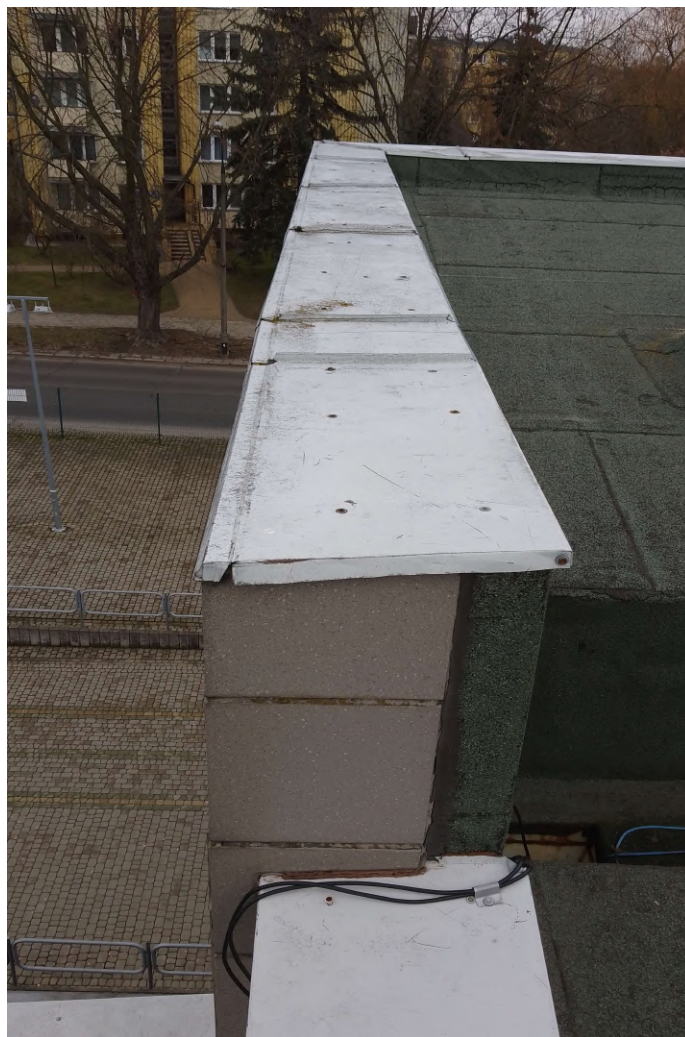
Zdjęcie nr 4. Stan aktualny obróbki blacharskiej attyki
