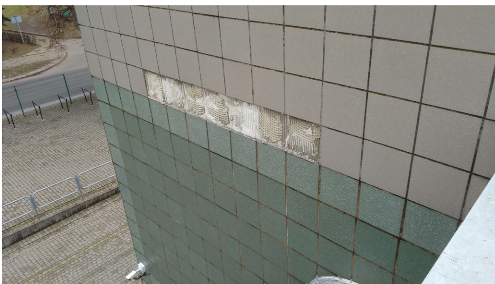
Zdjęcie nr 3. Ubytki w elewacji
