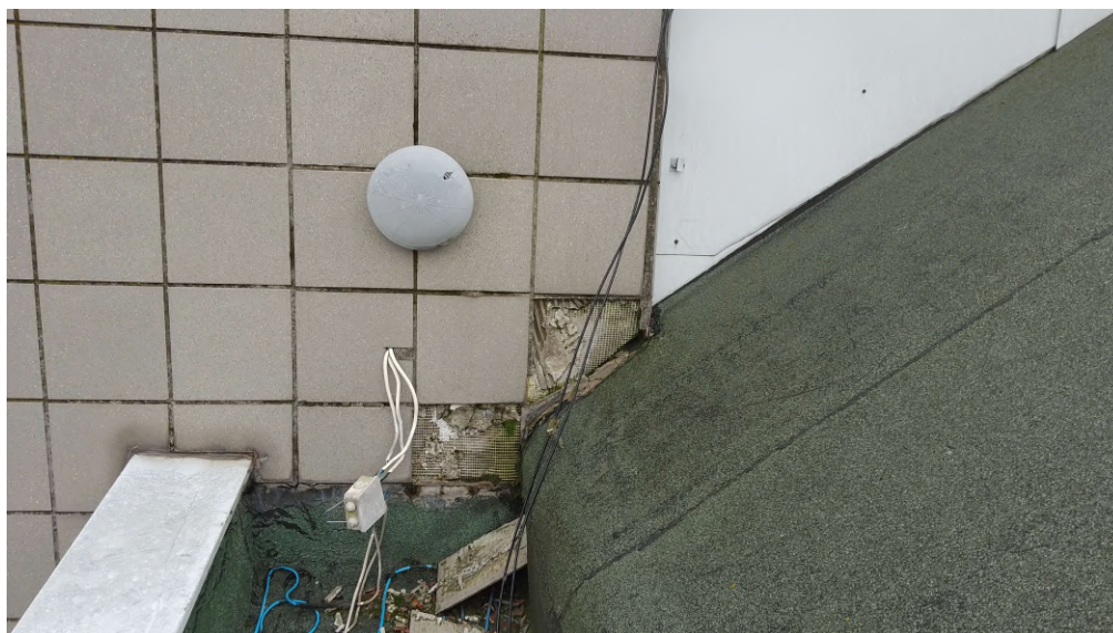
Zdjęcie nr 2. Zdewastowane naroże
