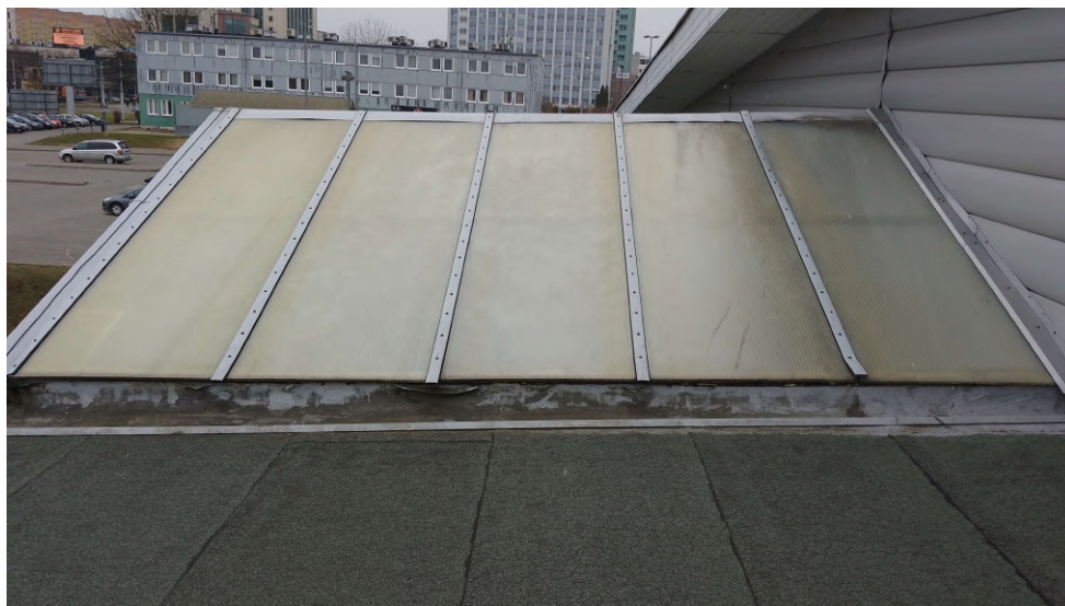
Zdjęcie nr 6. Stan świetlików i ich obróbek.
