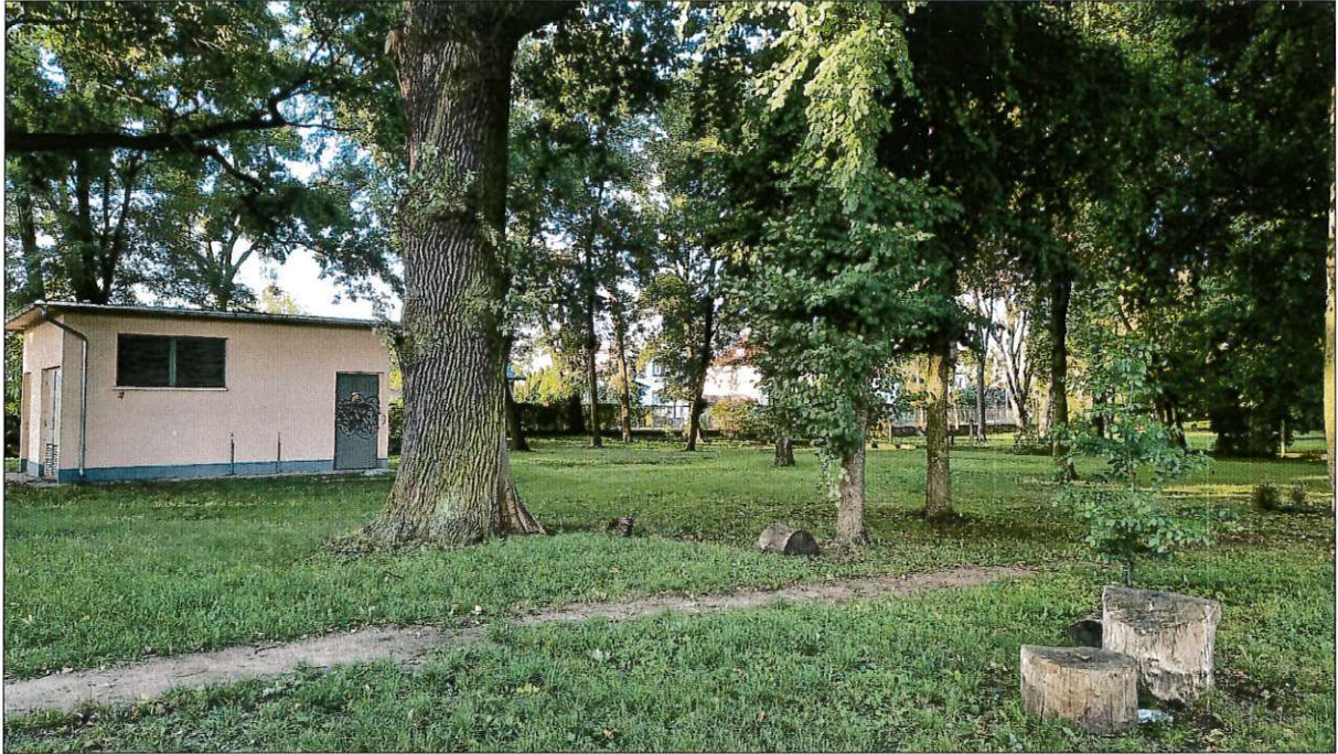
Stacja transformatorowa na terenie parku (fragment parku od strony SP nr 16)
