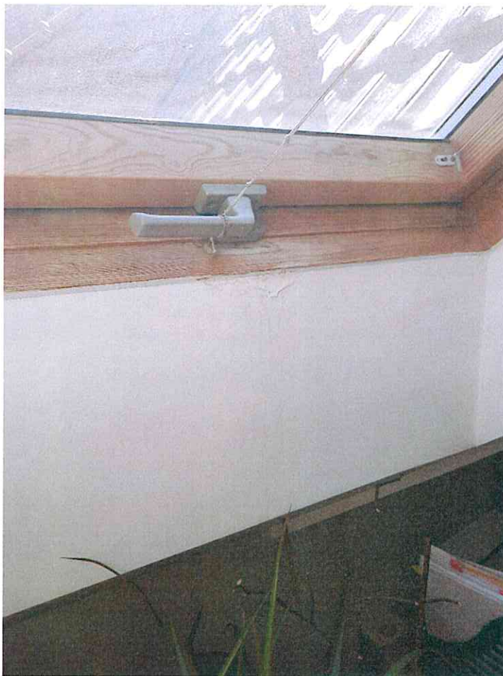
Zdjęcie nr 2. Widoczne zawilgocenia ścian pod oknami dachowymi.
