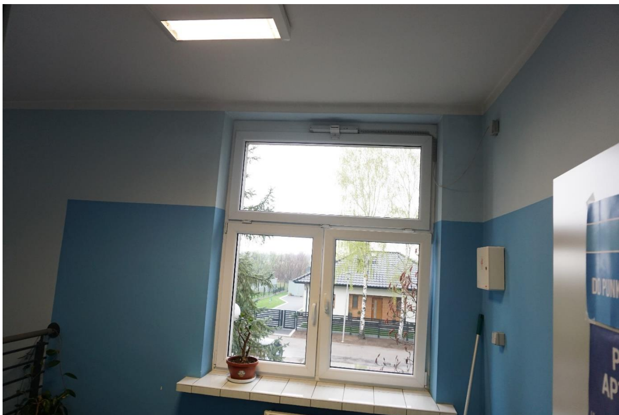
Zdjęcie nr 8 – System oddymiania wydzielonej pożarowo klatki schodowej
