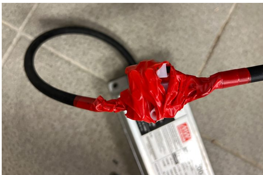
Rysunek 5 Niewłaściwe wykonanie izolacji połączeń
