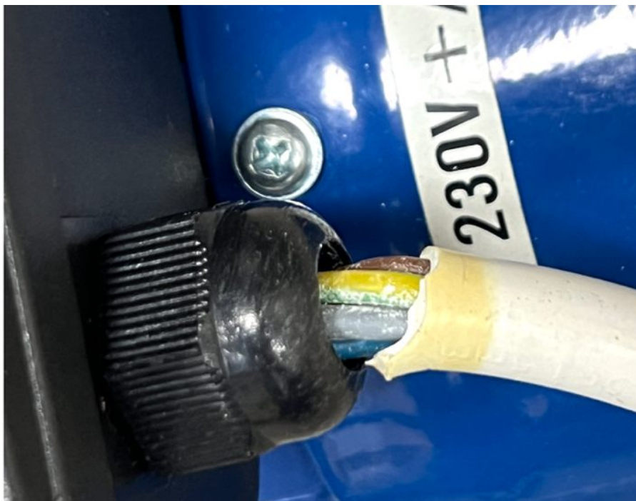
Rysunek 6 Uszkodzona izolacja i powłoka zewnętrzna okablowania zasilającego
