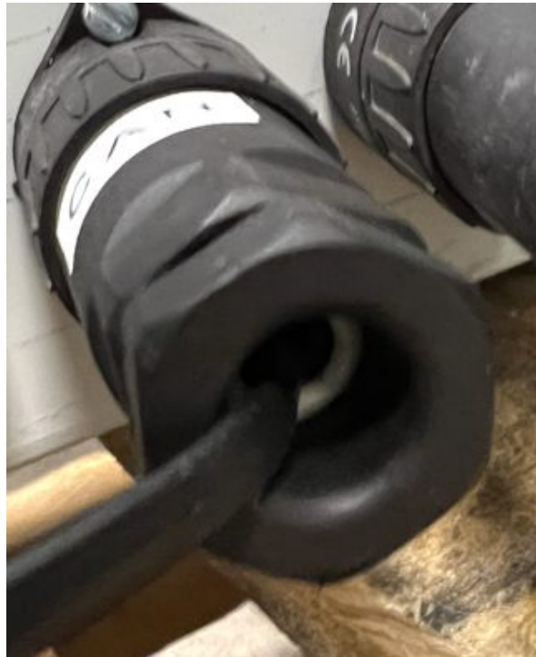
Rysunek 2 Dławnice kablowe są niewłaściwie dobrane do przekroju kabli
