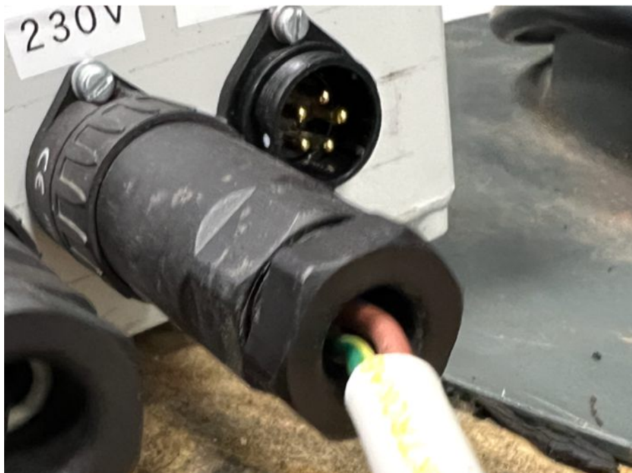
Rysunek 4 Uszkodzona izolacja i powłoka zewnętrzna okablowania zasilającego
