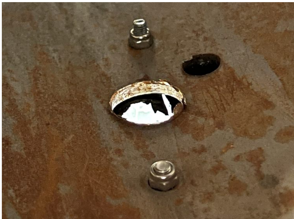
Rysunek 28 Rdza, źle zgratowane przepusty kablowe
