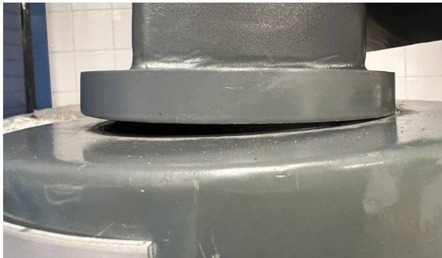
Rysunek 24 Uszkodzona mechanizm obrotowy
