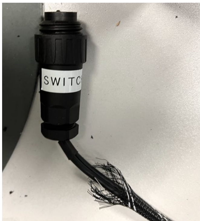
Rysunek 7 Uszkodzona okablowanie sterujące
