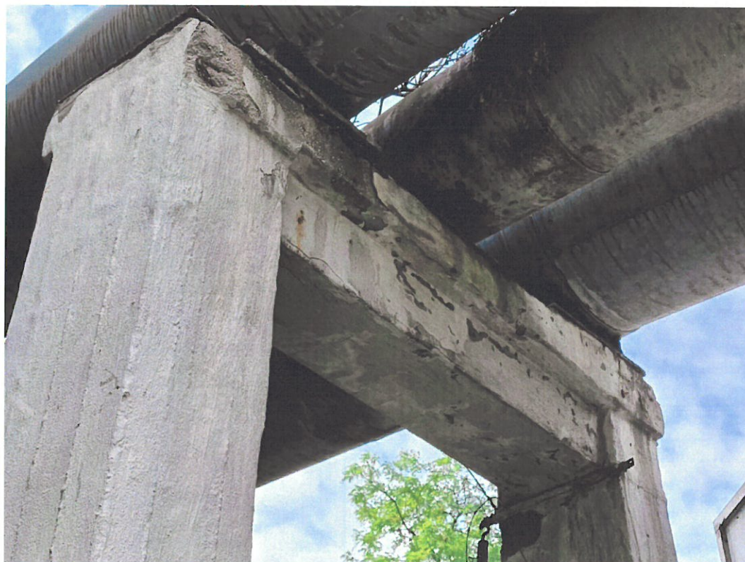
Fot. 50 Korozja betonu, zarysowania świadczące o korozji pęczniejącej zbrojenia, ubytki – podpora nr 9.
