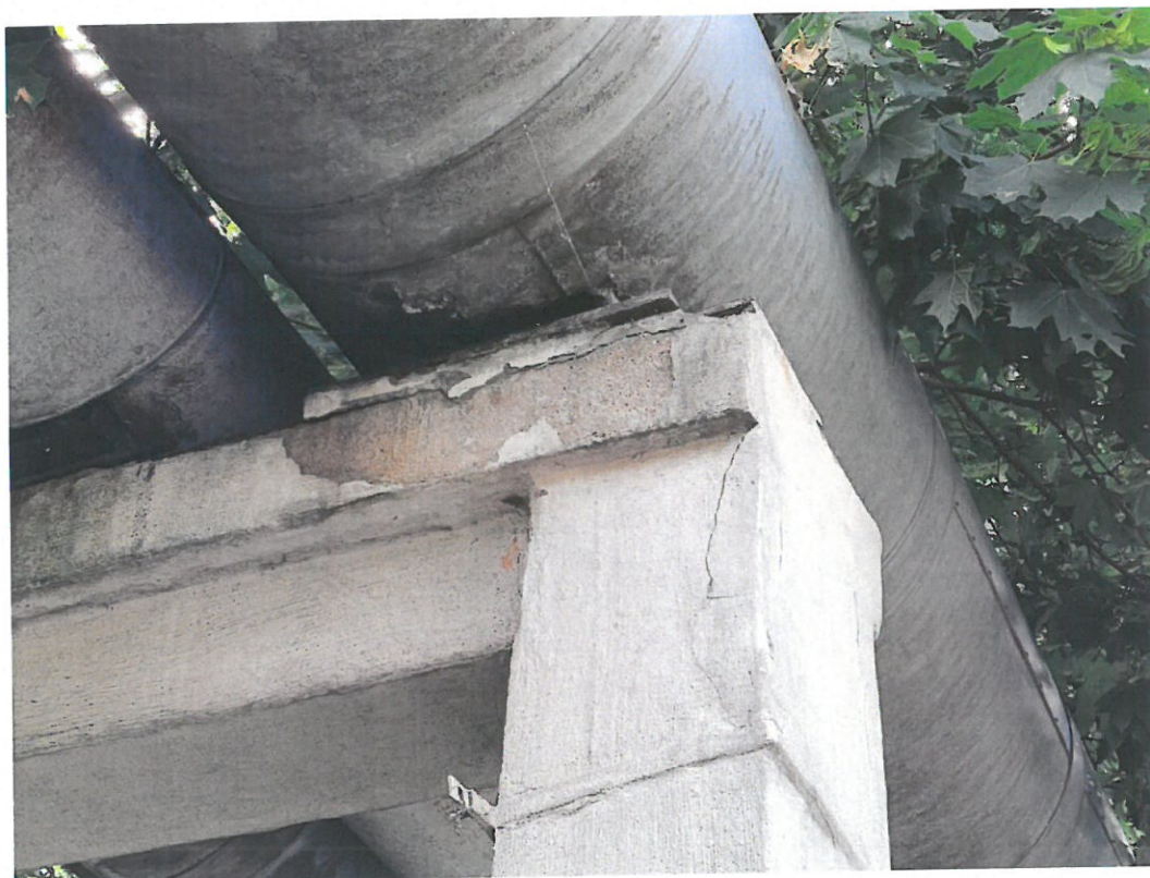
Fot. 52 Zarysowania, pęknięcia i ubytki w strefie podłożyskowej – podpora nr 10.
