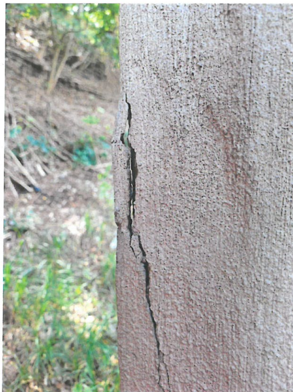
Fot. 55 Pęknięcie na słupie podpory świadczące o korozji pęczniającej zbrojenia – podpora nr 11
