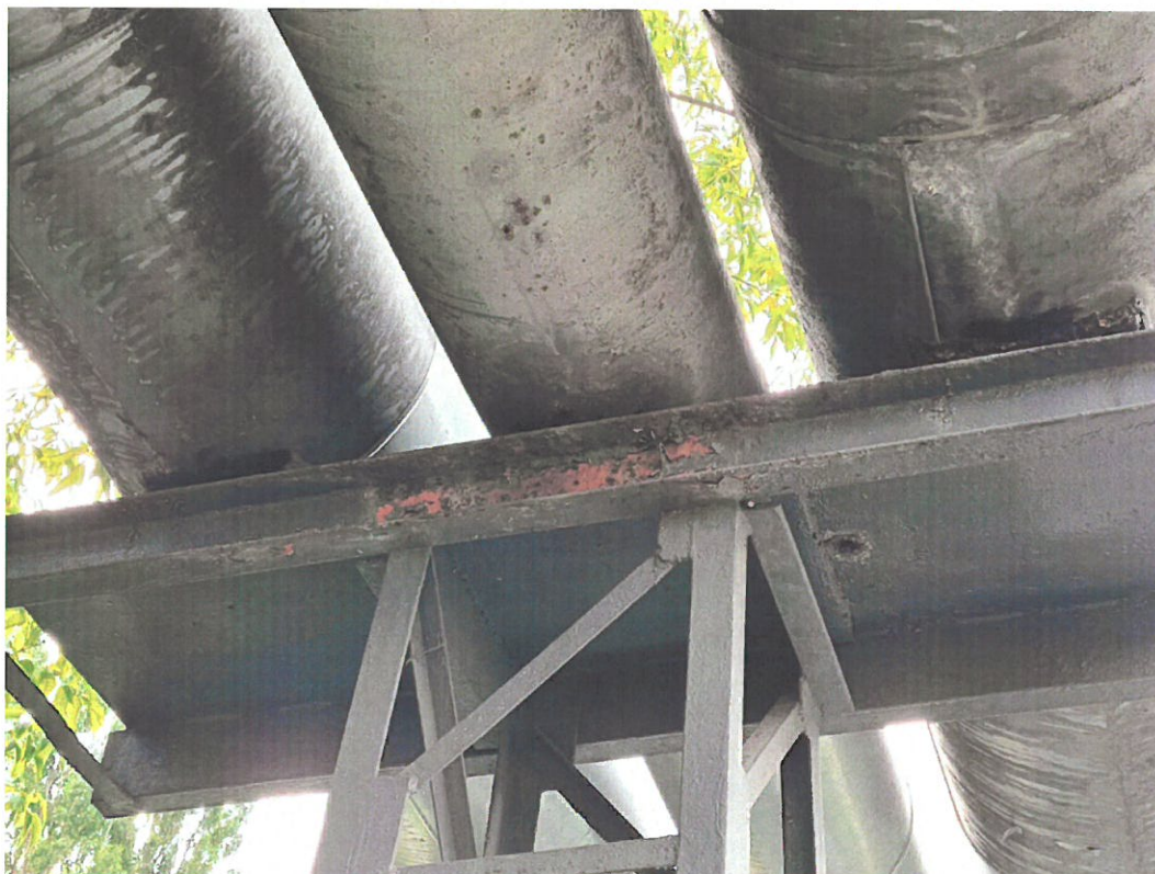
Fot. 46 Korozja konstrukcji stalowej, zniszczenie powłoki malarskiej – podpora nr 6.
