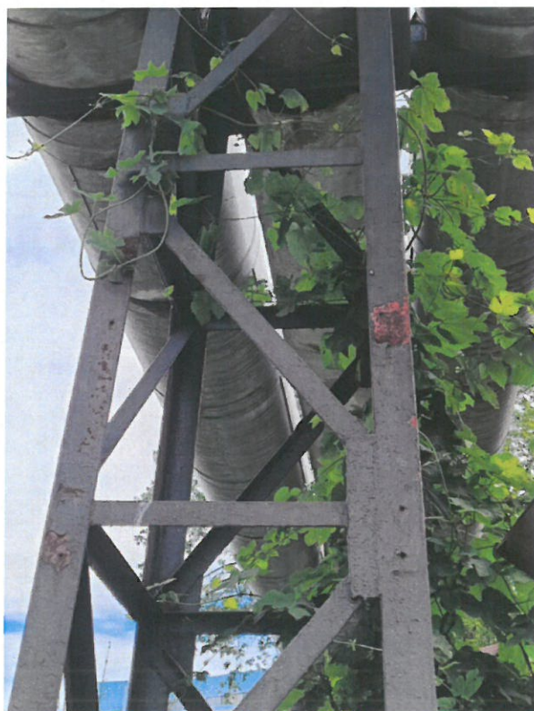
Fot. 48 Korozja stali, zniszczenie powłoki antykorozyjnej – podpora nr 8.
