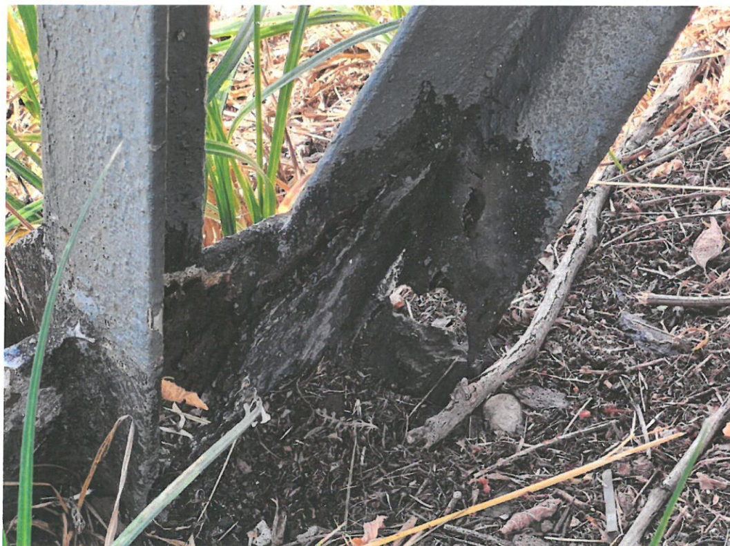
Fot. 36 Korozja konstrukcji stalowej - podpora nr 2.
