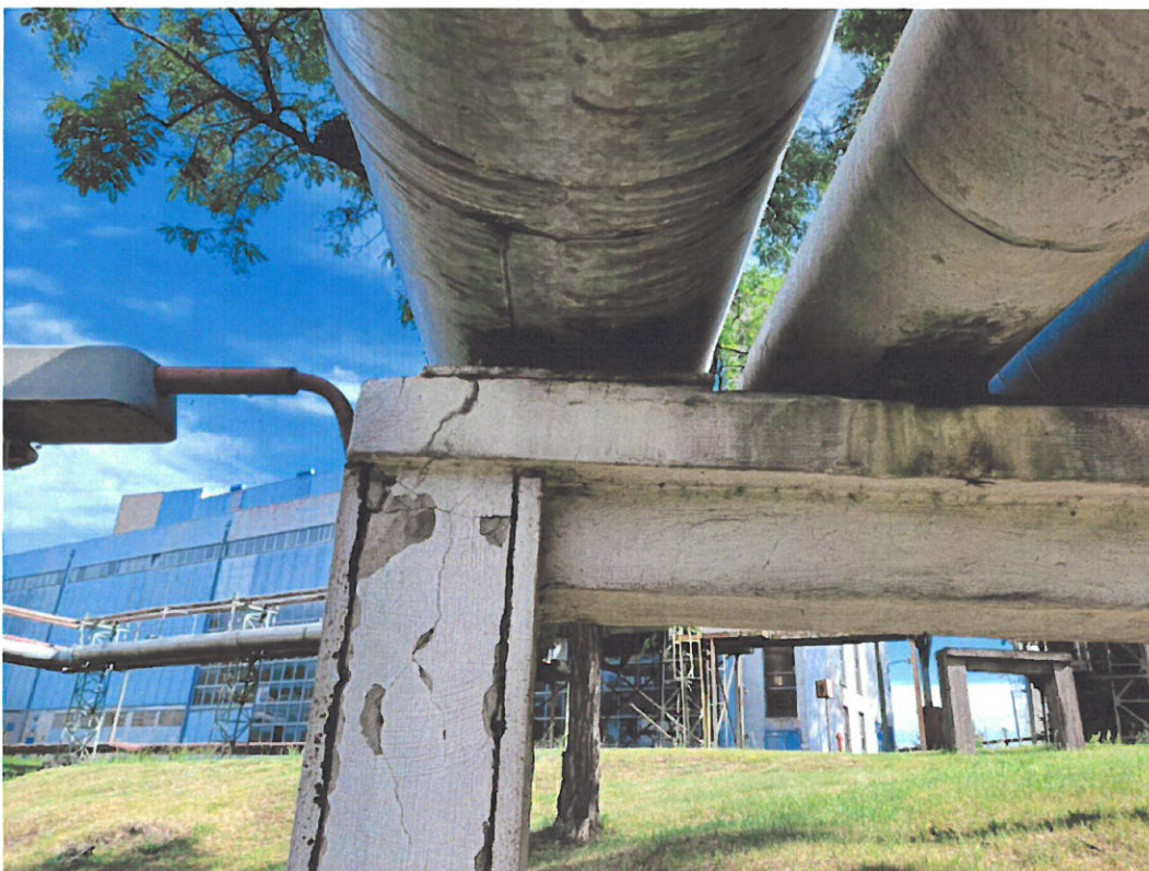
Fot. 38 Korozja betonu i zbrojenia, zarysowania, ubytki, - Podpora nr 3.
