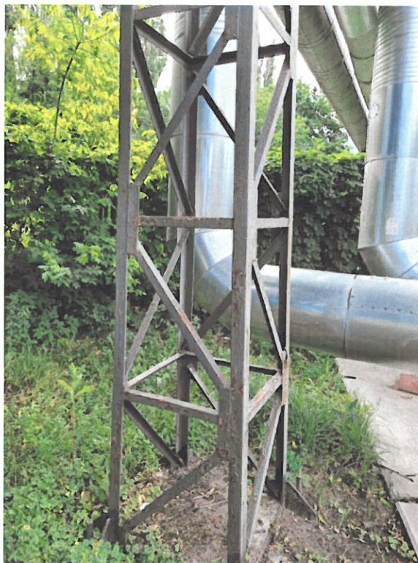
Fot. 45 Korozja konstrukcji stalowej, zniszczenie powłoki malarskiej – podpora nr 6.
