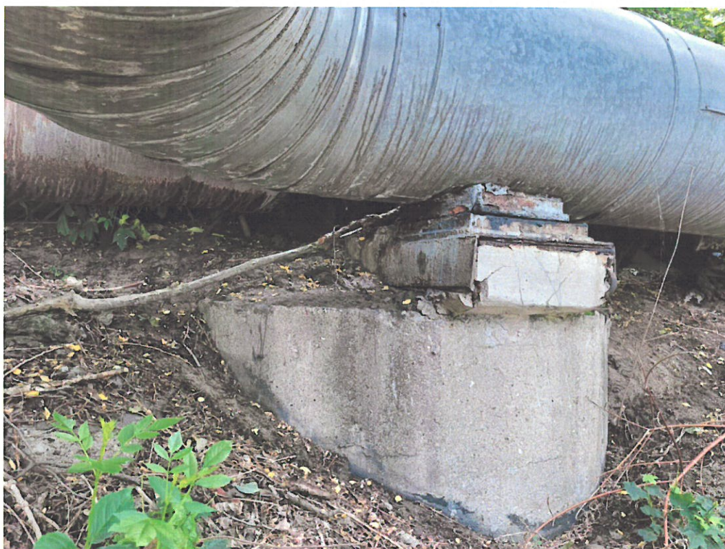
Fot. 58 Zarysowania, pęknięcia i ubytki na belce podłożyskowej. Korozja łożyska – podpora nr 13.
