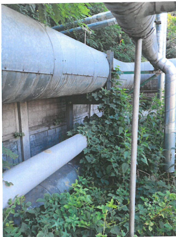
Fot. 67 Rozległa wegetacja roślin na konstrukcji i pobliskim terenie, uniemożliwiająca prawidłową ocenę konstrukcji – podpora nr 21.
