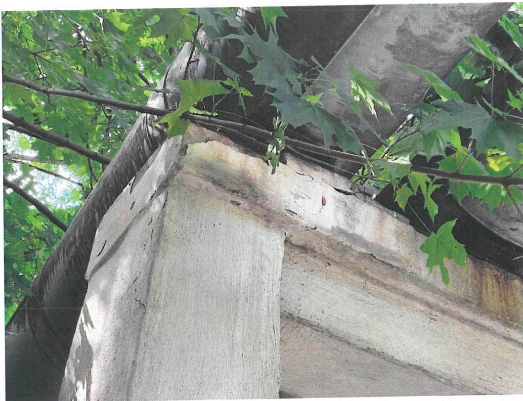
Fot. 51 Zarysowania, pęknięcia i ubytki w strefie podłożyskowej – podpora nr 10.
