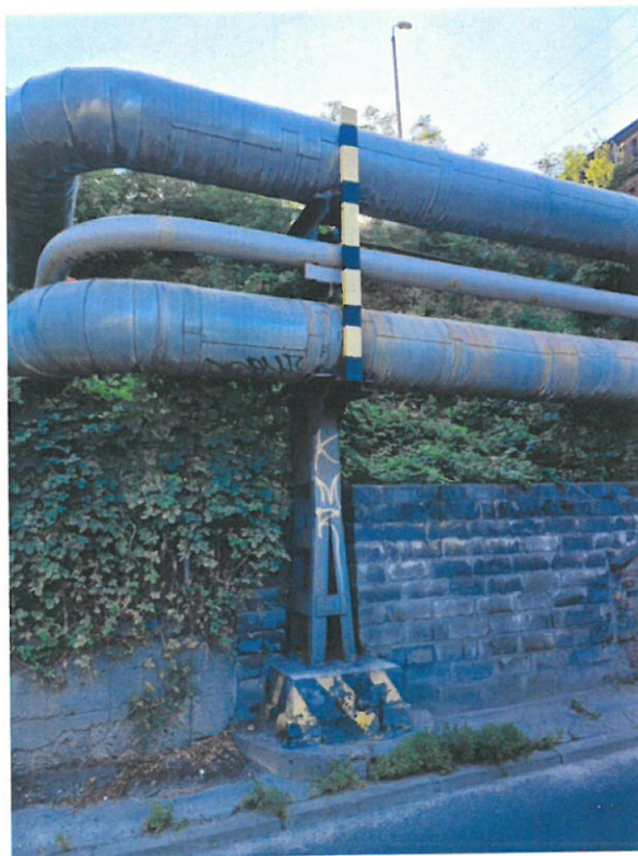
Fot. 68 Korozja powierzchniowa konstrukcji stalowej, łuszczenie się powłoki antykorozyjnej i zanieczyszczenie graffiti – podpora nr 22.
