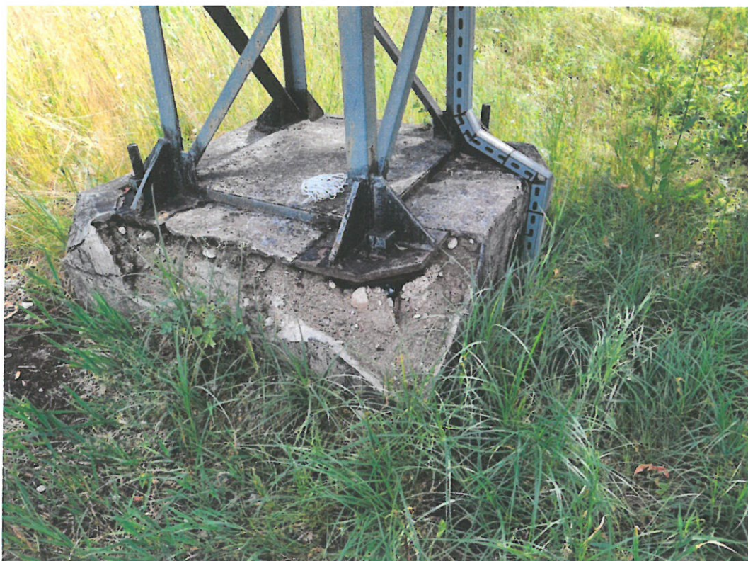
Fot. 44 Korozja betonu fundamentu, ubytki i zniszczenie struktury materiału – podpora nr 5.
