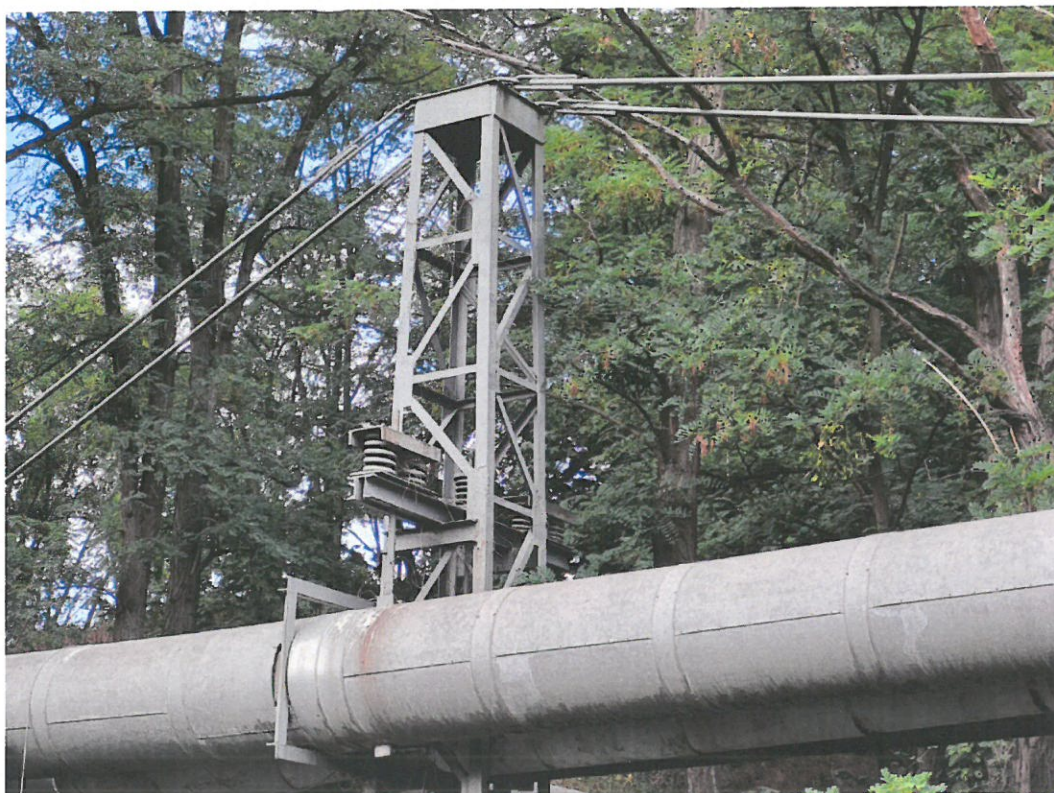
Fot. 60 Korozja konstrukcji stalowej, korozja sprężyn – podpora nr 15.
