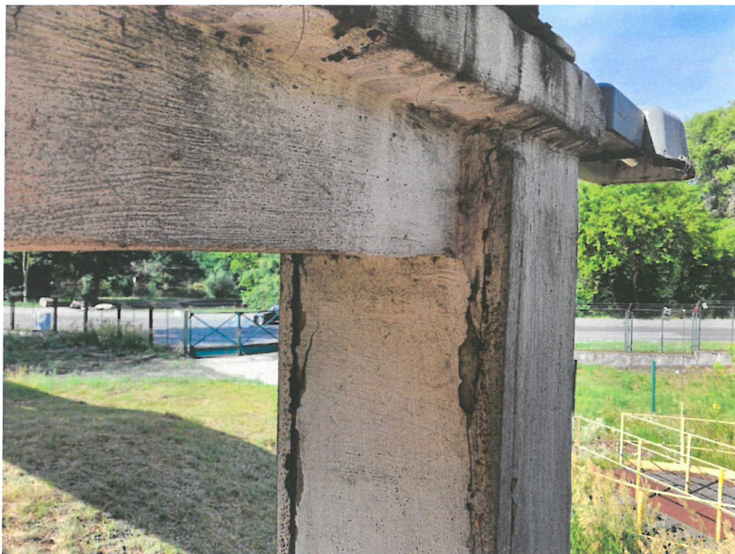
Fot. 39 Korozja betonu i zbrojenia, zarysowania, ubytki, - Podpora nr 3.
