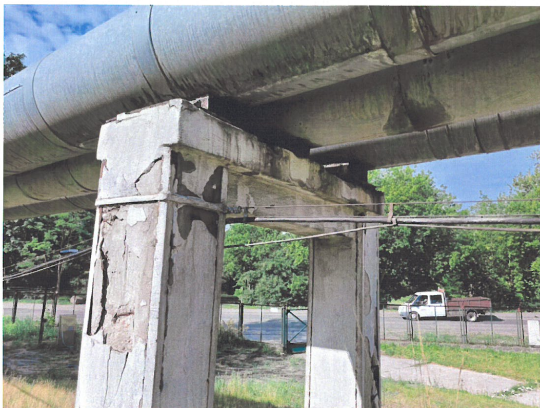
Fot. 42 Korozja betonu i zbrojenia, zarysowania, ubytki, - Podpora nr 4
