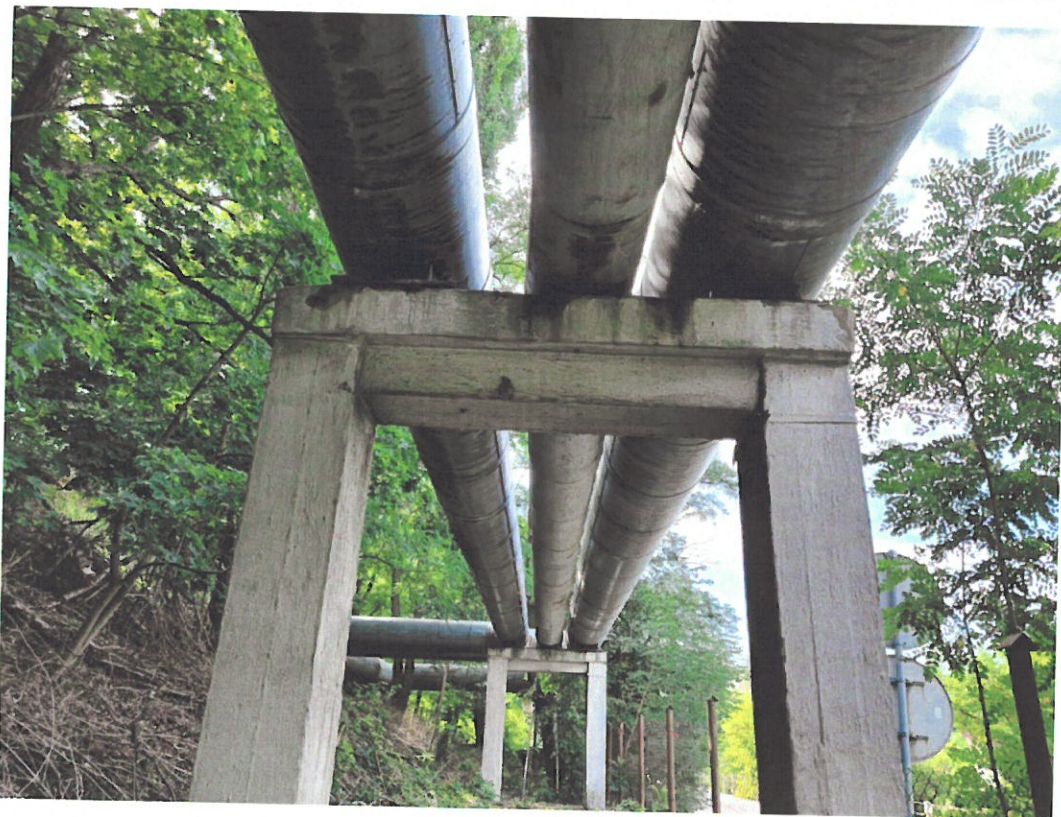
Fot. 54 Zarysowania, pęknięcia i ubytki w strefie podłożyskowej. Korozja łożysk stalowych – podpora nr 11.
