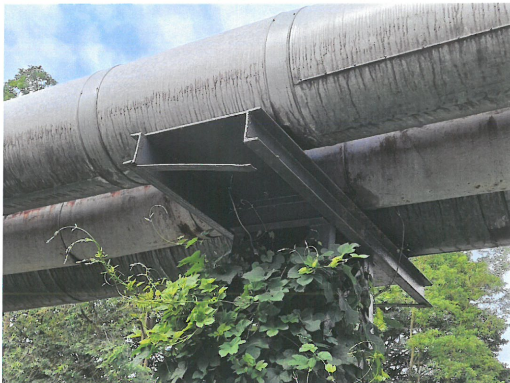
Fot. 47 Korozja stali, zerwanie stężenia głowicy. Wegetacja na podporze uniemożliwiająca dokładne określenie stanu konstrukcji podpory – podpora nr 7.
