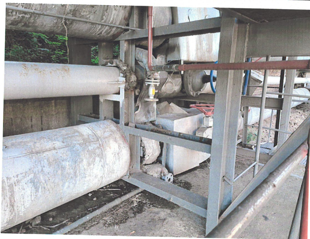
Fot. 66 Lokalna korozja i zniszczenie powłoki antykorozyjnej – Komora K-2.
