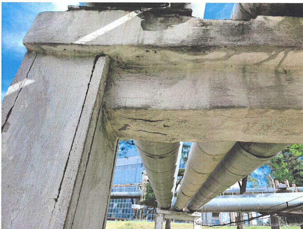
Fot. 41 Korozja betonu, rysy przeciążeniowe na ryglu, ubytki betonu w strefie podłożyskowej, - podpora nr 4.
