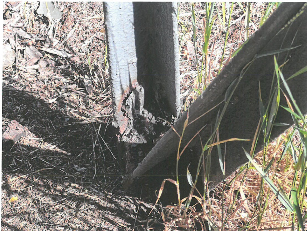
Fot. 35 Korozja konstrukcji - stalowej podpora nr 1.
