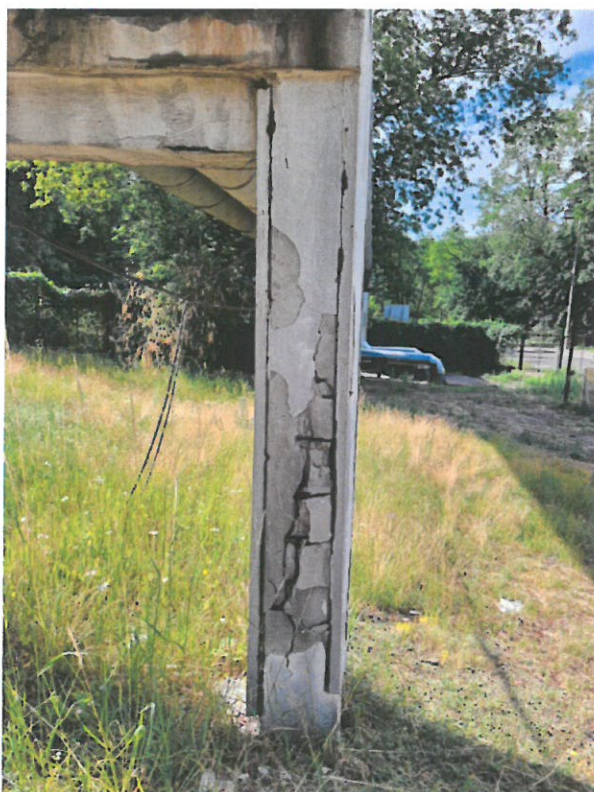
Fot. 40 Korozja betonu i zbrojenia, zarysowania, ubytki, - Podpora nr 4.
