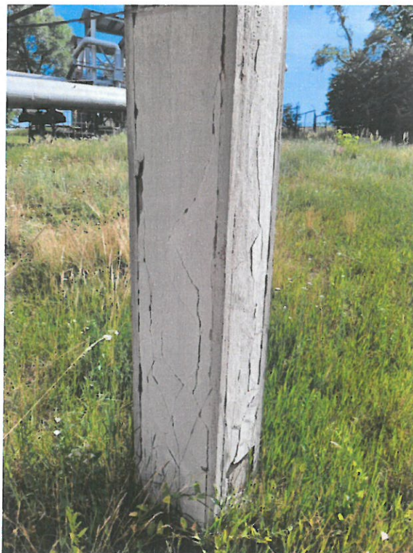
Fot. 43 Korozja betonu i zbrojenia, zarysowania, ubytki, - Podpora nr 4
