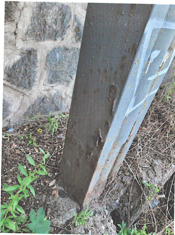
Fot. 70 Korozja konstrukcji stalowej słupa, łuszczenie się powłoki antykorozyjnej, zanieczyszczenie graffiti – podpora nr 25.
