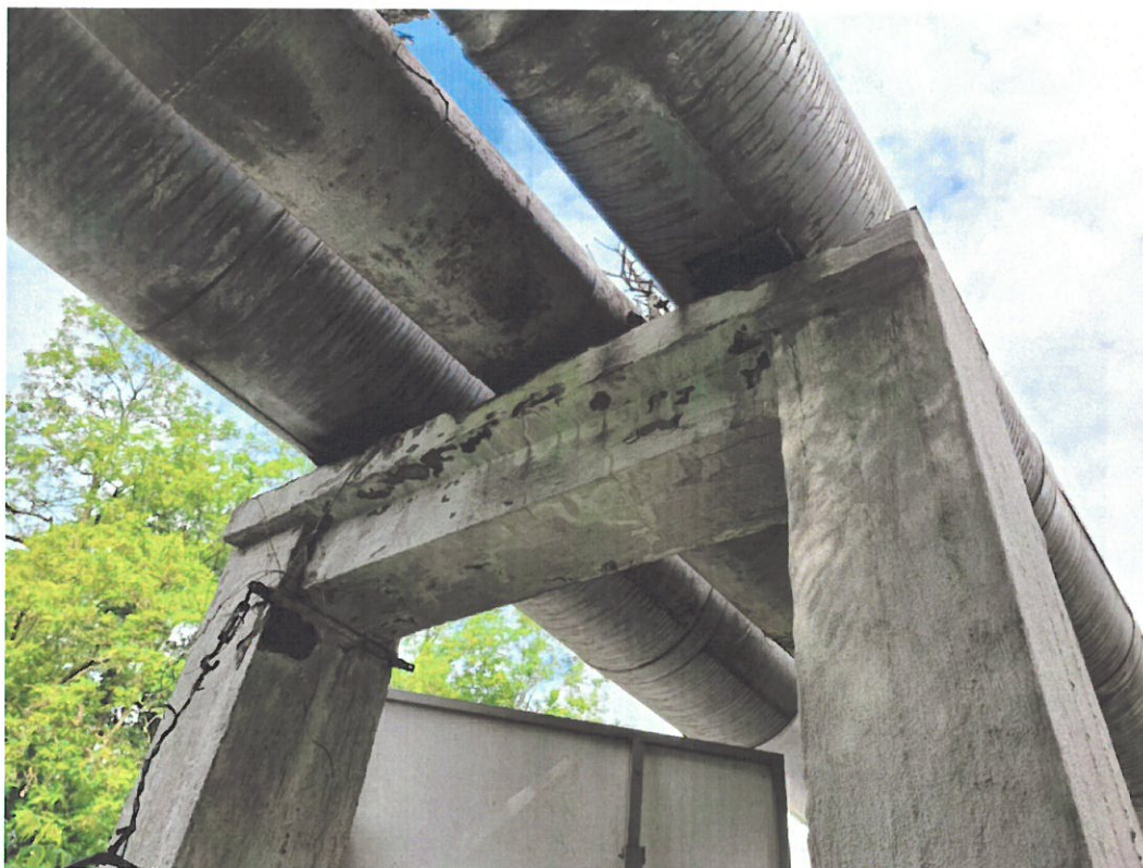
Fot. 49 Korozja betonu, zarysowania świadczące o korozji pęczniejącej zbrojenia – podpora nr 9.
