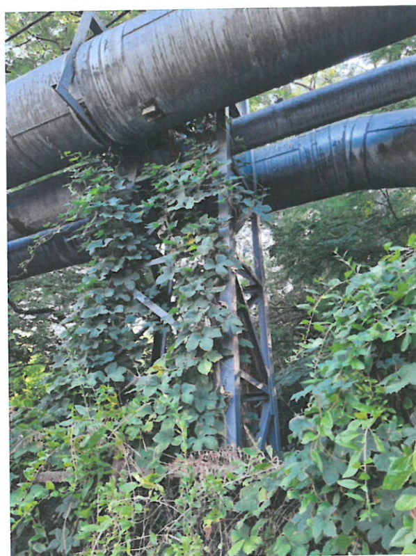
Fot. 64 Rozległa wegetacja roślin, uniemożliwiająca prawidłową ocenę konstrukcji – podpora nr 17.
