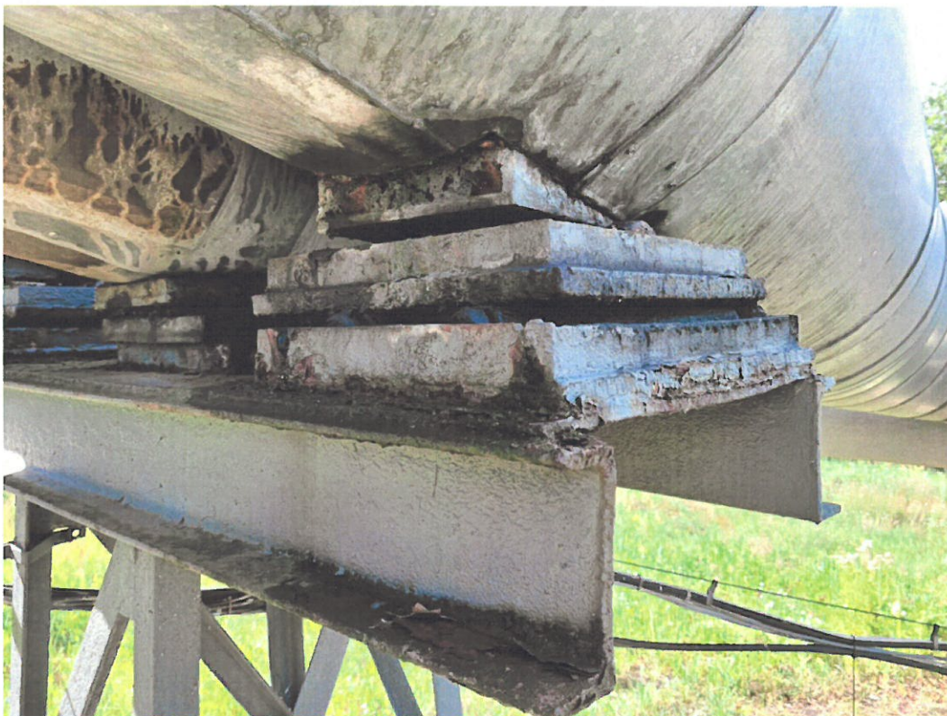
Fot. 37 Korozja konstrukcji stalowej i łożyska - podpora nr 1.
