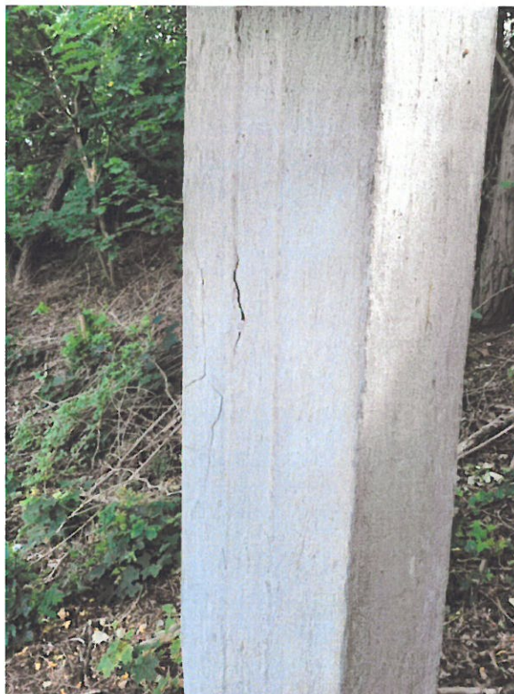
Fot. 57 Pęknięcia i zarysowania na słupie podpory świadczące o korozji pęczniejącej zbrojenia – podpora nr 12.
