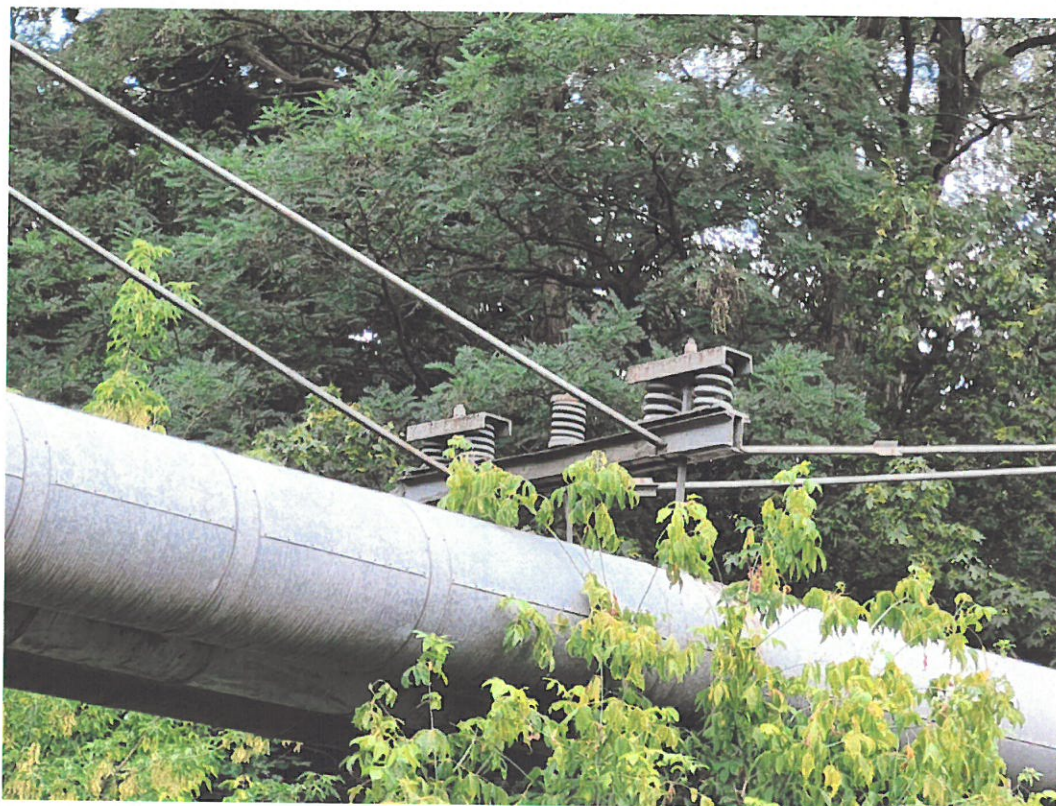
Fot. 62 Rozległa wegetacja roślin, Korozja konstrukcji stalowej, korozja sprężyn – przęsło 16-17.
