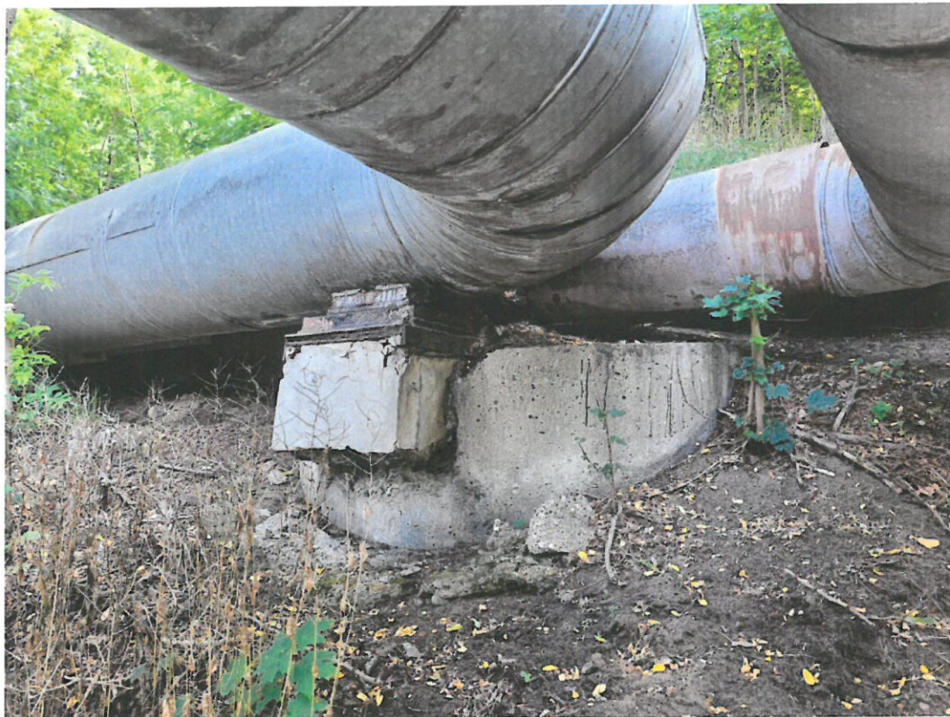
Fot. 59 Zarysowania, pęknięcia i ubytki na belce podłożyskowej. Korozja łożyska – podpora nr 14.
