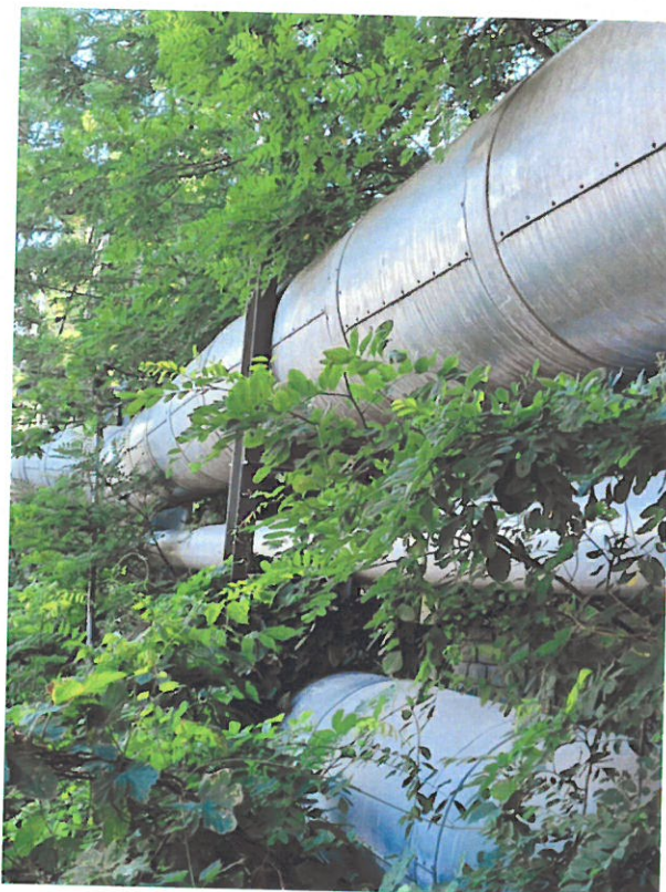
Fot. 65 Rozległa wegetacja roślin, uniemożliwiająca prawidłową ocenę konstrukcji – podpora nr 17.
