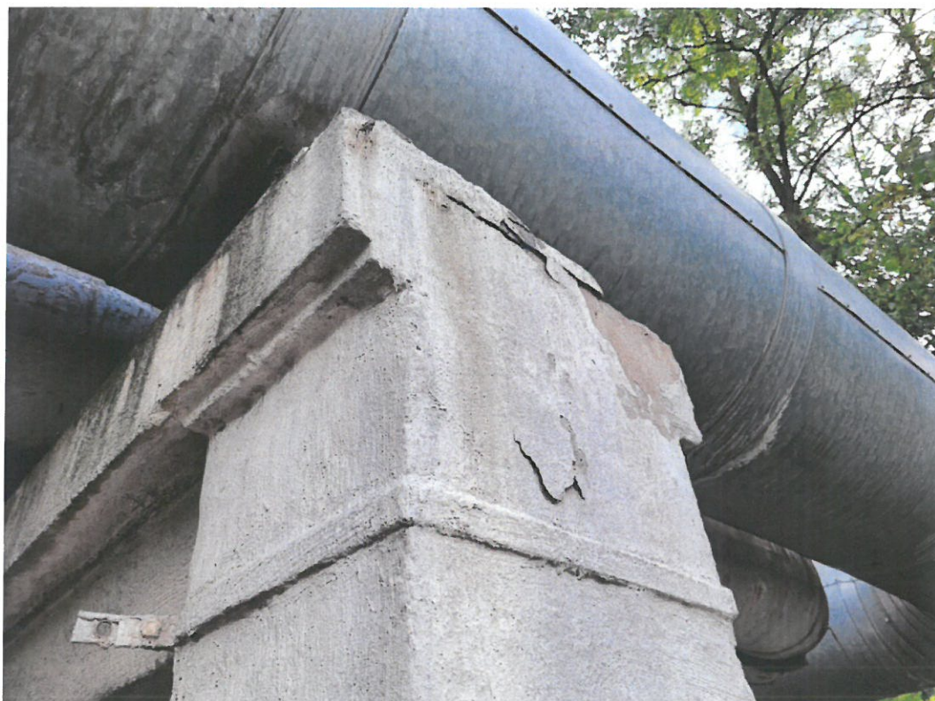
Fot. 56 Zarysowania, pęknięcia i ubytki w strefie podłożyskowej – podpora nr 12.
