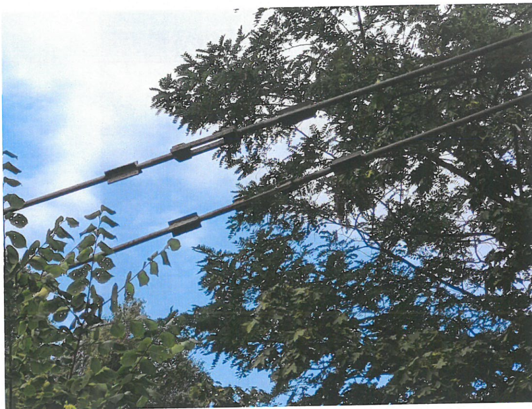
Fot. 63 Korozja ciągów – pręśło 16-17.
