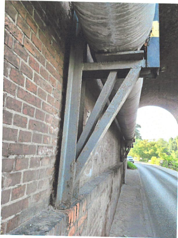
Fot. 69 Korozja powierzchniowa konstrukcji stalowej, łuszczenie się powłoki antykorozyjnej i zanieczyszczenie graffiti – podpora nr 22, podobnie na 23 i 24.
