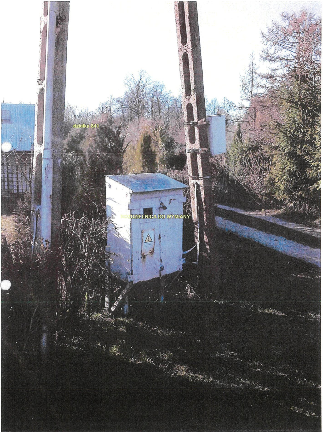
ROZDZIELNICA RG-3 przy działce 841
