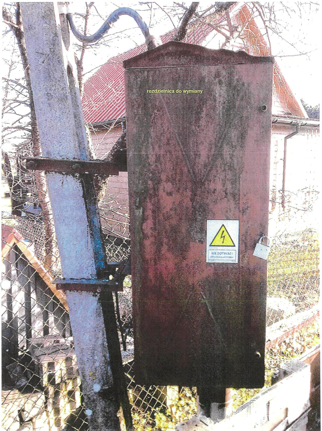
ROZDZIELNICA RG-2 przy działce 1100
