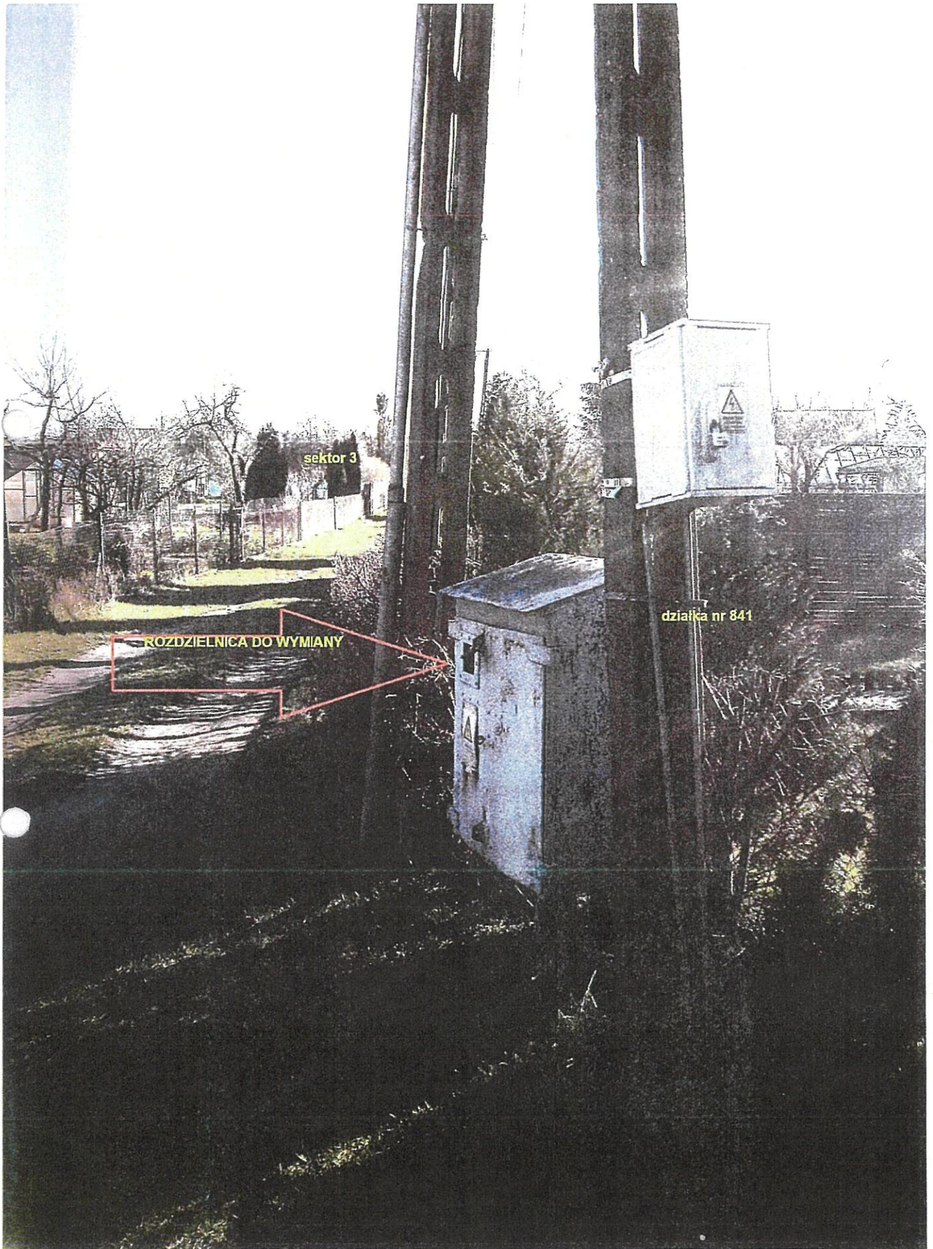
ROZDZIELNICA RG-3 przy działce 841
