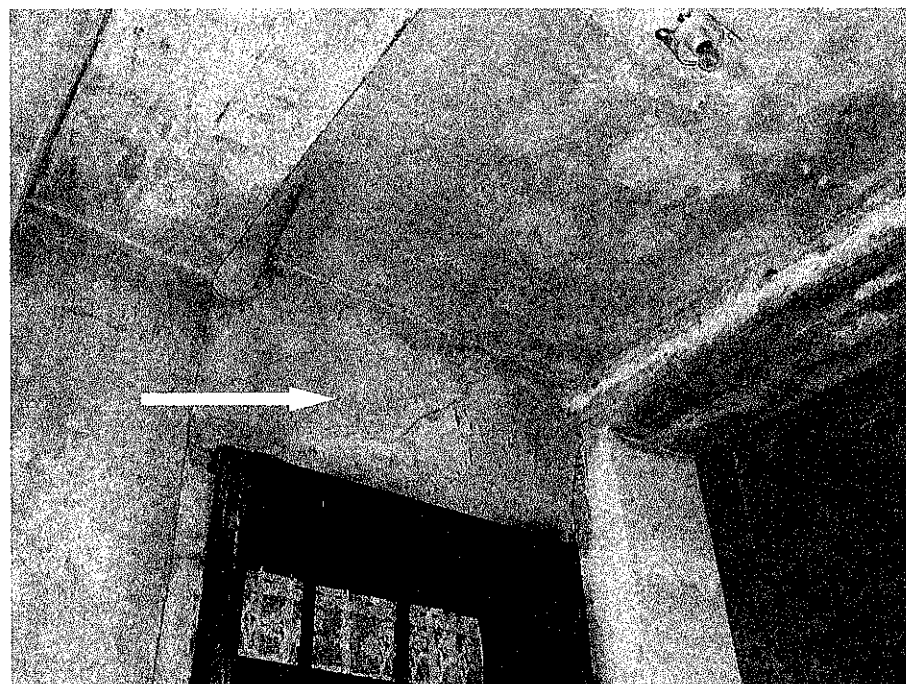
Fot.8 Filar F5 i F6 oraz nadproże N2 - spękania nadproża N2.
