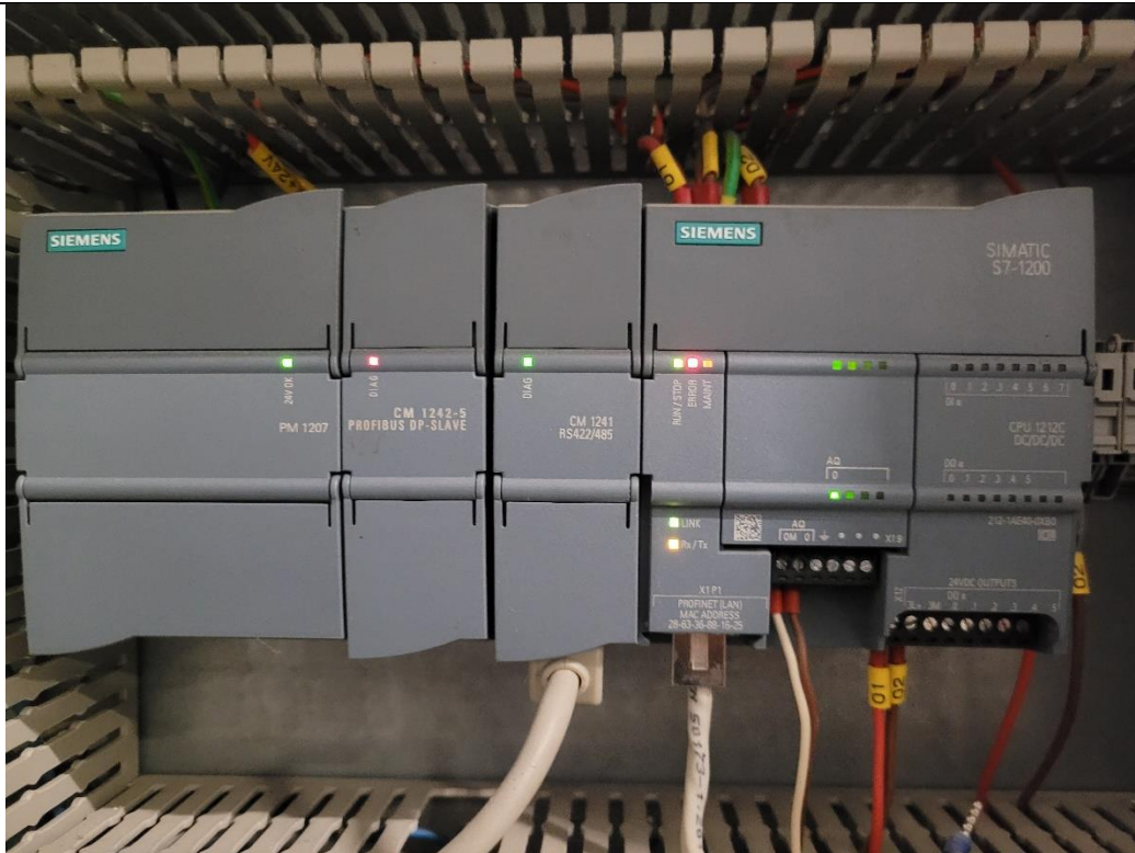
Szafa S7 – komunikacja z jednostką kogeneracyjną JK.3 (profinet) (poza szafą)
