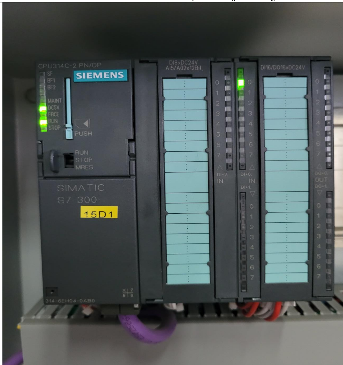
Szafa S2 – Sterownik dmuchaw powietrza (poza szafą)
