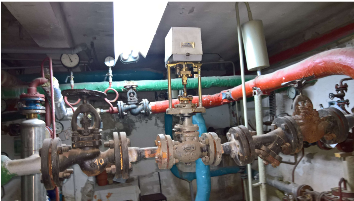
Zdjęcie 6 – Widok armatury, rurociągów
