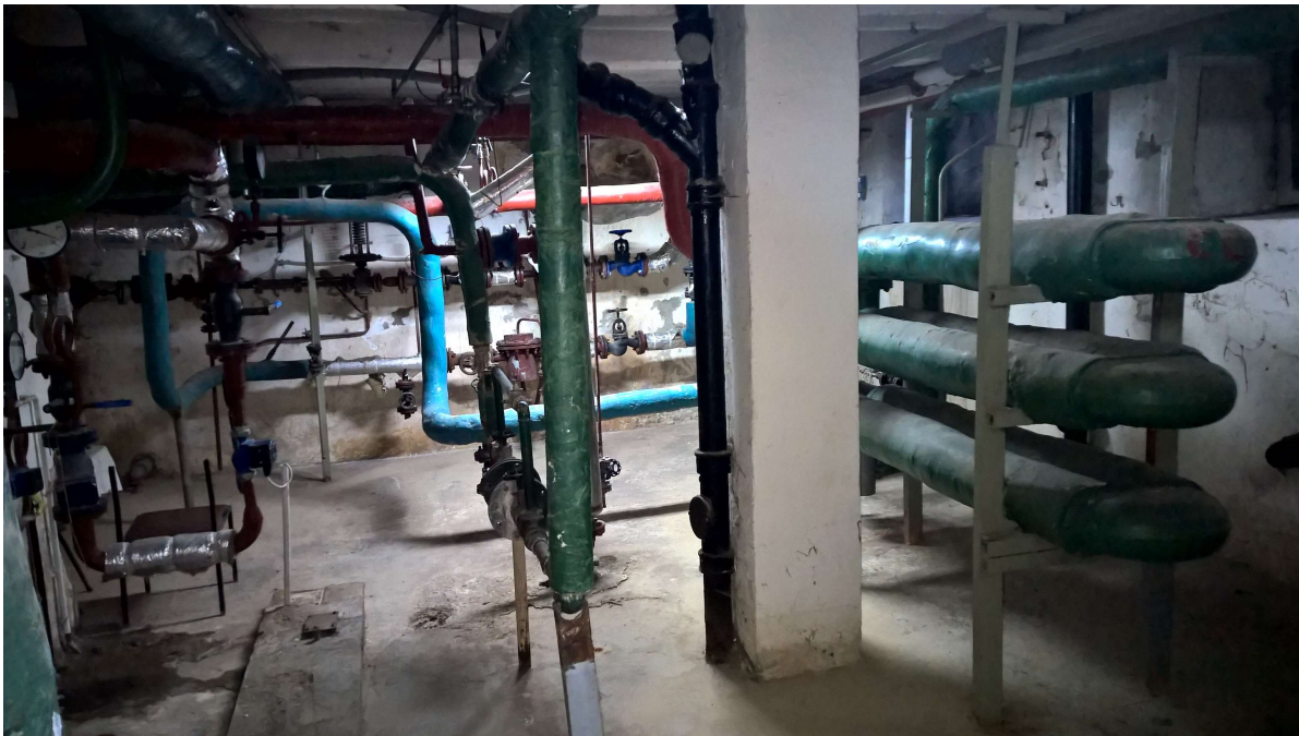
Zdjęcie 5 – Widok rurociągów wraz z armaturą. Po prawej stronie wymiennik c.o.
