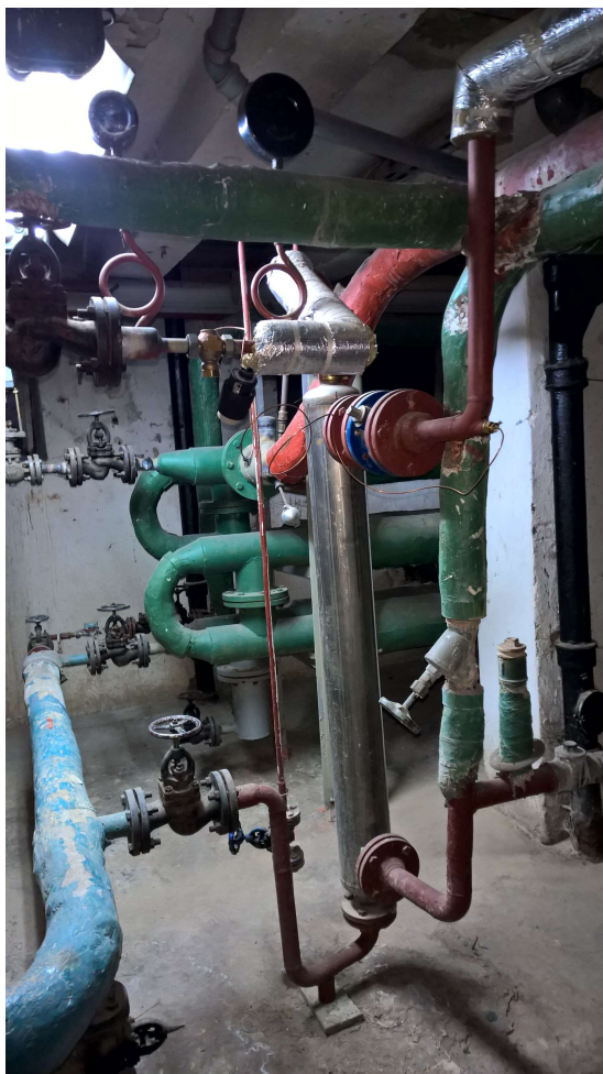
Zdjęcie 2 – Wymiennik ciepłej wody typu JAD
