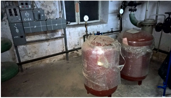
Zdjęcie 7 – Widok naczyń wzbiorczych oraz rozdzielnica
