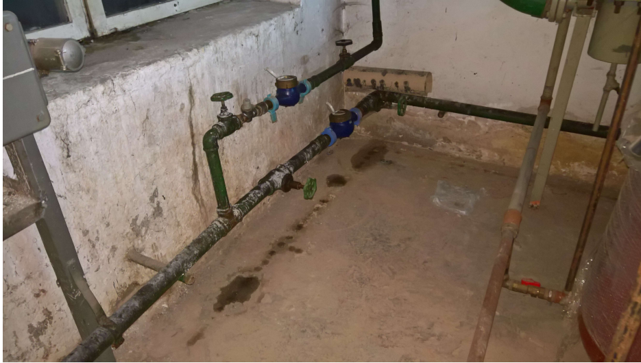
Zdjęcie 4 – Widok wodomierzy głównych zimnej wody. Górny wodomierz zamontowany na instalacji zimnej wody zasilającej część budynku totalizatora. Dolny wodomierz zamontowany na rurociągu instalacji Pawilonu Sportowego Lublinianka.
