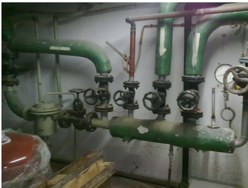
Zdjęcie 1 – Rozdzielacz powrotny c.o. wraz z armaturą odcinającą i odmulnikiem
