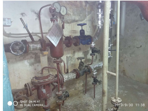
Zdjęcie 8 – Widok przyłącza ciepłego oraz armatury wysokie parametry
