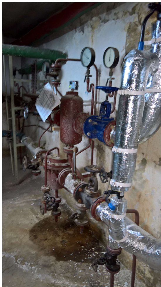
Zdjęcie 3 – Przyłącze ciepłe (nowe). Osprzęt.
