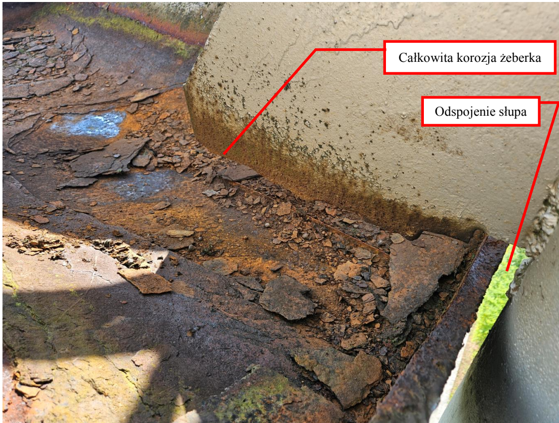
Fot. 12 Korozja stężenia słupów, nastąpiło odspojenie słupa
