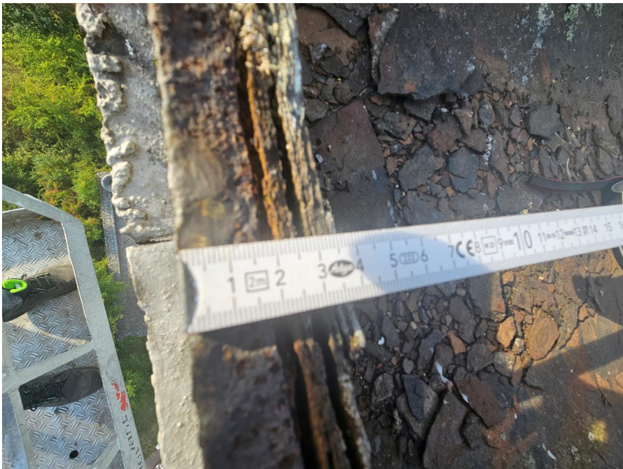
Fot. 13 Korozja żebra uszywniającego „kłos”, rozwarstwienie blachy jako produkt korozyjny
