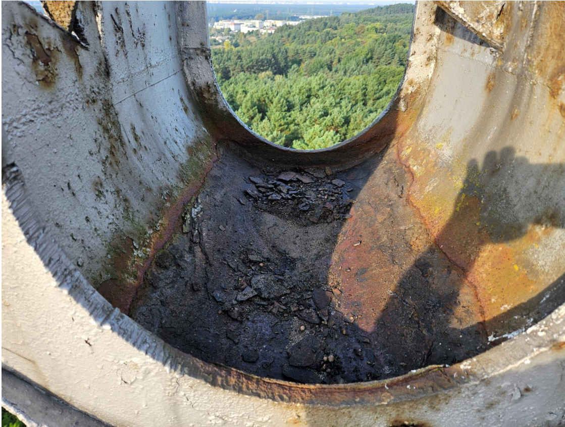
Fot. 10 Korozja blachy dolnej (łóża „kłosa”, elementu mocującego ‘kłos’ do słupa.
