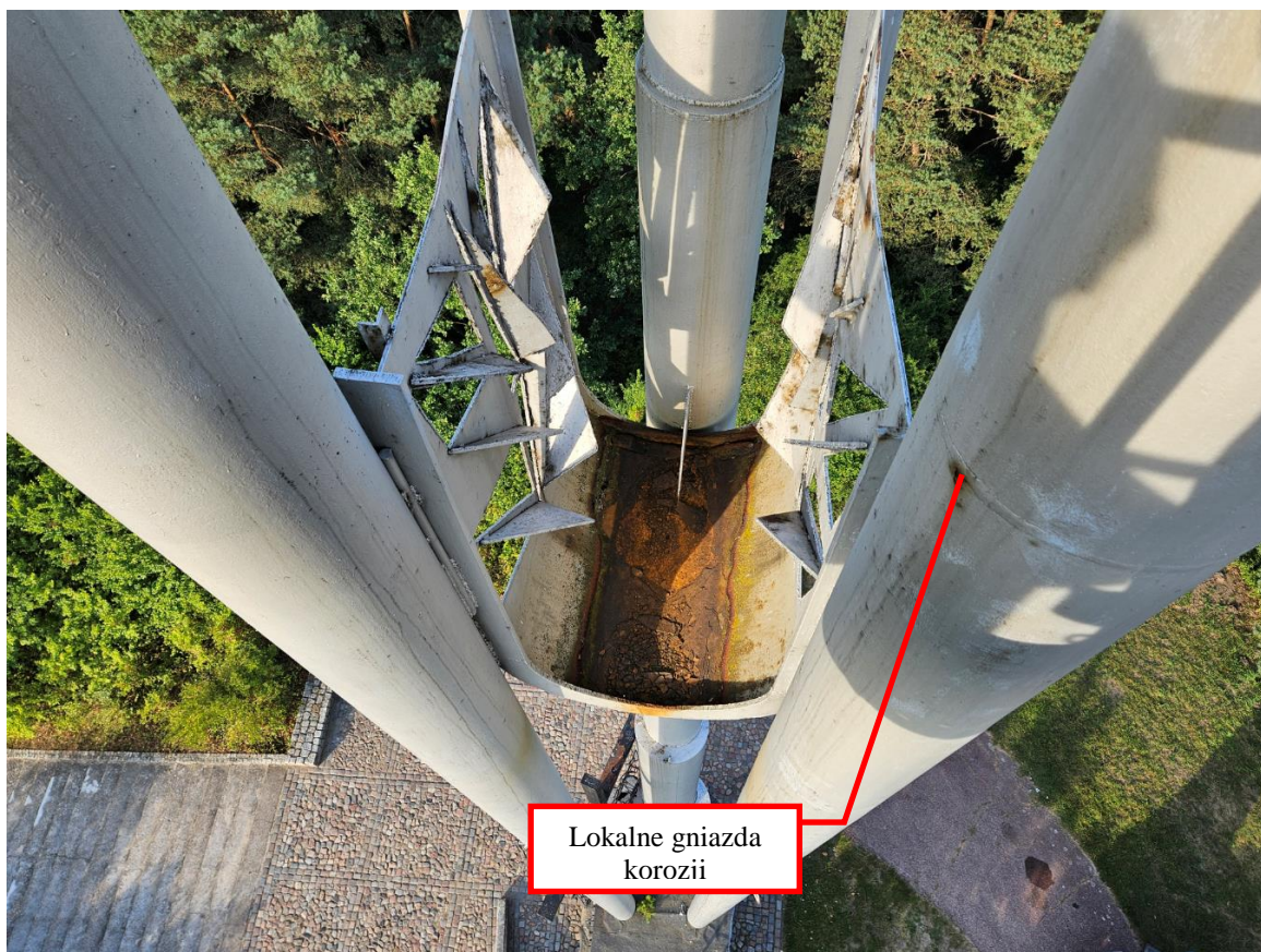
Fot. 7 Lokalne ślady korozji w okolicach spoin
