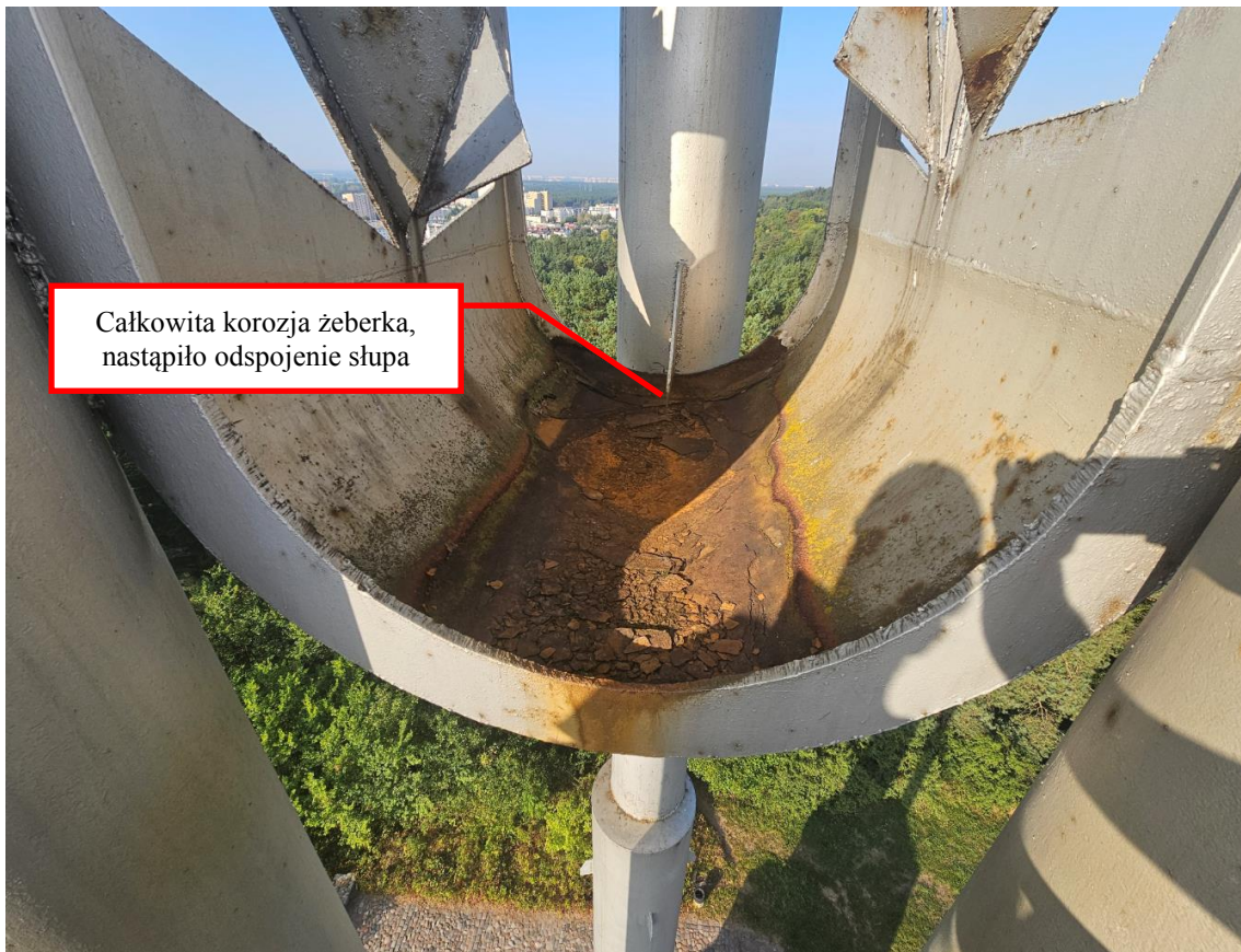
Fot. 11 Korozja wżerowa stężenia słupów
