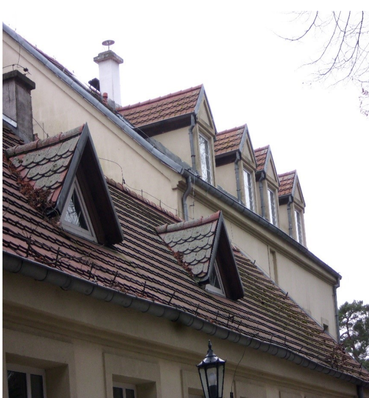
Zdeformowana i nieuszczelna rynna zacieka na elewacji.
