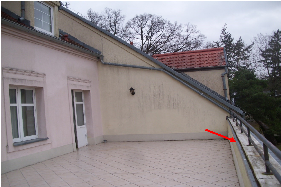
Zróznicowana kolorystyka ścian – za mały kapinos na murkach tarasu-zardzewiałe balustrady.
