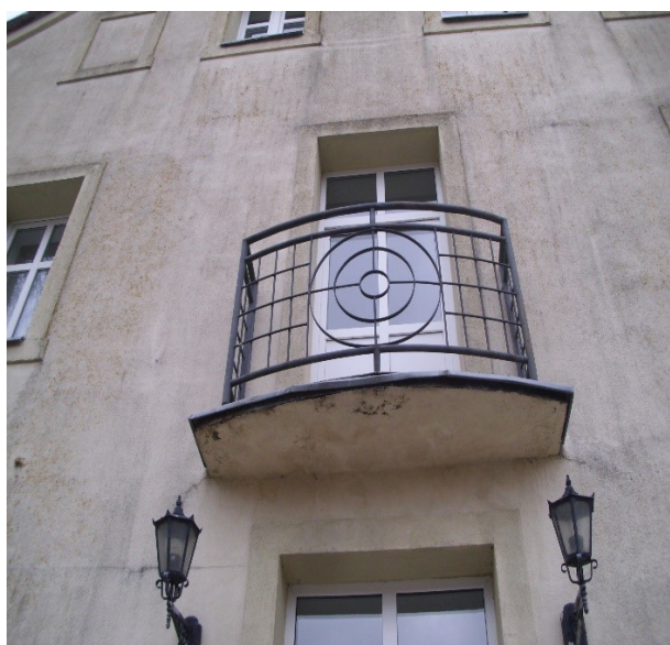
Zdeformowane opierzenie balkony Luźny i zawilgocony tynk strukturalny
