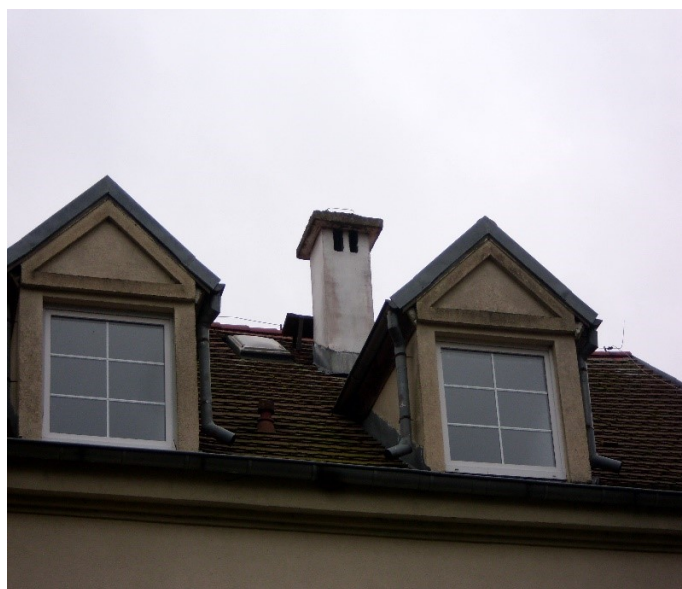
Oznaki korozji na rurach spustowych i obejmach facjat i połaci. Brak kratki w otworach wentylacji komina.
