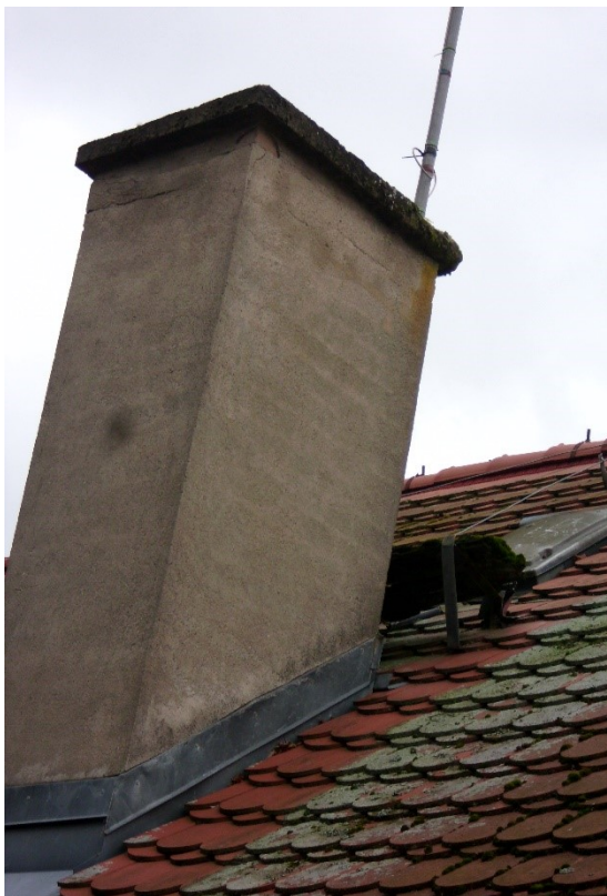
Spróchniałe deski na ławach kominiarskich Dachówka porośnięta mchem zabrudzona.
