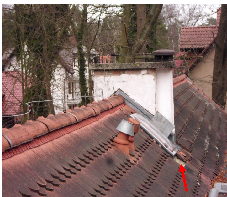
Ubytki tynku na kominach-brak dachówek pod oknem
