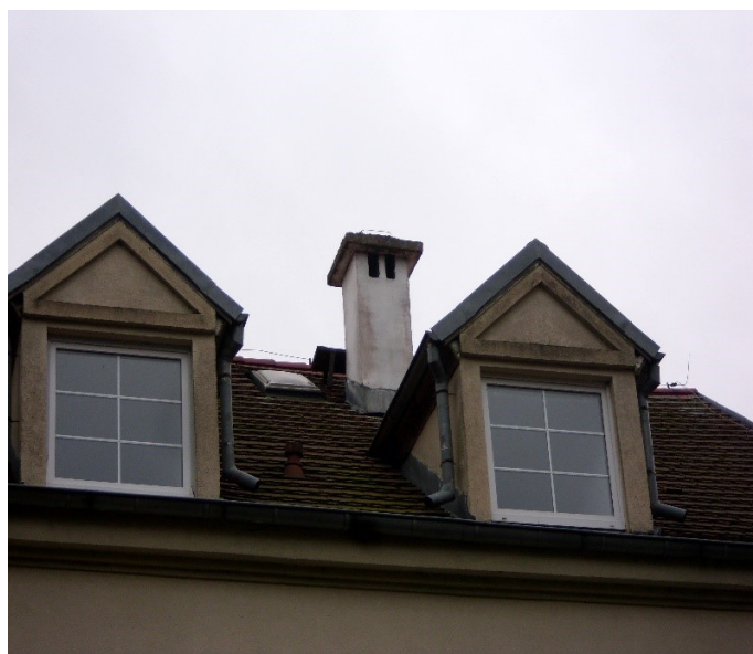
Oznaki korozji na rurach spustowych i obejmach facjat i połączi. Brak kratki w otworach wentylacji komina.
