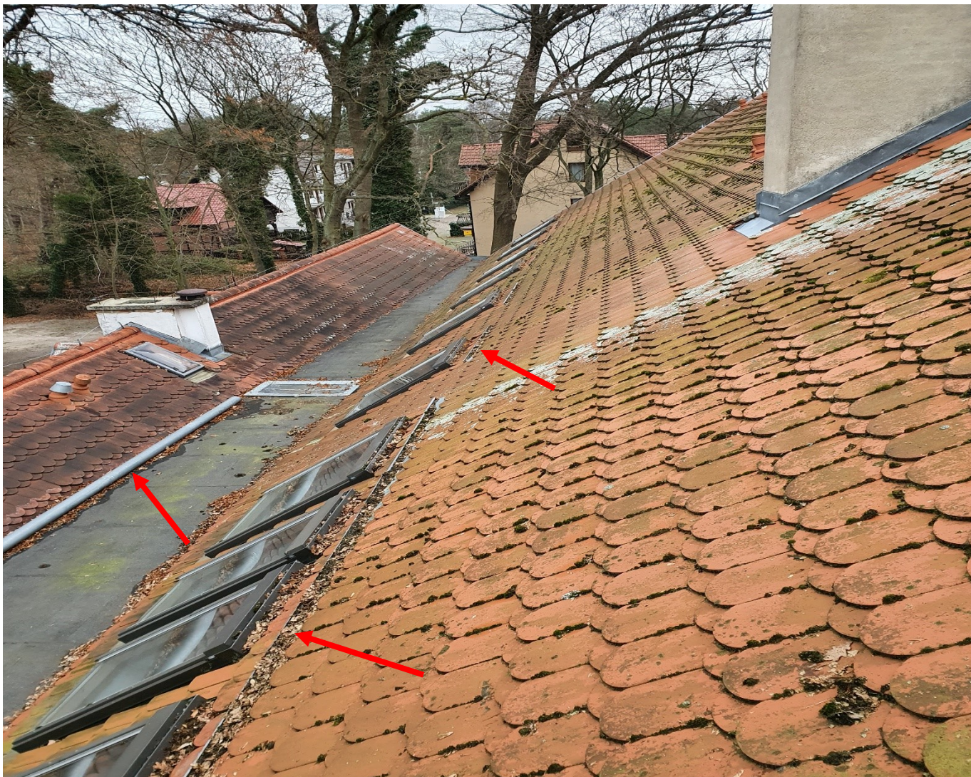
Wadliwie zamontowana obróbka blacharska nad oknami Odprowadzenie deszczówki z wysokiego z dachu do kosza. Korozyja papy w miejscu przylegania rury spustowej do dachu.
