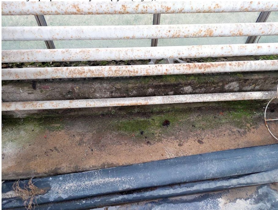
Zdjęcie 8 Stan istniejącej podmurówki
