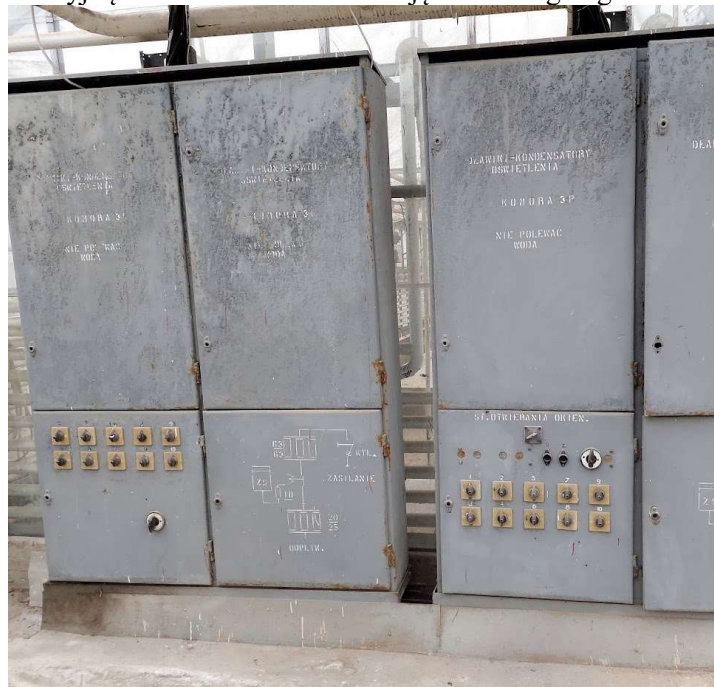
Zdjęcie 7 Rozdzielnie elektryczne, sterujące
