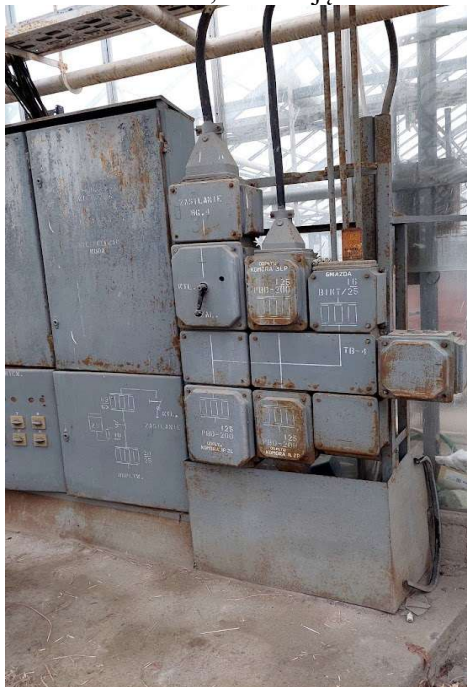
Zdjęcie 6 Złącze kablowe istniejące
