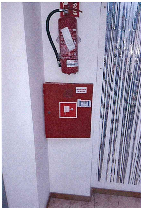
Zdjęcie nr 11- hydrant I piętro
