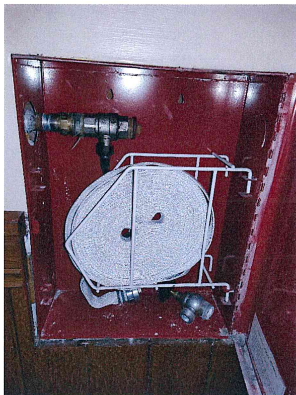
Zdjęcie nr 10 - hydrant parter
