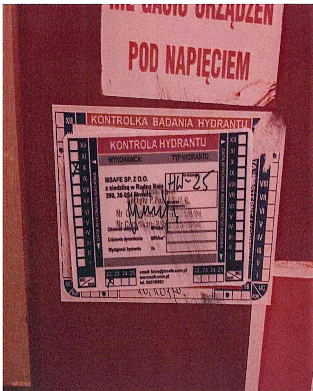
Zdjęcie nr 9 - hydrant parter
