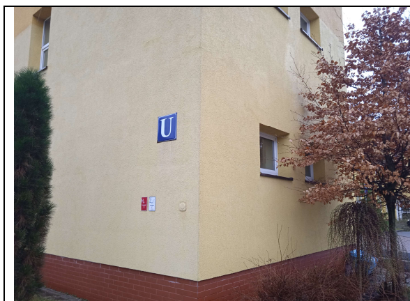
Widok na istniejące elementy instalacji odgromowej z poziomu gruntu budynku „U” – lokalizacja i oznaczenie puszek odgromowych p/t
