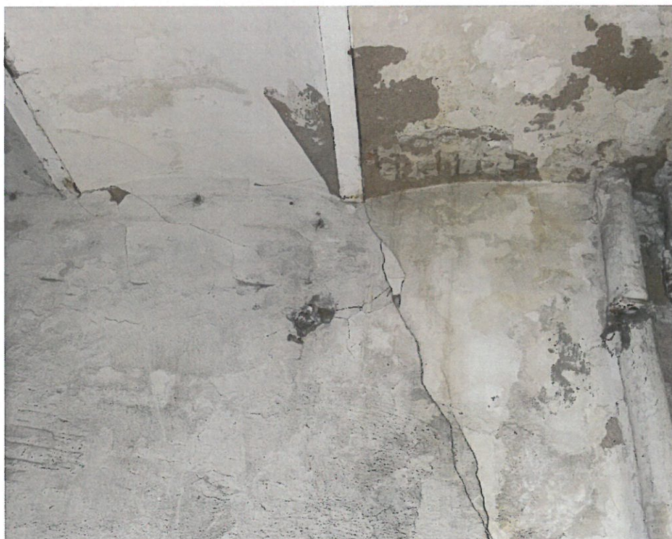
Fot. 20. Parter. Korytarz. Pomieszczenie 1.1. Widok ukośnej rysy pod belką stropową. Rysa ta świadczy o przekroczeniu nośności muru na docisk po stopkę belki stalowej.
