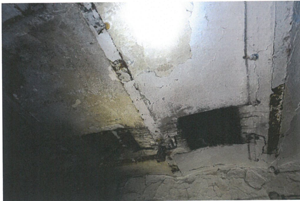
Fot. 14. Piwnica. Poziom -1. Pomieszczenie -0.3. Widok od dołu stropów odcinkowych na belkach stalowych. Kształtowniki stalowe są mocno skorodowane.
