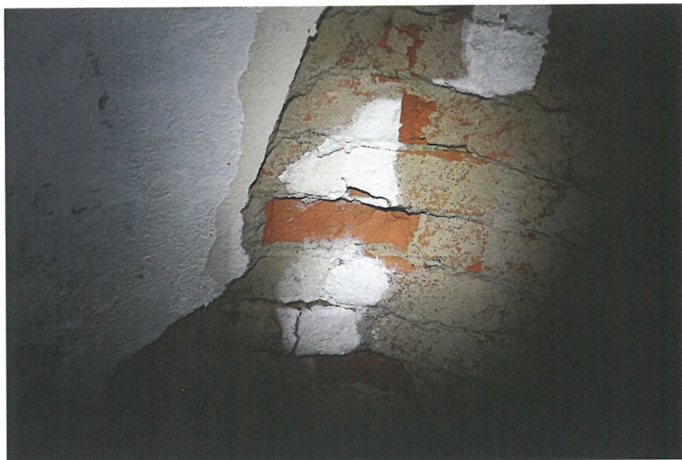
Fot. 18. Piwnica. Poziom – 1. Pomieszczenie -0.5. Ogólny widok od dołu stropu odcinkowego na belkach stalowych. Ceglane stropy odcinkowe są zawilgocone i wykazują ubytki w wyniku korozji mrozowej.
