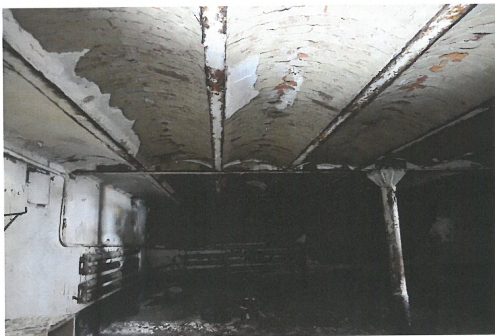
Fot. 22. Jak fot. 23. Widoczna destrukcja wilgotnościowa ścian i sklepień (odpadanie tynku)
