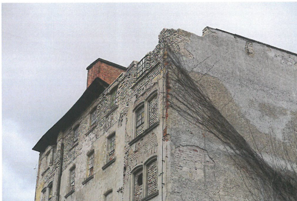
Fot. 7. Widok górnej części budynku. Widoczny brak dachu, który zawalił się do środka budynku
