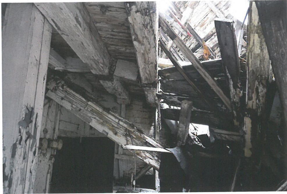
Fot. 23. I piętro, pomieszczenie 2.2. Widok całkowicie zawalonych stropów drewnianych wyższych kondygnacji
