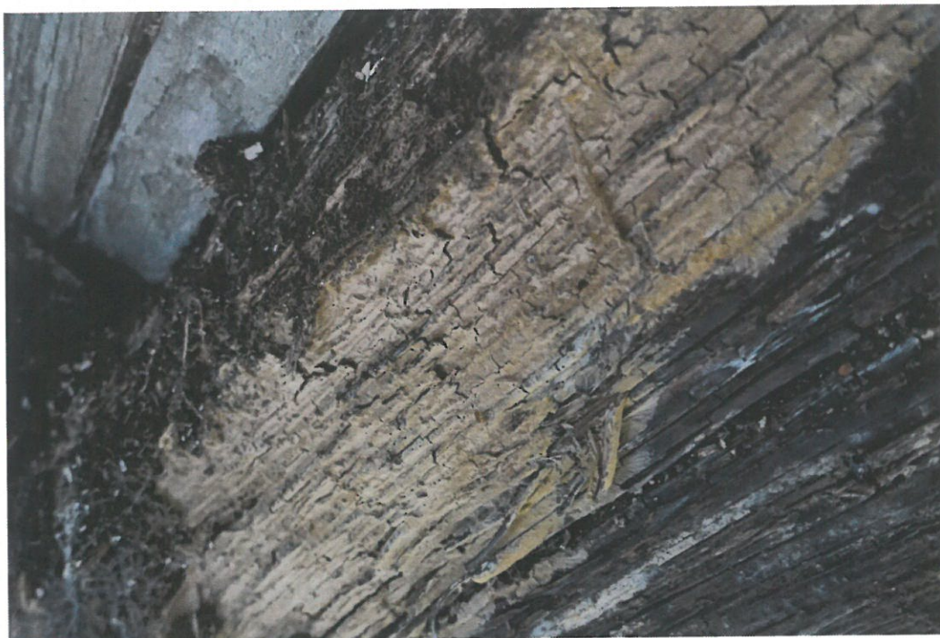
Fot. 27. I piętro, pomieszczenie 2.2. Widok rozkładu brunatnego w elementach drewnianych zawalonego stropu
