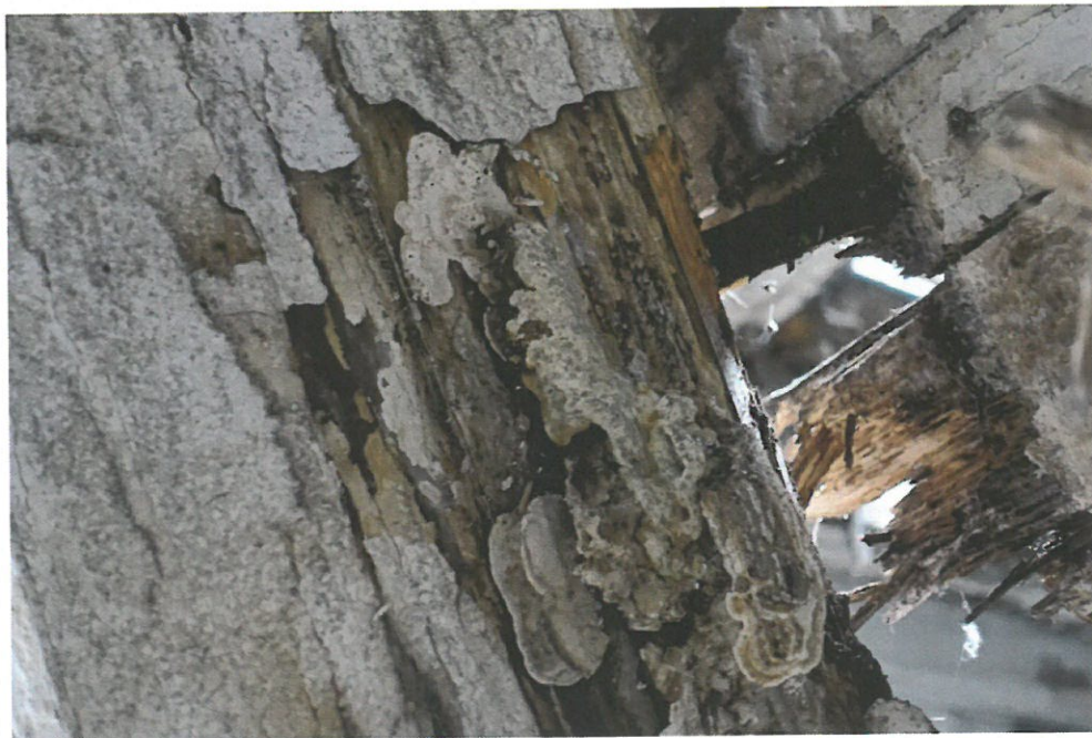
Fot. 26. I piętro, pomieszczenie 2.2. Widok owocników grzyba domowego właściwego na elementach drewnianych zawalonego stropu
