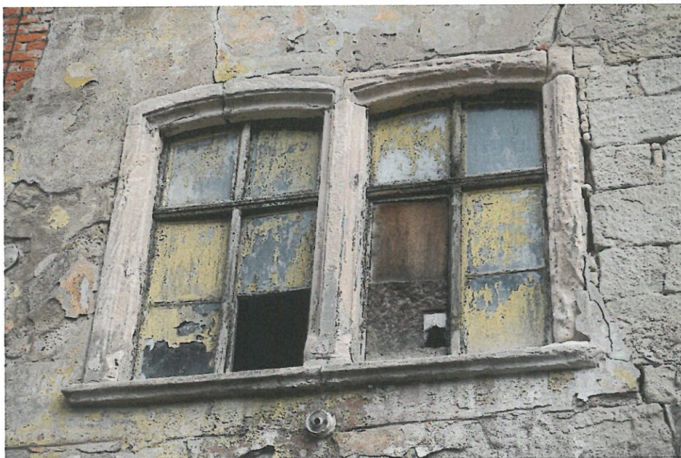
Fot. 4. Widok fragmentu elewacji frontowej. Widoczne są uszkodzenia elementów kamiennych z piaskowca stanowiących obramowania okien
