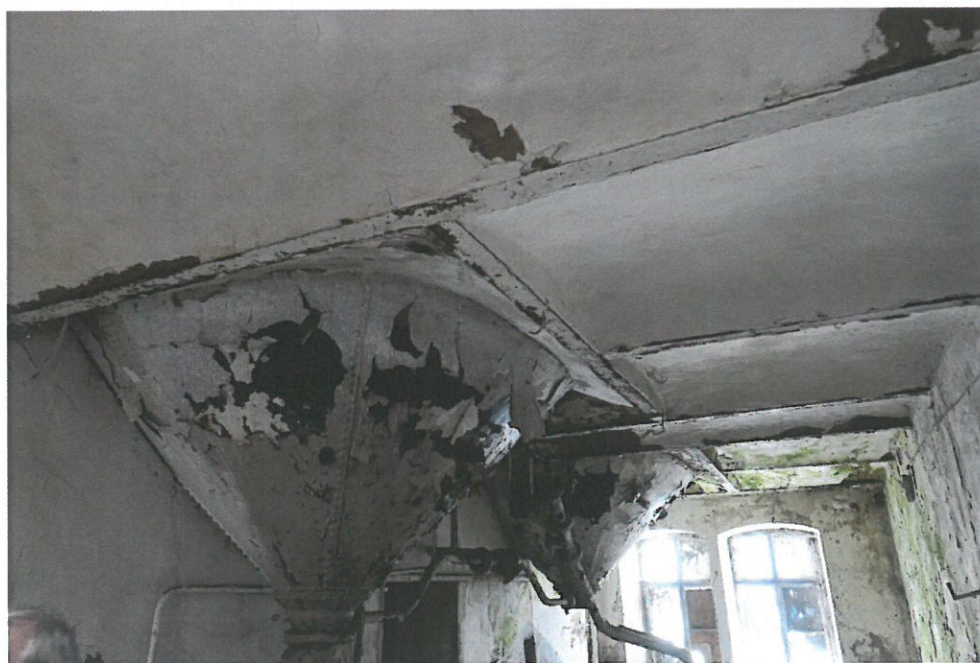
Fot. 30. I piętro, pomieszczenie 2.1. Widok od dołu stropu. Widoczny rozwój glonów na ścianach, świadczący o dużym zawilgoceniu murów.
