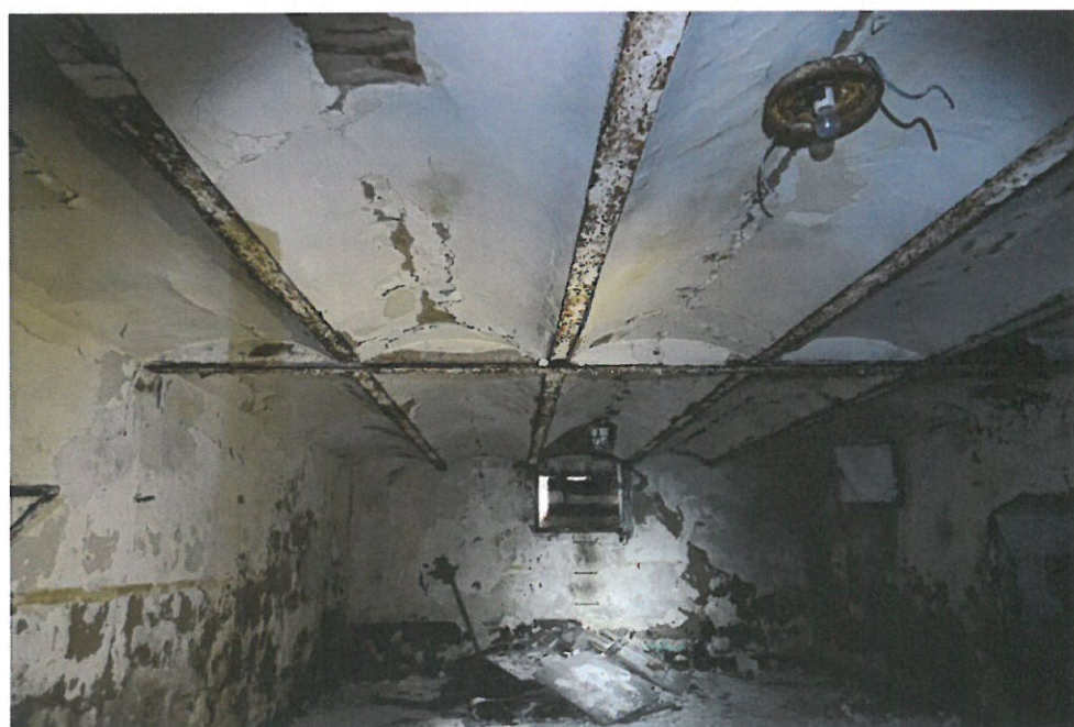
Fot. 16. Piwnica. Poziom – 1. Pomieszczenie -0.4. Ogólny widok od dołu stropu odcinkowego na belkach stalowych. Kształtowniki stalowe są mocno skorodowane. Ściany są mocno zawilgocone.
