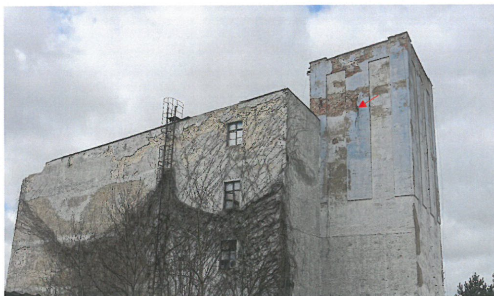
Fot. 8. Widok elewacji wschodniej z zaznaczeniem strzałkami rys (porównaj z rysunkiem zamieszczonym w załączniku 3)
