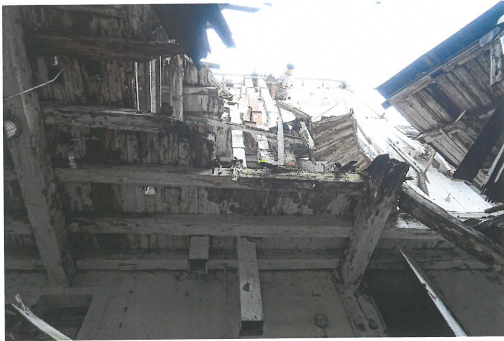
Fot. 25. I piętro, pomieszczenie 2.2. Widok całkowicie zawalonych stropów drewnianych wyższych kondygnacji oraz dachu.
