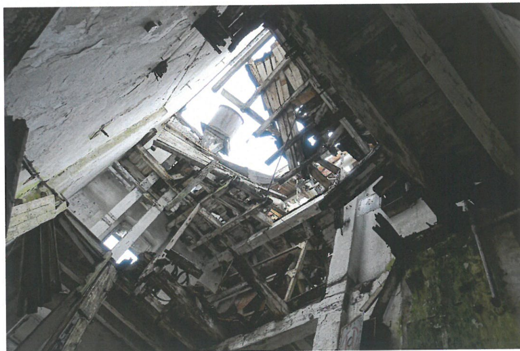
Fot. 28. I Piętro. Pomieszczenie 2.1. Widok zawalonych stropów drewnianych z pomieszczenia 2.1
