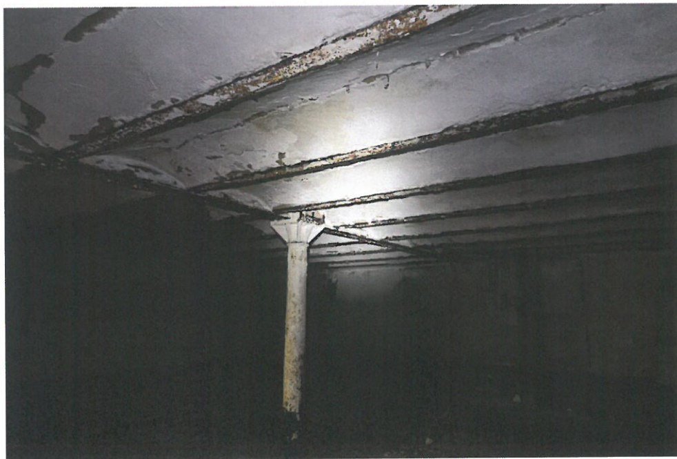
Fot. 17. Piwnica. Poziom – 1. Pomieszczenie -0.5. Ogólny widok od dołu stropu odcinkowego na belkach stalowych. Kształtowniki stalowe są mocno skorodowane, sklepienia są spękane i nasiąknięte wodą.
