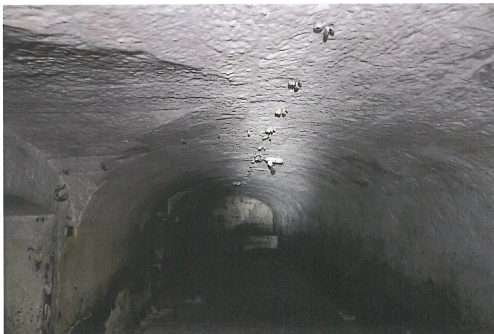
Fot. 15. Piwnica. Poziom – 1. Pomieszczenie -0.1. Ogólny widok sklepienia koszowego pod korytarzem głównym. Ściany i sklepienie są mocno zawilgocone. Na powierzchni ścian występuje rozwój grzybów pleśniowych.
