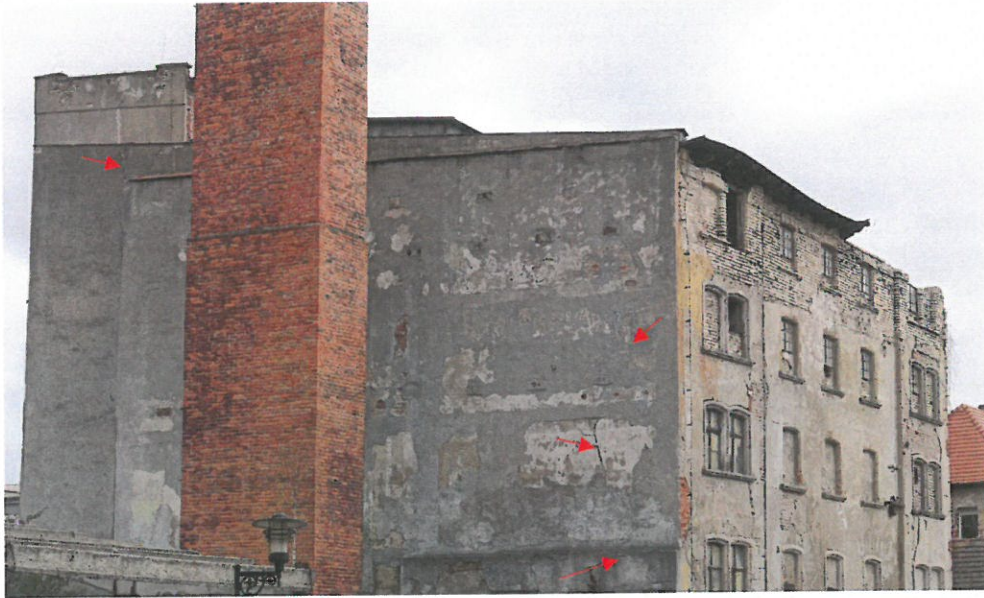
Fot.13. Widok górnej części elewacji zachodniej z zaznaczonymi strzałkami rysami.
