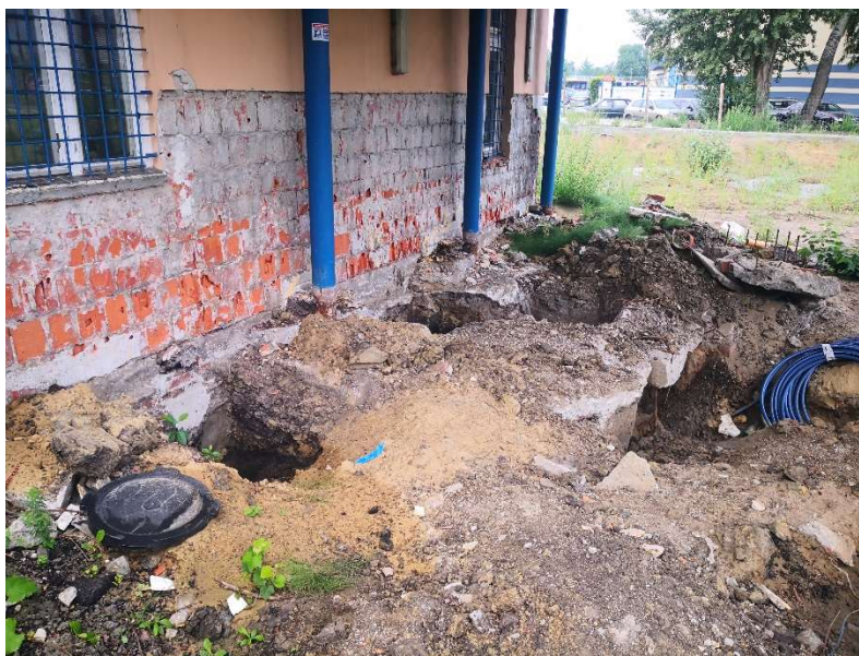
Teren przed budynkiem/pod wiatą. Widoczne przyłącze wodociągowe i wykopy dla potrzeb ułożenia przyłącza kanalizacyjnego. Źródło: dokumentacja fotograficzna własna
