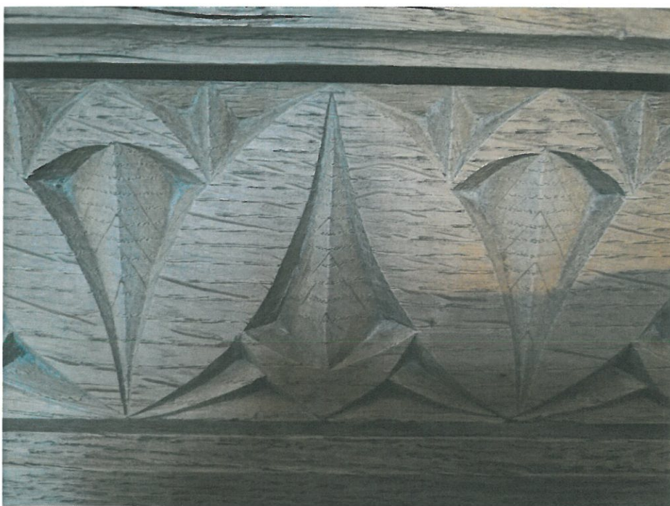
Fot. 39. Kościół pw. Matki Bożej Królowej Aniołów, Biały Dunajec. Zbliżenie na górny, reliefowy, złożony pas boazerii. Wymyte złocenia.
