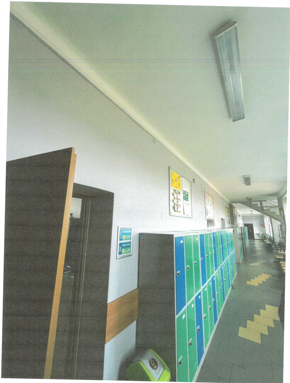
Widok na trasę kablową do kanału kablowego.
