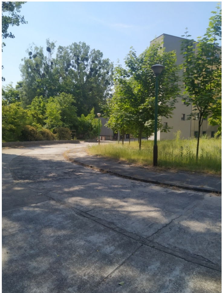
8.Nawierzchnia ist. betonowa drogi do remontu
