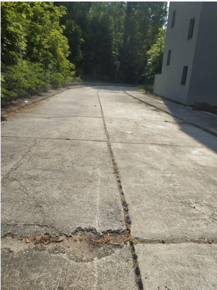
7.Nawierzchnia ist. betonowa drogi do remontu
