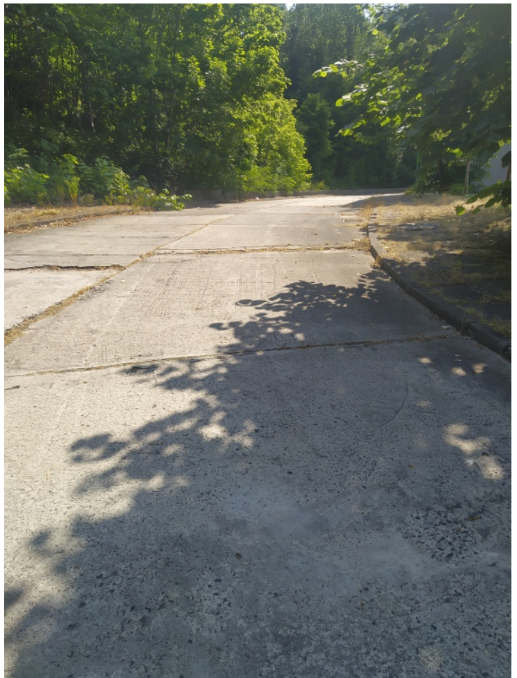
6.Nawierzchnia ist. betonowa drogi do remontu
