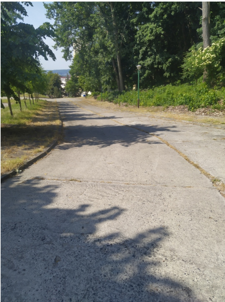
5.Nawierzchnia ist. betonowa drogi do remontu
