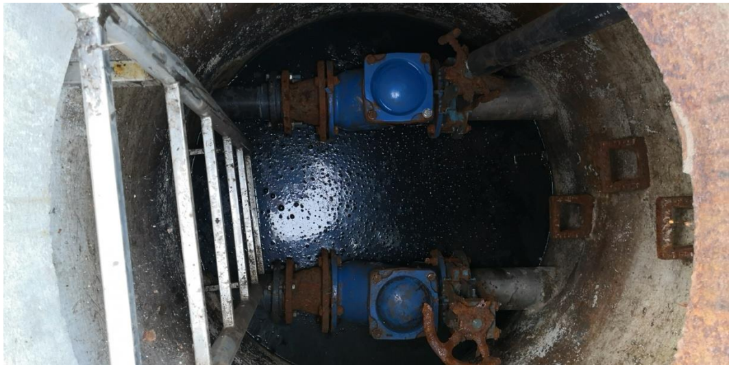
Fot. 3 Komora zasuw
