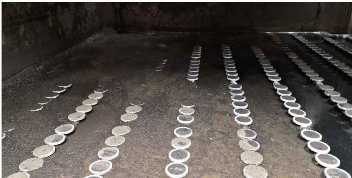
Fot. 21 Złogi piasku w komorze reaktora biologicznego
