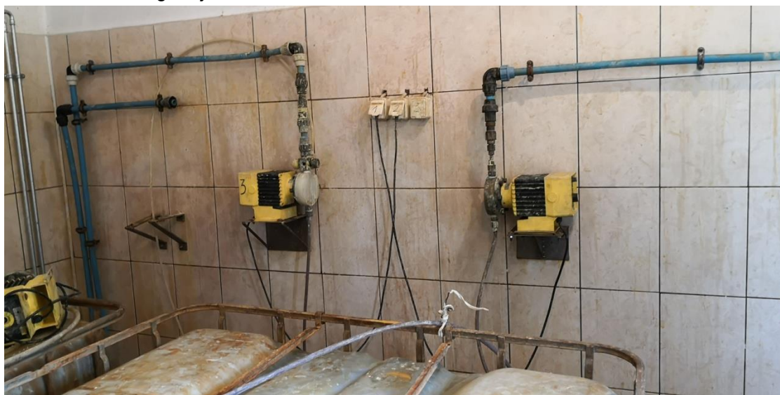
Fot. 9 Pomieszczenie stacji dozowania PIX-u.
