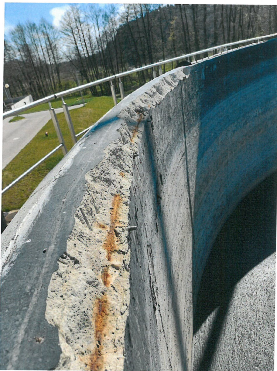
Zdjęcie nr 1 „Widok uszkodzenia górnej części ściany żelbetowej komory”
