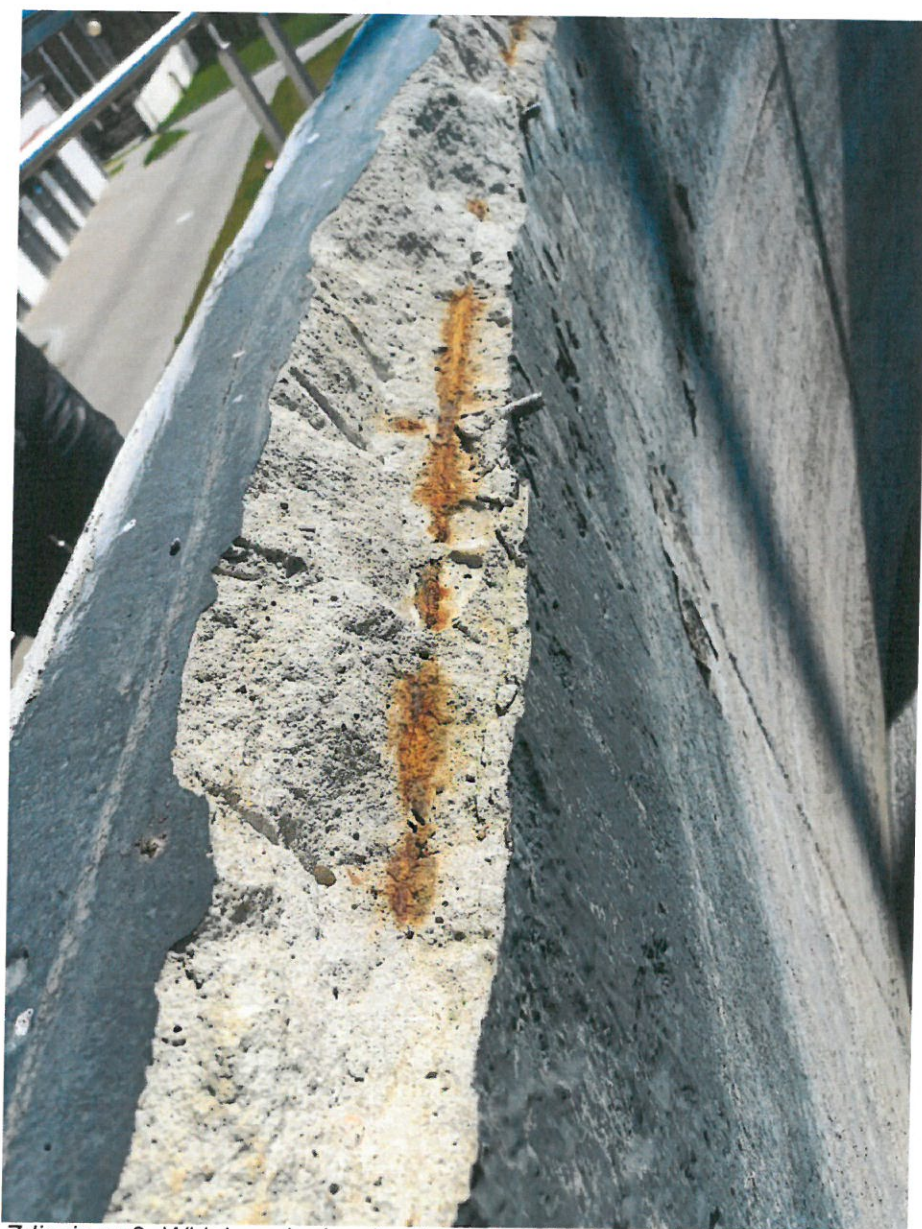
Zdjęcie nr 2 „Widok uszkodzenia górnej części ściany żelbetowej komory”
