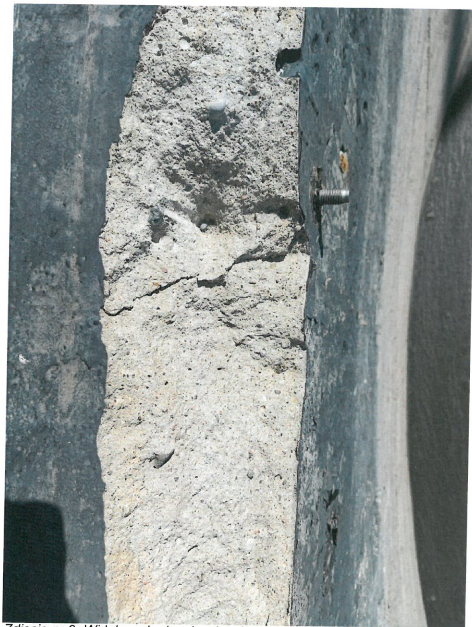
Zdjęcie nr 3 „Widok uszkodzenia górnej części ściany żelbetowej komory”
