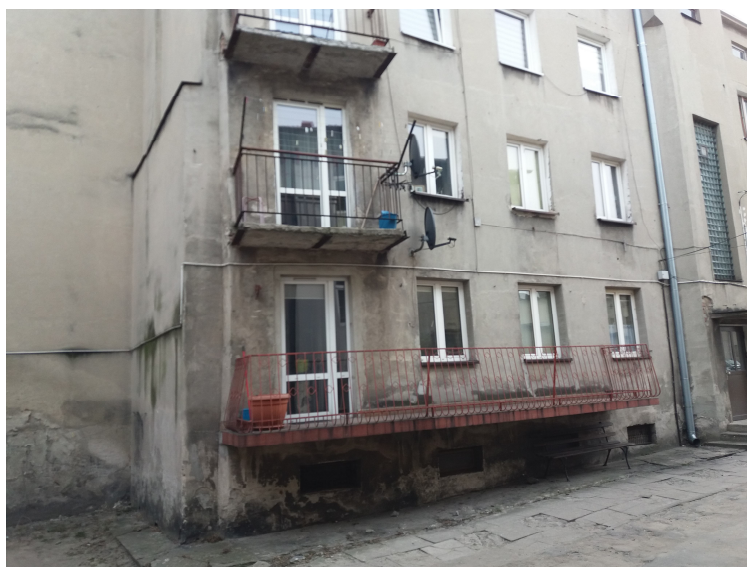
Zdjęcie nr 4: Widok elewacji frontowej – strona lewa, widoczne uszkodzenia płyty balkonowej i korozja konstrukcyjnych elementów stalowych
