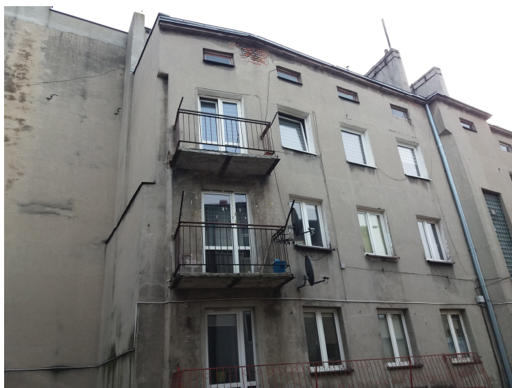
Zdjęcie nr 3: Widok elewacji frontowej – strona lewa, widoczne uszkodzenia płyty balkonowej
