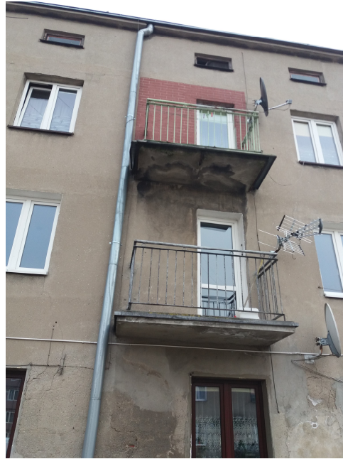
Zdjęcie nr 5: Widok balkonów, widoczne uszkodzenia płyty balkonowej, ślady zawilgocenia i przemarzania oraz korozja konstrukcyjnych elementów stalowych
