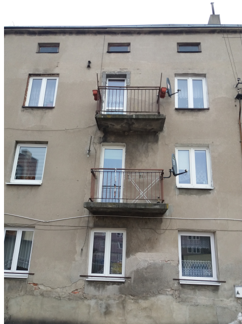
Zdjęcie nr 6: Widok balkonów, widoczne uszkodzenia płyty balkonowej, ślady zawilgocenia i przemarzania oraz korozja konstrukcyjnych elementów stalowych
