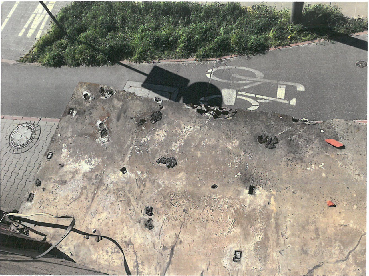
Ilustracja 4: Widok góry zadaszzenia z widocznymi spękaniami, korozją biologiczną oraz z miejscami na montaż blachy
