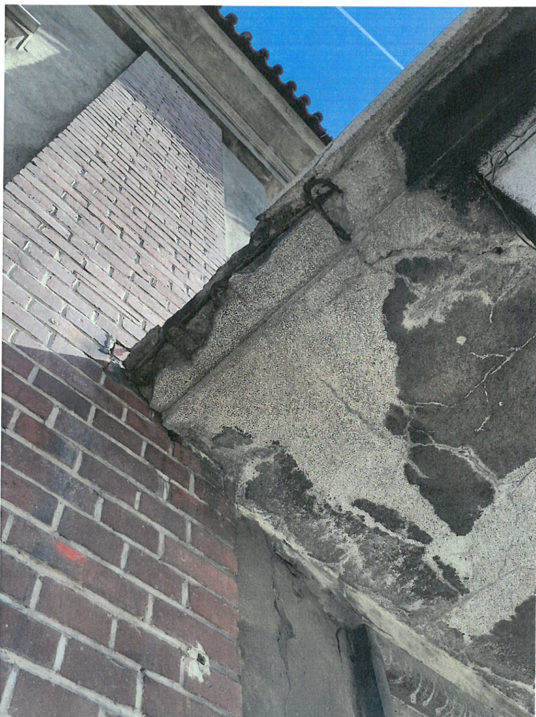
Ilustracja 3: Widok na spód zadaszenia z widocznym ubytkiem lastriko oraz przebarwieniami
