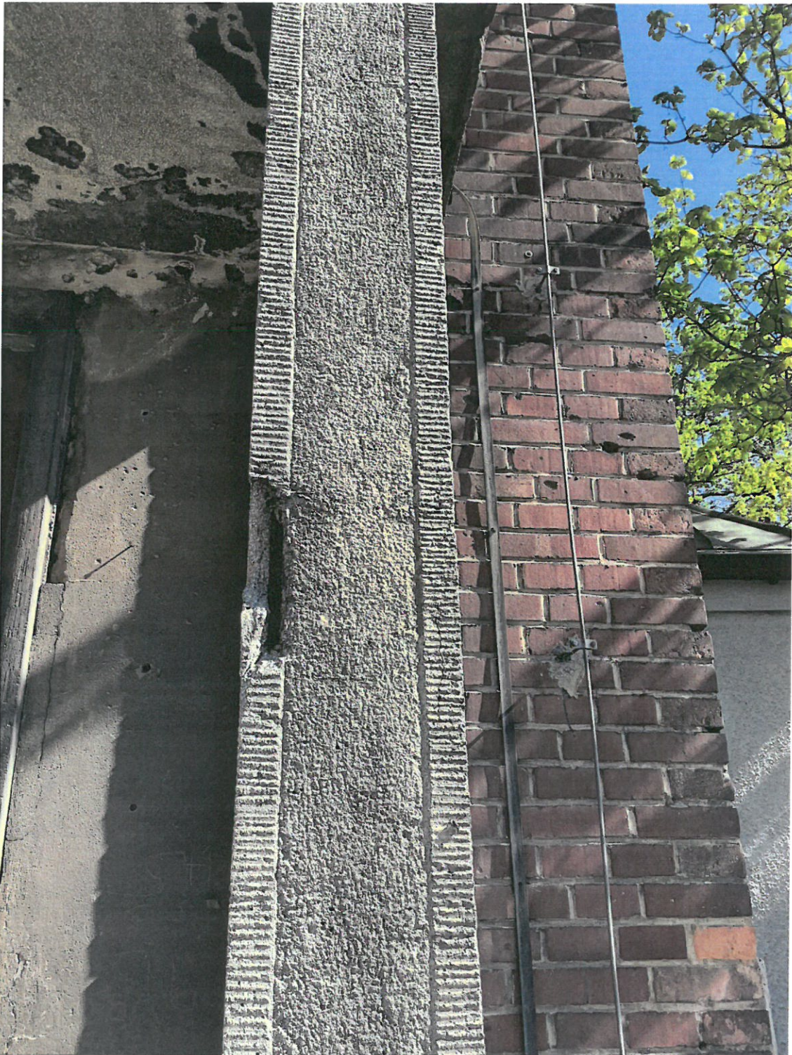
Ilustracja 2: Słup zadaszzenia z widocznym ryflowaniem oraz ubytkiem lastriko
