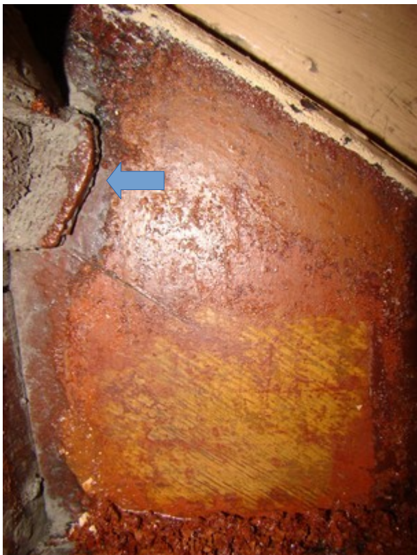
fot. 18: odkrywka po wewnętrznej stronie policzka schodów; widoczne ugrowo-żółte malowanie, widoczny fragment pierwotnego stopnia, pozostawiony w gnieździe w policzku (strzałka)
