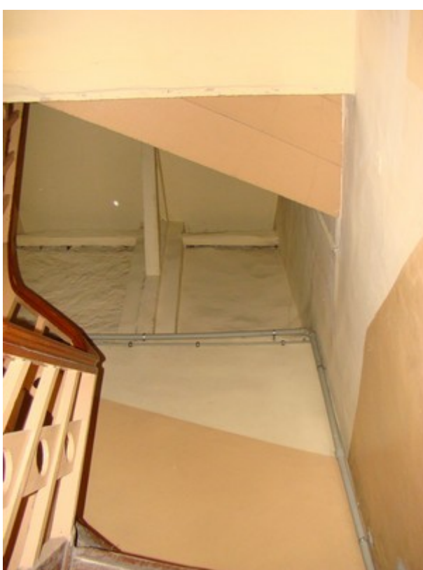
fot. 4: widok na ścianę szczytową na poziomie II pięta, po lewej stronie najstarszy z tynków nie przykryty kolejną wyprawą
