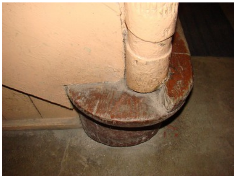
fot. 19: zachowany najniższy stopień schodów z widoczną nałożoną na niego wtórnie kolejną stopnicą (uszczerbioną na łuku)
