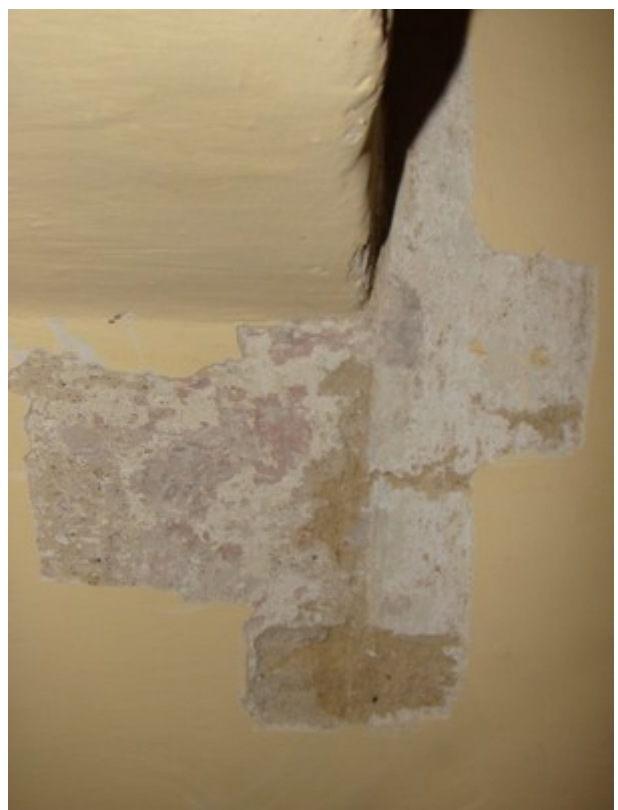
fot. 9: odkrywka na parterze obejmująca: tynk przynależny do fazy przebudowy - z widocznymi śladami czerwonej malatury - po lewej i tynk pierwotny w niszy - po prawej - z widocznymi śladami pobiał
