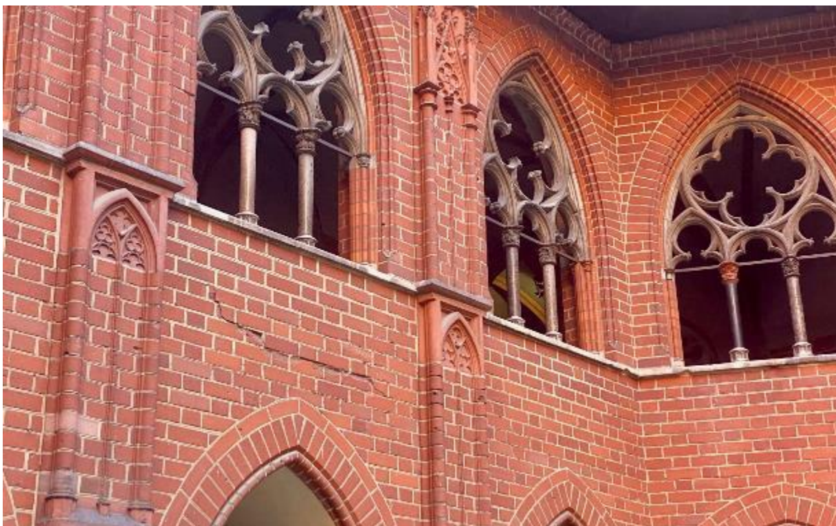
Ilustracja 40 Spękania spoin oraz materiału ceramicznego.
