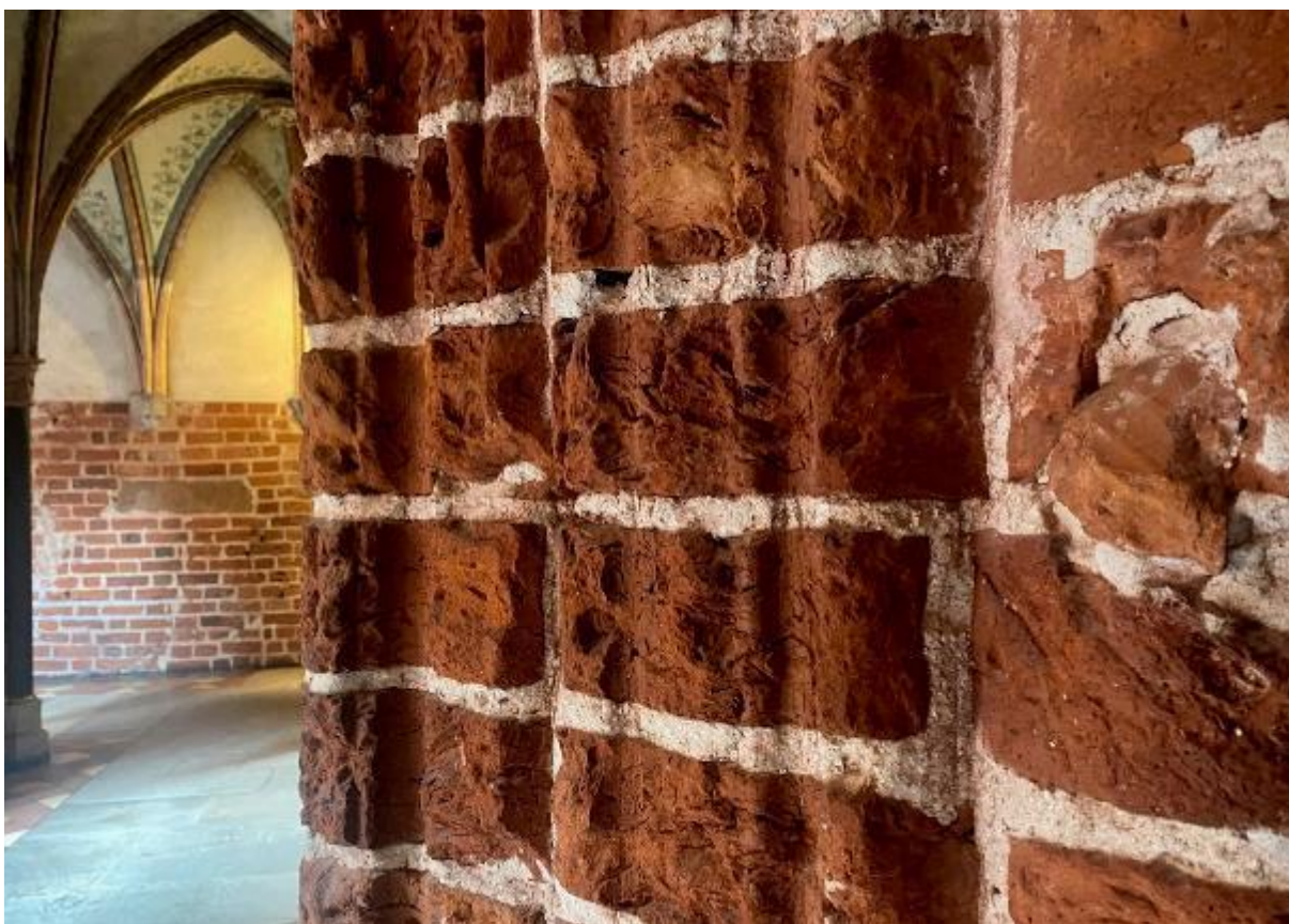
Ilustracja 34 Erozja materiału ceramicznego, materiał wymaga wzmocnienia strukturalnego.
