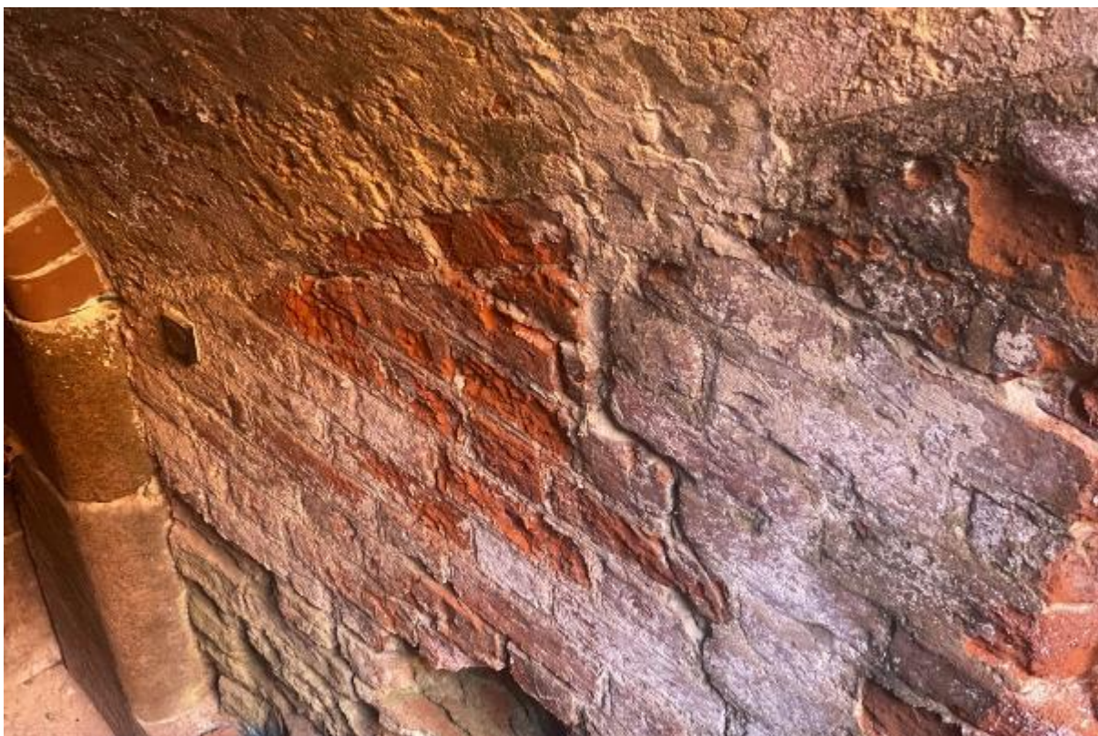
Ilustracja 43 Wysolenia na powierzchni cegieł w części zejścia do piwnic.
