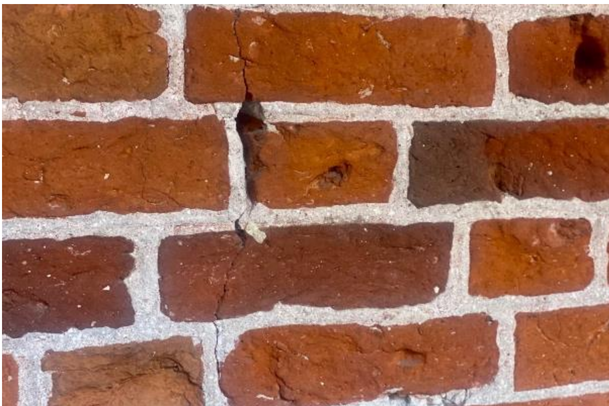
Ilustracja 31 Spękania w części muru oporowego.
