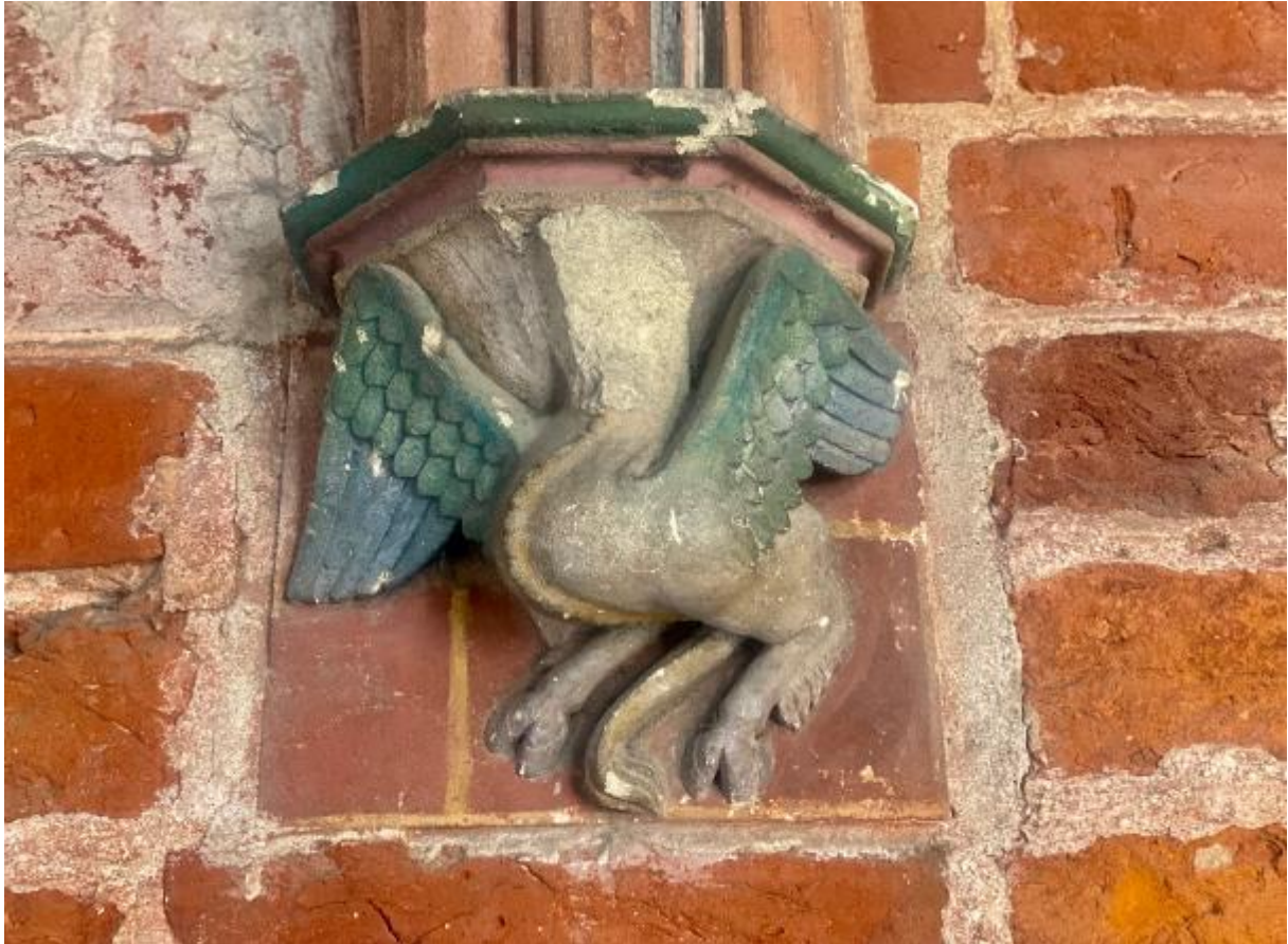
Ilustracja 25 Uszkodzenia kamiennej konsoli.
