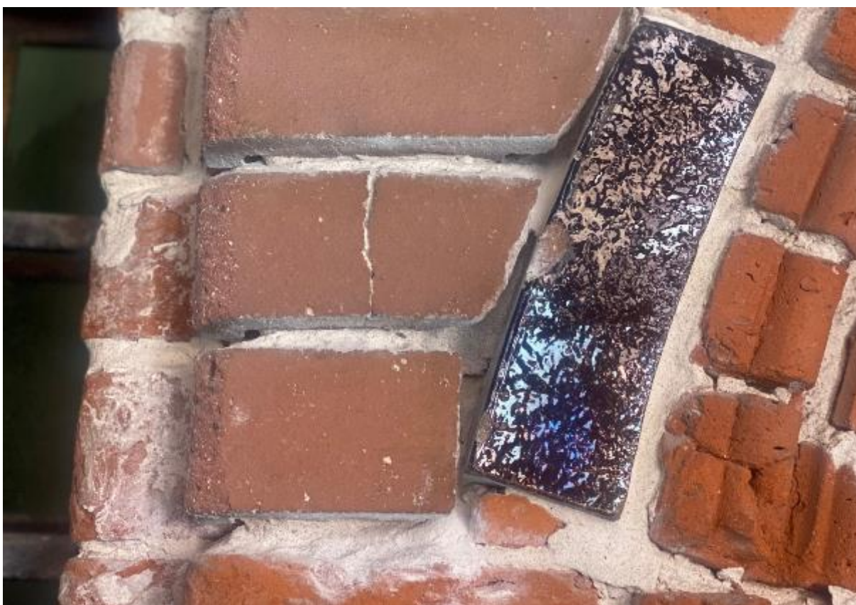
Ilustracja 28 Uszkodzenia spoinowania cegieł może spowodować całkowite odspojenie się materiału ceramicznego od powierzchni ściany.
