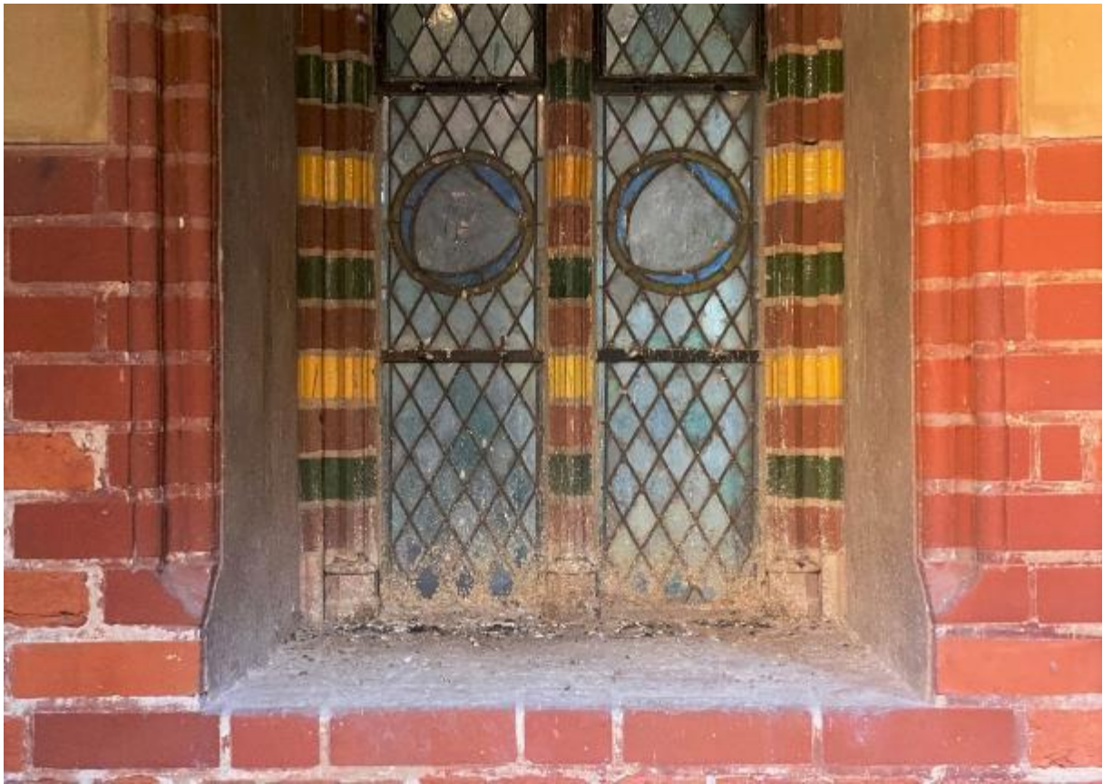
Ilustracja 35 Zniszczenia spowodowane przez obecność ptactwa.
