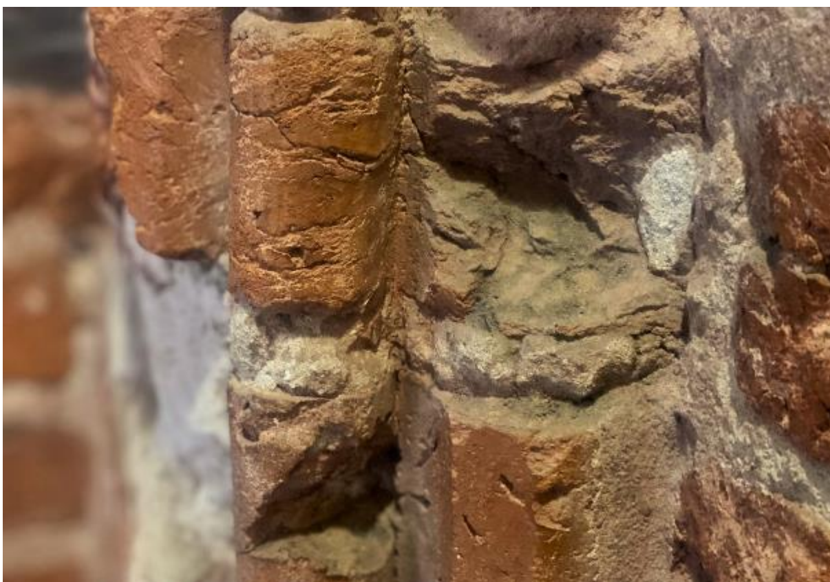
Ilustracja 32 W miejscu ubytków zbierają się zabrudzenia.
