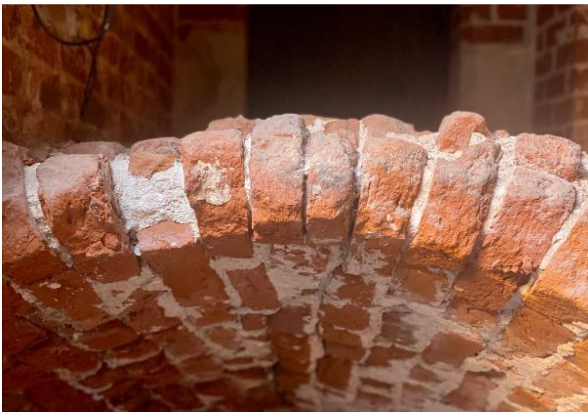
Ilustracja 44 Uszkodzenia cegieł przy wejściu do piwnic.
