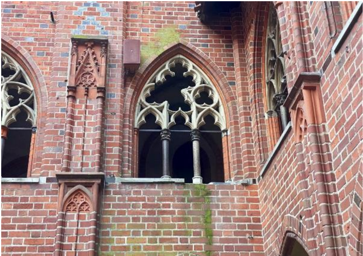
Ilustracja 39 Uszkodzenia maswerku, zniszczenia spowodowane działaniem wody.
