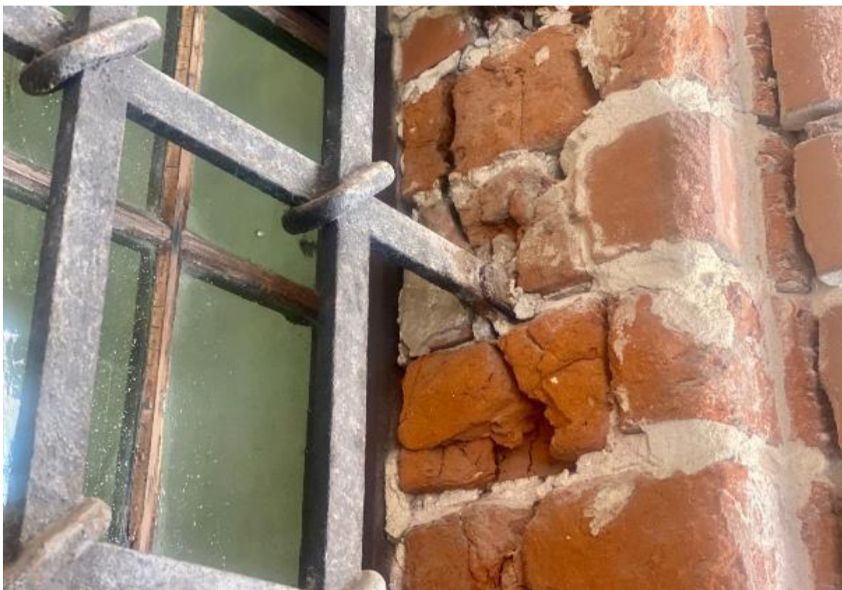
Ilustracja 29 Destrukcja cegieł w miejscu połączenia z metalową kratą.
