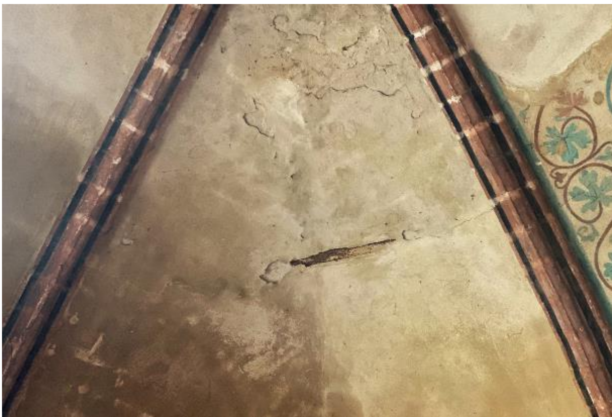
Ilustracja 22 Zniszczenia w obrębie sklepień.
