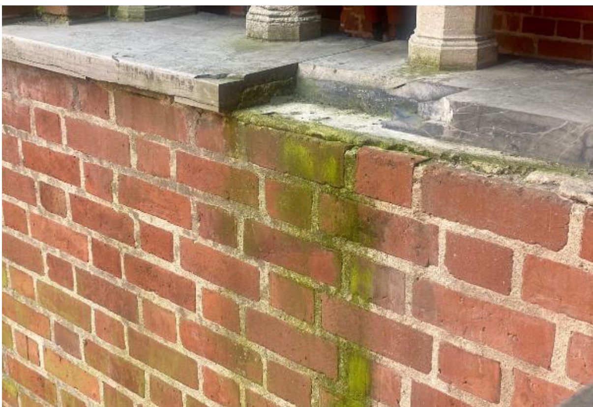
Ilustracja 30 Ubytki kamiennych parapetów spowodowały większe narażenie lica ceglanego na działanie wody. W efekcie obserwuje się rozwój drobnoustrojów.
