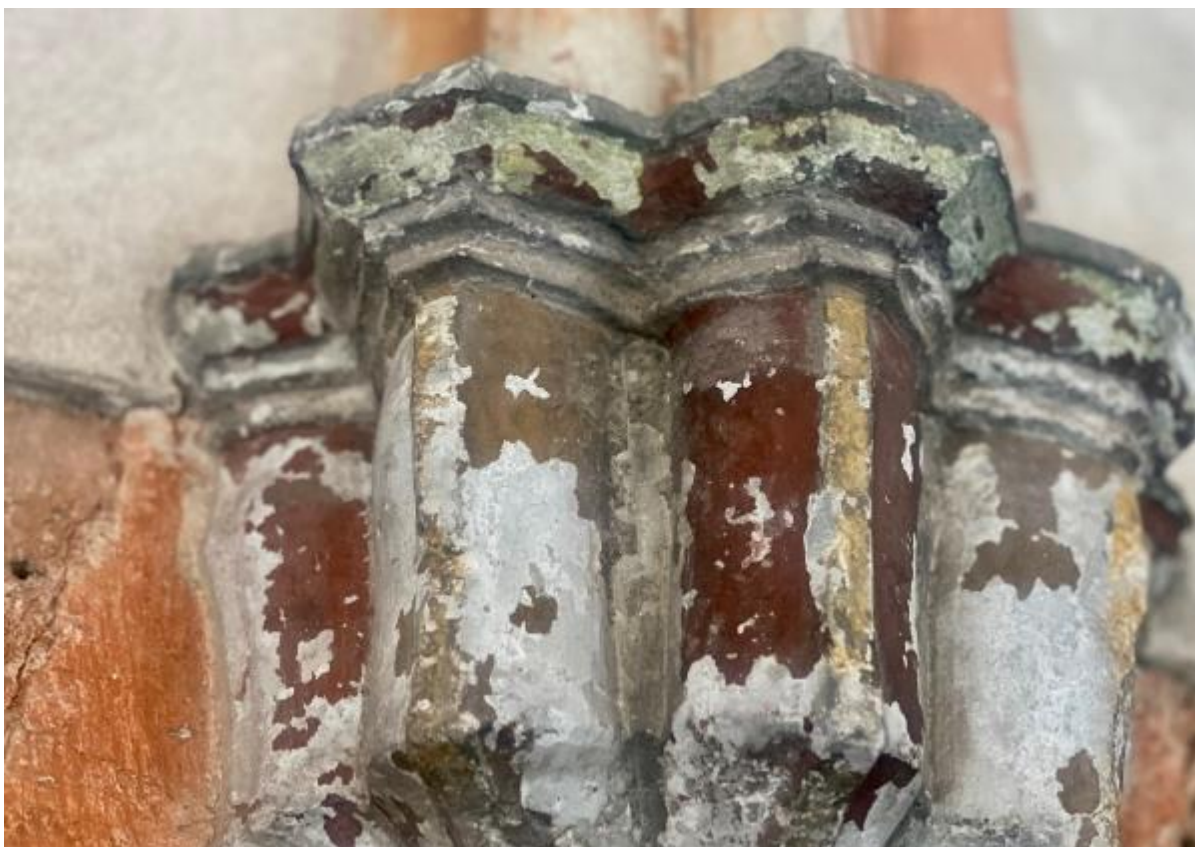
Ilustracja 27 Ubytki warstw malarskich występujące na detalu architektonicznym.
