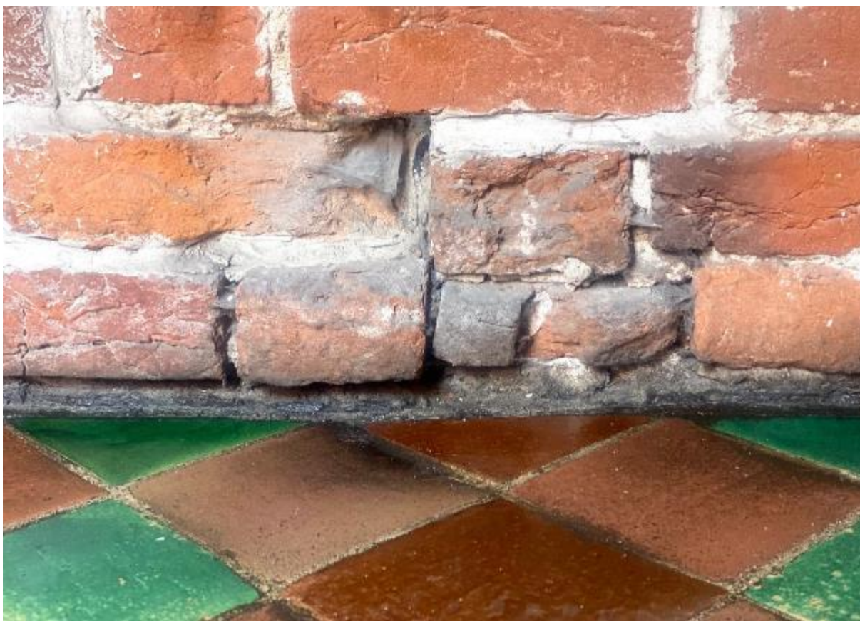
Ilustracja 33 W miejscu ubytków zbierają się zabrudzenia. Można również zaobserwować osypywanie się spoiny.
