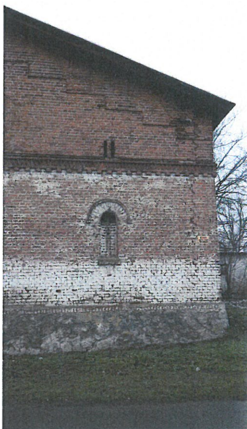
Fot.14. Pęknięcie na ścianie elewacji frontowej od strony drogi powiatowej
