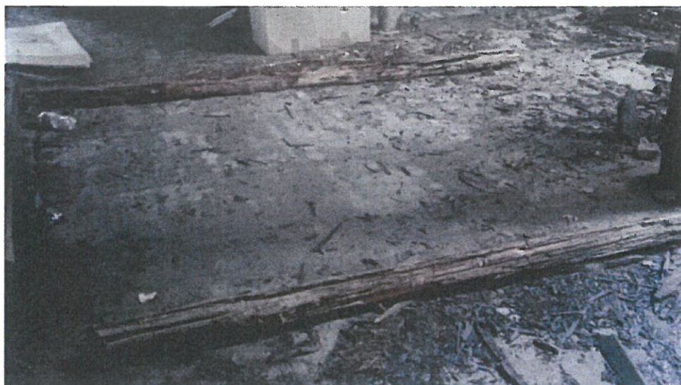
Fot.25. Spróchniałe i zwalone belki wewnątrz obiektu
