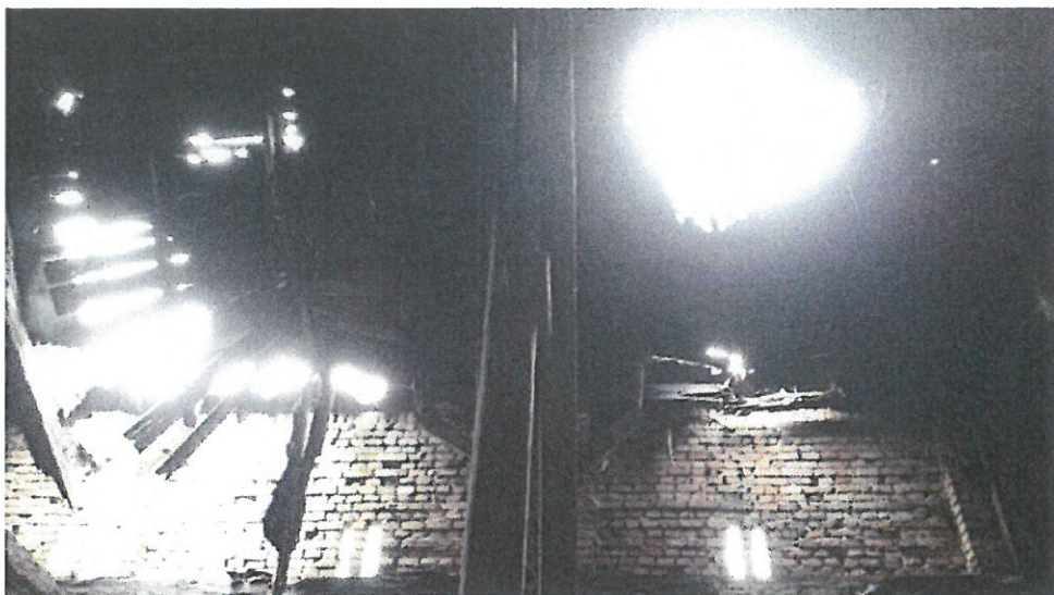
Fot.28. Widok uszkodzonego deskowania i pokrycia wewnątrz obiektu
