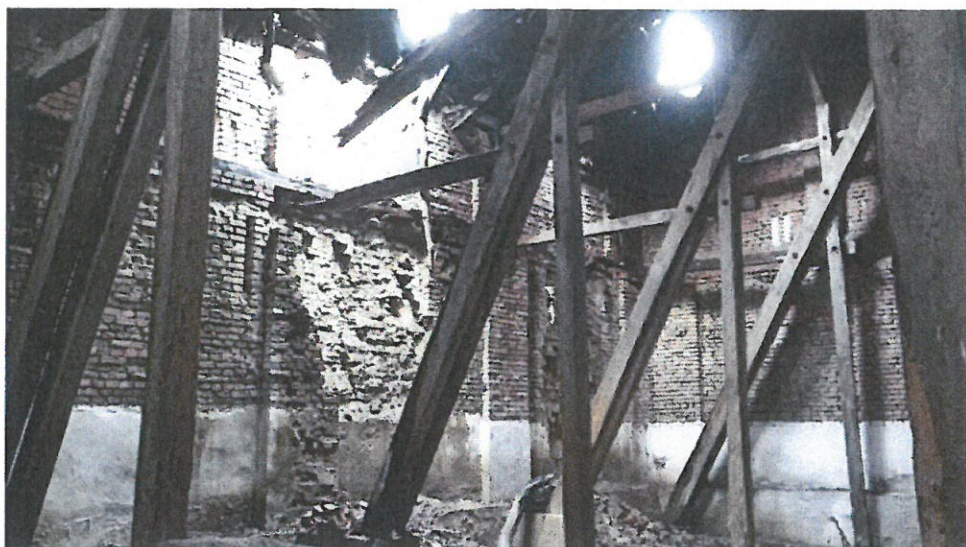
Fot.18. Uszkodzenia wewnętrznego lica muru ściany północno-zachodniej
