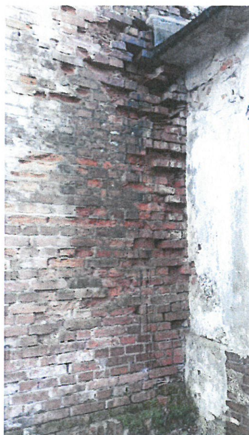
Fot.15. Zawilgocenie i ubytki cegieł na połączeniu stodoły ze ścianą budynku garaży
