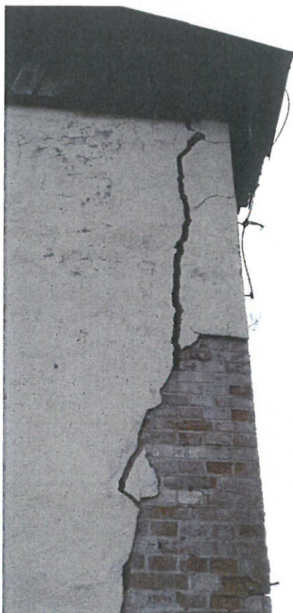
Fot. 11. Widoczna głęboka rysa na całej wysokości ściany, dająca wrażenie „rozchodzenia się” budynku („oderwanie” ściany południowo-zachodniej)
