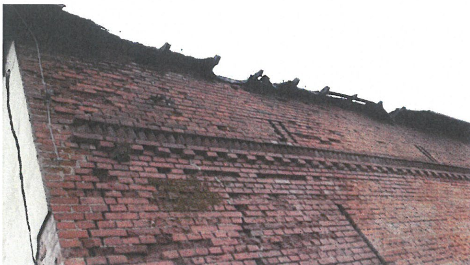
Fot.26. Widoczne ubytki pokrycia dachowego, uszkodzenia okapu
