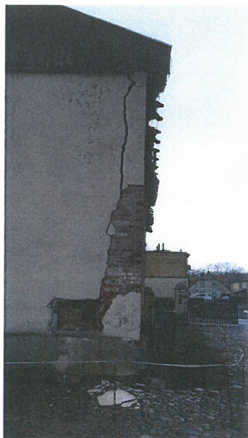
Fot. 12. Obiekt został częściowo ogrodzony z powodu odpadających cegieł, obecny stan stanowi zagrożenie dla osób przebywających w pobliżu budynku, a także w jego wnętrzu
