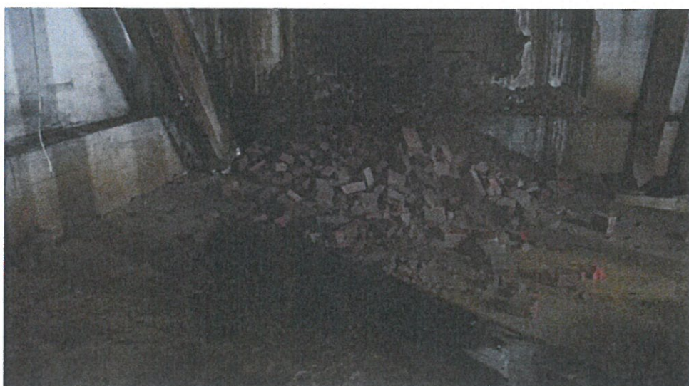
Fot.17. Częściowe zawalenie ściany, stan techniczny stanowi aktualnie zagrożenie dla osób przebywających wewnątrz stodoły
