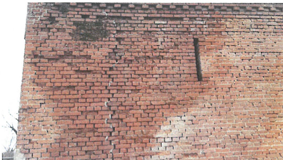
Fot.13. Zawilgocony fragment elewacja południowo-zachodniej z widocznymi spękaniami, ubytkami zaprawy i cegieł;
