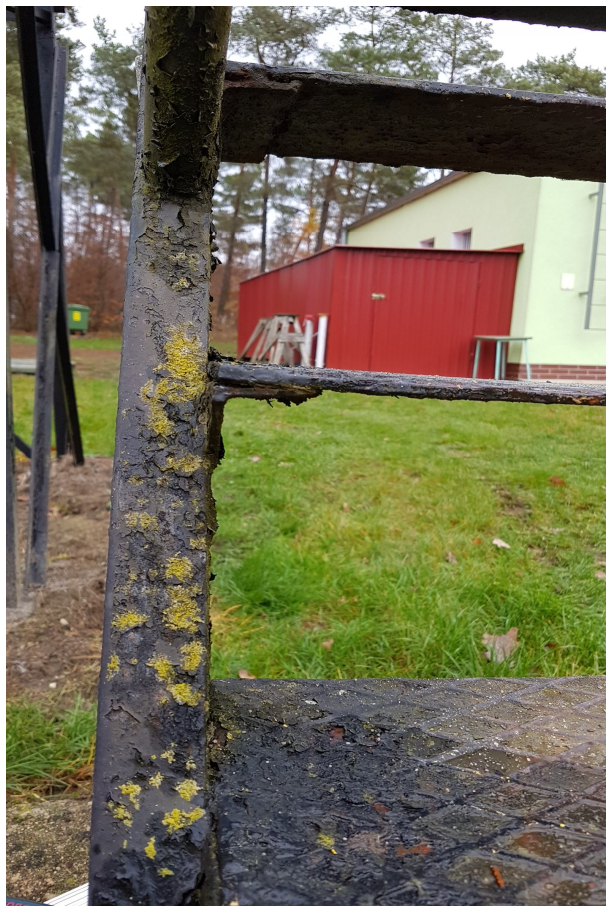
Fot. 4. Widok skorodowanego policzka istniejących schodów stalowych, według stanu na dzień wizji lokalnej.
