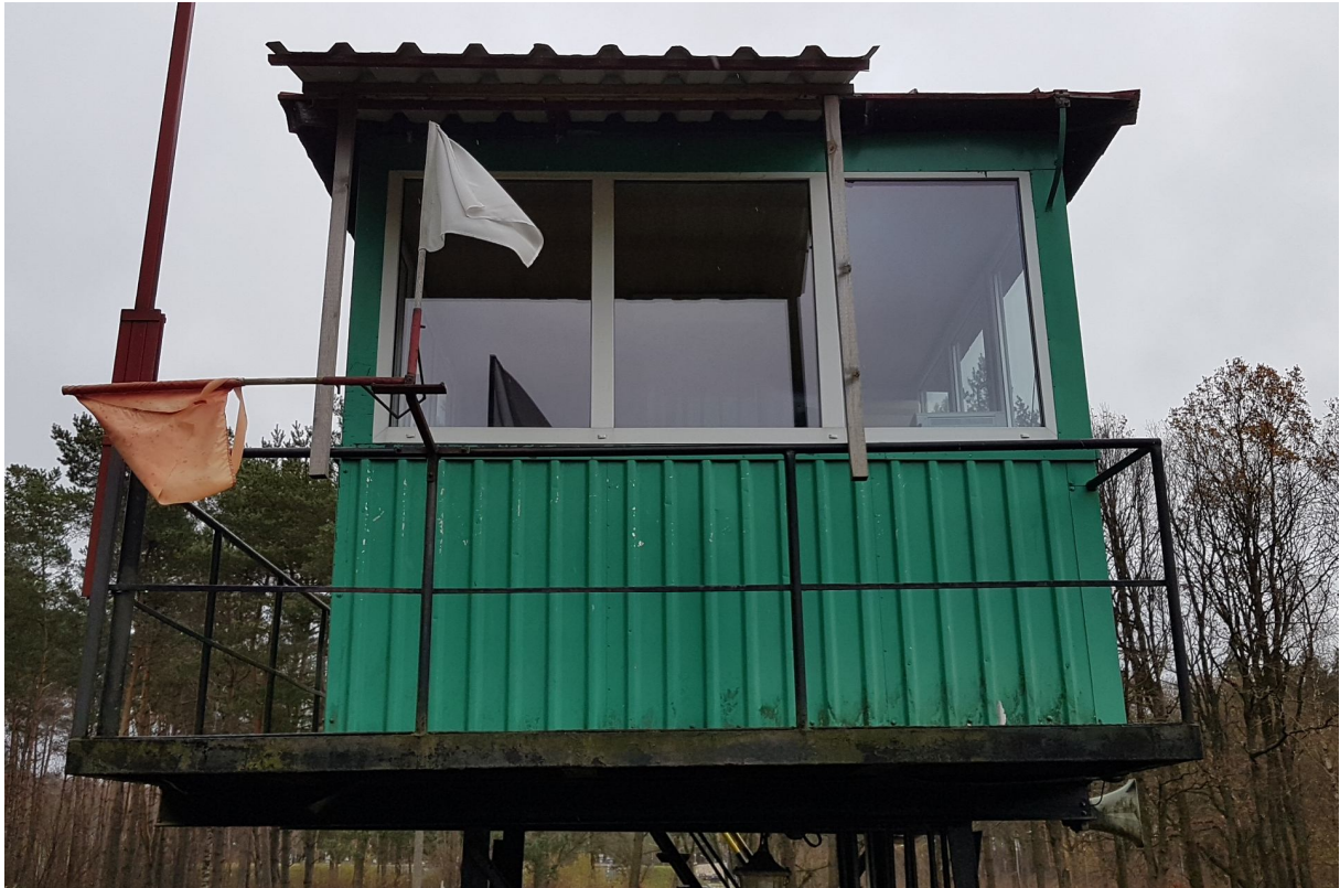
Fot. 5. Kabina stanowiska dowodzenia (SD), widoczne ślady korozji elementów wsporczych pomostu.
