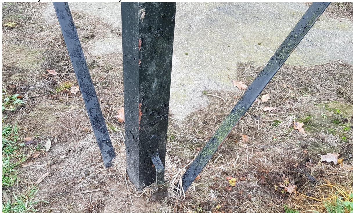
Fot. 2. Podstawa wieży stalowej ze słupkami konstrukcji osadzonymi w fundamencie betonowym, widoczna korozja stali.
