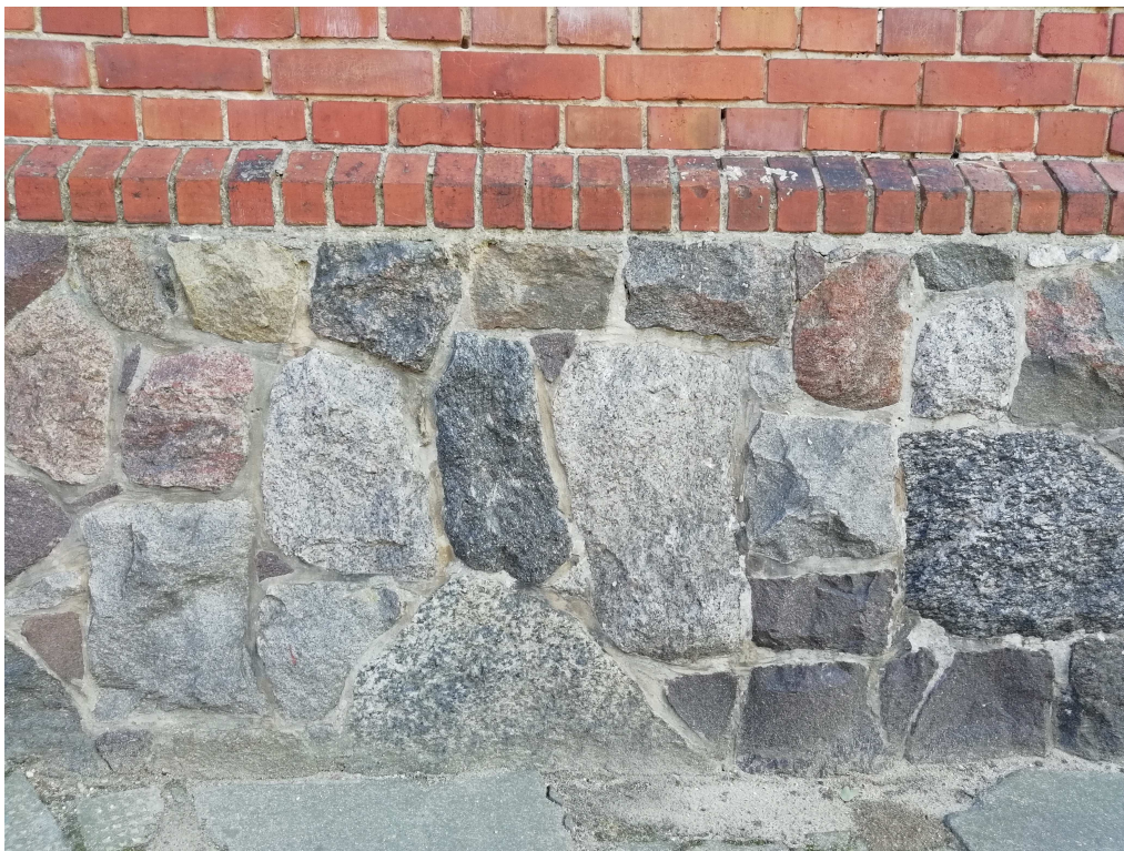
1.1. Istniejący wątek z cegły licowej i cokół kamienny.
