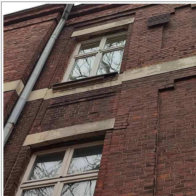
Fot. 1 Uszkodzone nadproże okienne wraz z murem ceglanym
