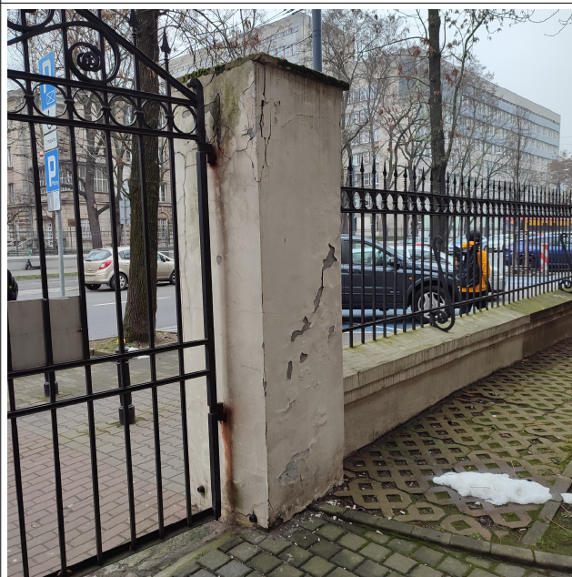
Fot. 6 Uszkodzony lewy słupek przy bramie
