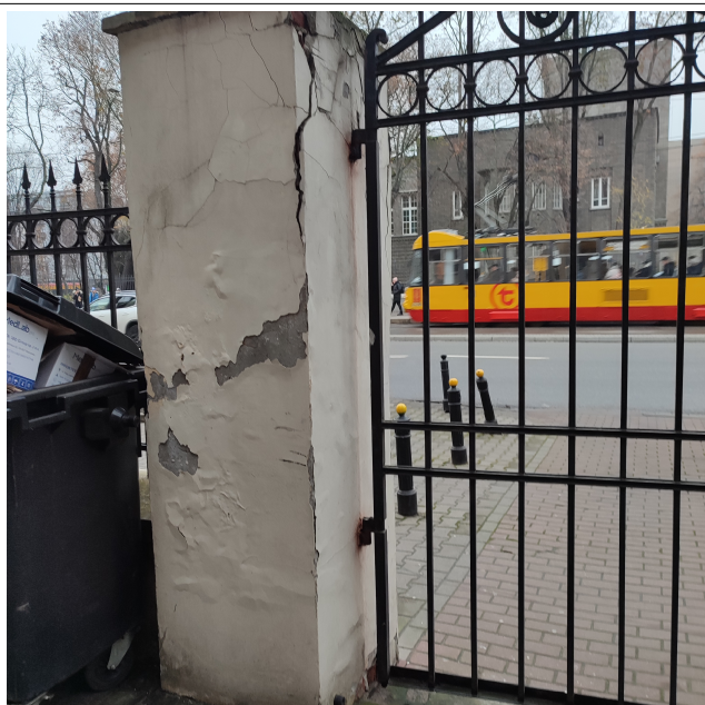
Fot. 5 Uszkodzony prawy słupek przy bramie
