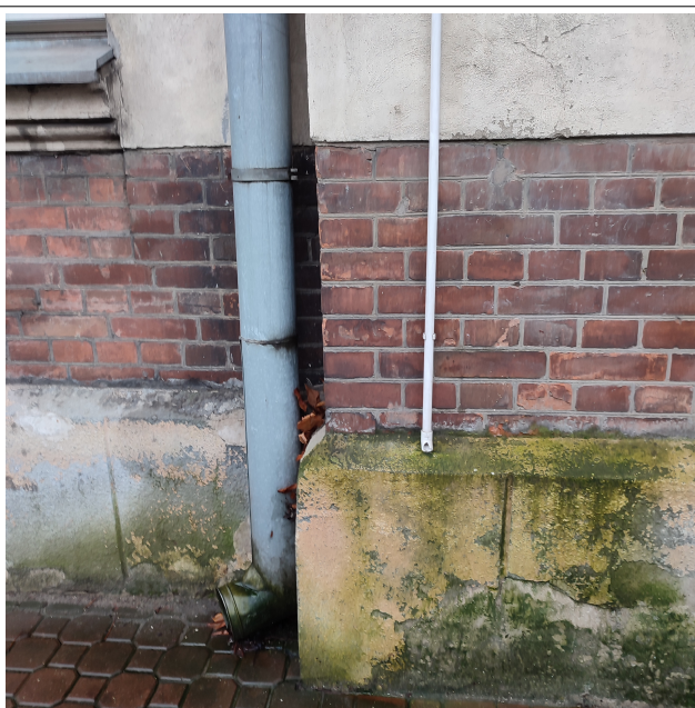
Fot. 2 Silnie zawilgocony cokół budynku
