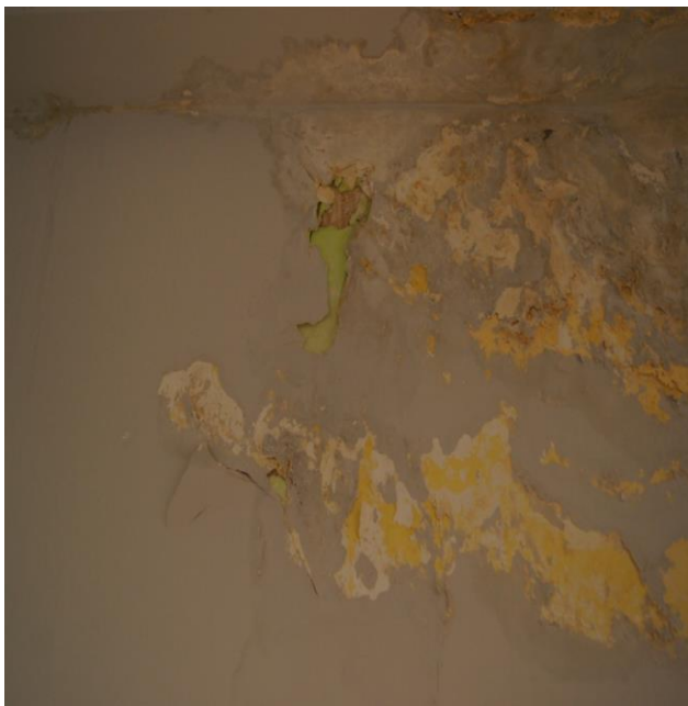
Zawilgocenie ściany zewnętrznej w sąsiedztwie muru oporowego.
