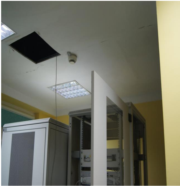
Zawilgocony i zdeformowany strop podwieszony.
