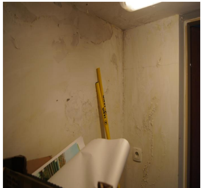
Zawilgocenie ściany zewnętrznej w sąsiedztwie schodów zewnętrznych.
