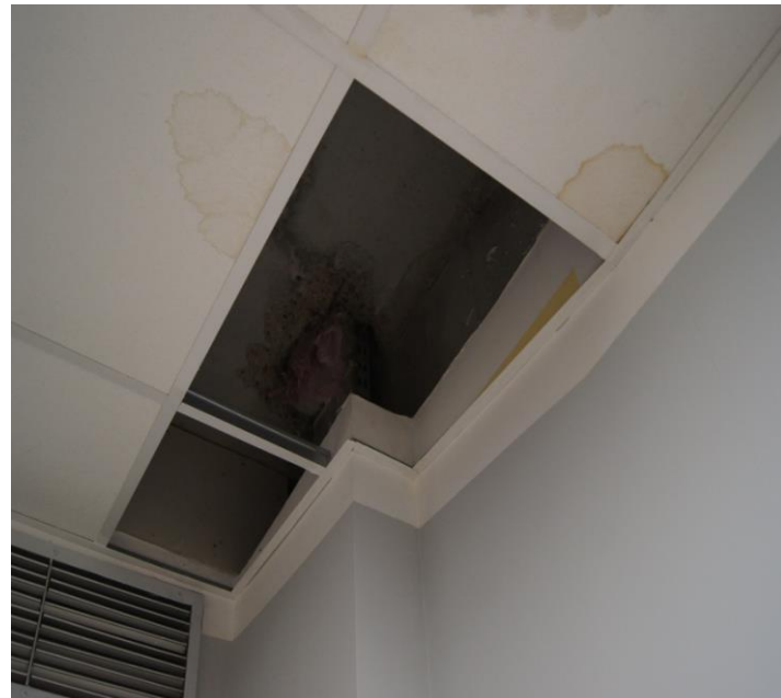
Zawilgocenie stropu i systemowego sufitu podwieszony.
