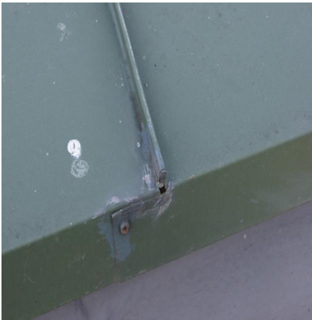
Wadliwie wykonana obróbka blacharska.
