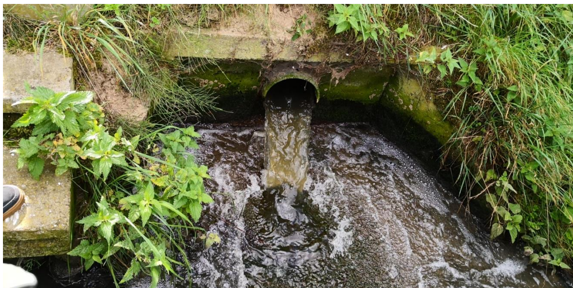
Fot. 13 Wylot do odbiornika
