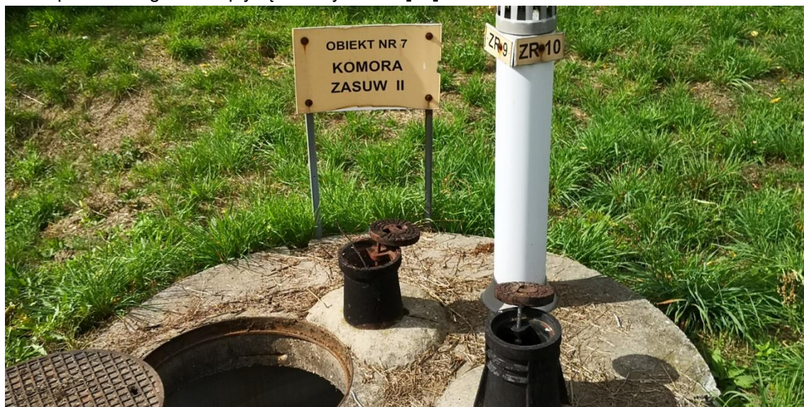
Fot. 12 Komora zasuw
