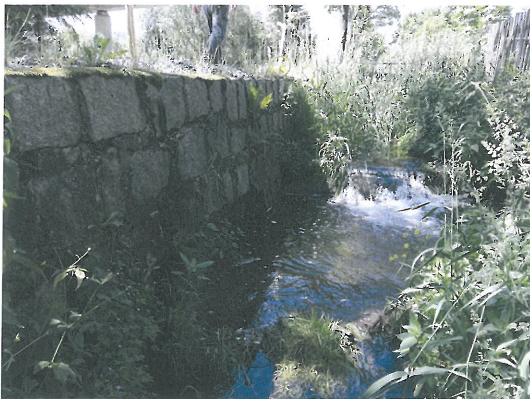
Uszkodzona okładzina kamienna prawego muru oporowego wraz z progiem regulacyjnym w km 2+127
