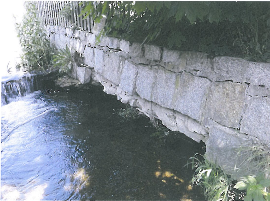
Uszkodzona okładzina kamienna lewego muru oporowego wraz z progiem regulacyjnym w km 2+033
