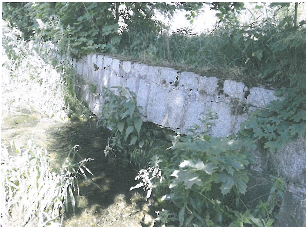
Lokalnie uszkodzona okładzina kamienna lewego muru oporowego
