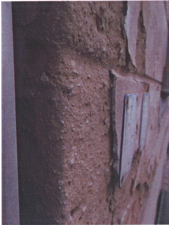
Głęboka erozja tynku oryginalnego
