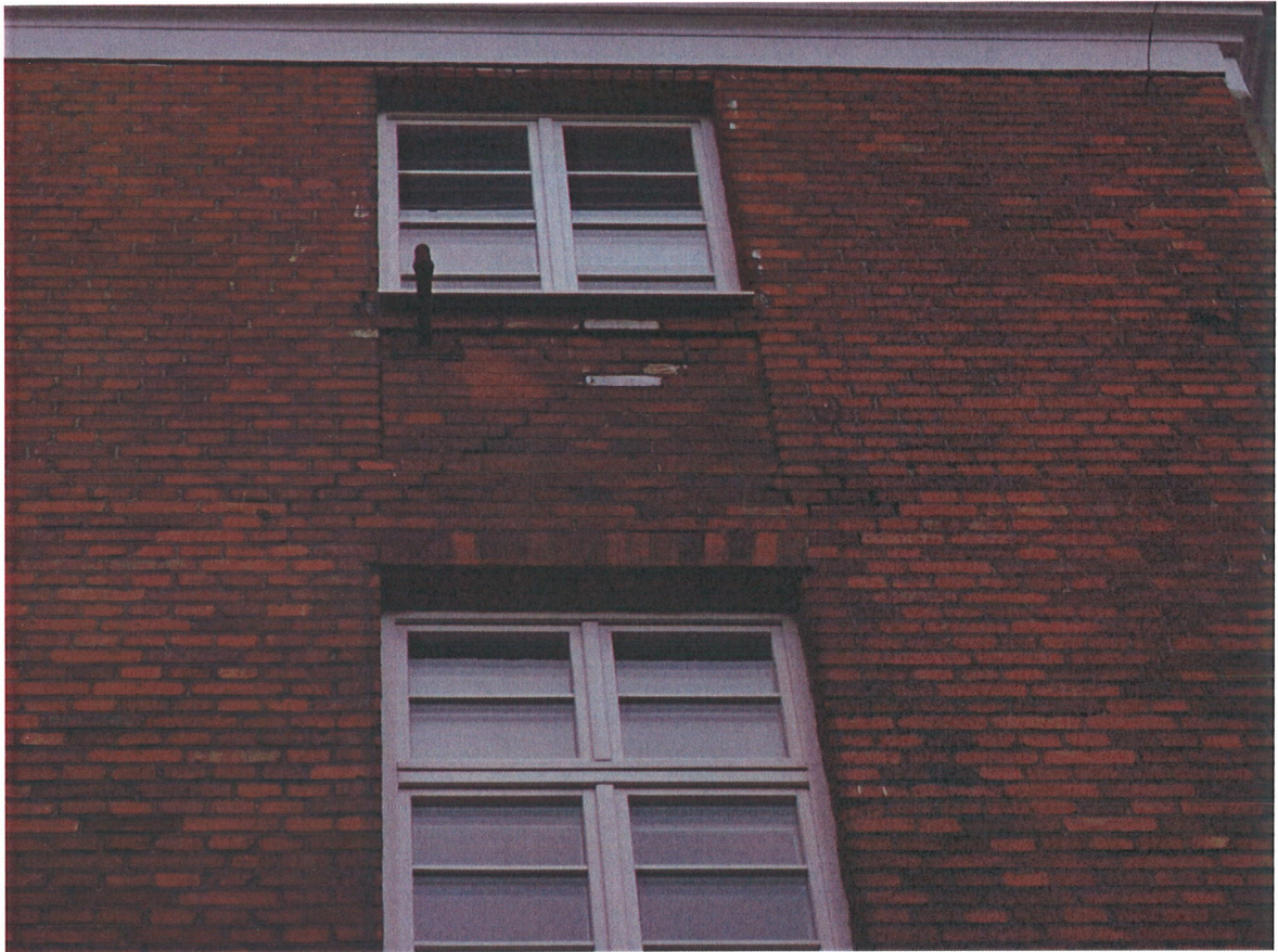
Pęknięcie ukośne pod oknem trzeciego piętra
