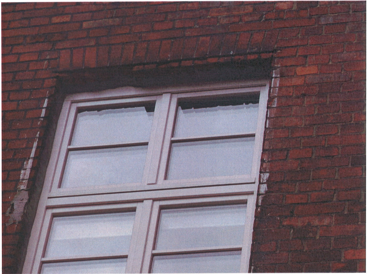
Reprezentatywne zniszczenia wokół ościeża- cementowe kity, resztki kleju i zdezastowane nadproże
