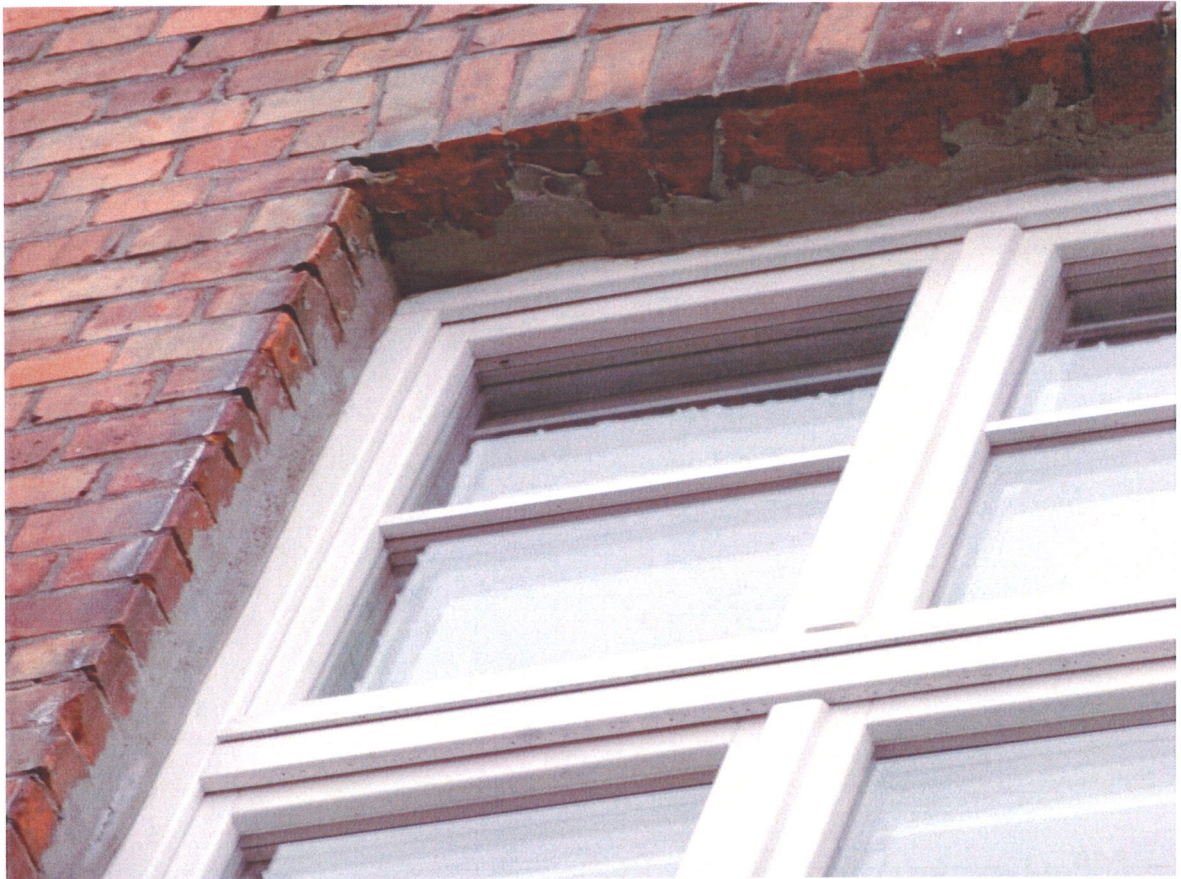
Modelowe przekształcenie lica ościeża ceramicznego przez kity cementowe
