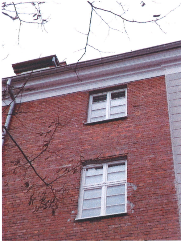
Współczesne uzupełnienia cegieł. Kity cementowe i zdewastowane nadproże (szczelina po blacharce)
