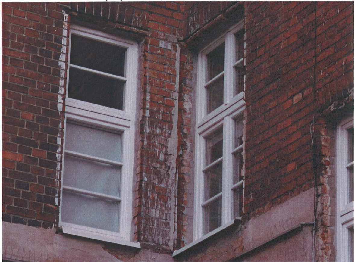
Nawarstwienia farby i cementu na licu ceramicznym
