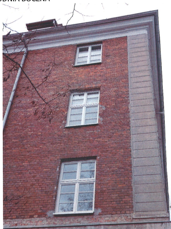
Fasada wschodnia- ubytek gzymsu ponad boniowanym parterem
