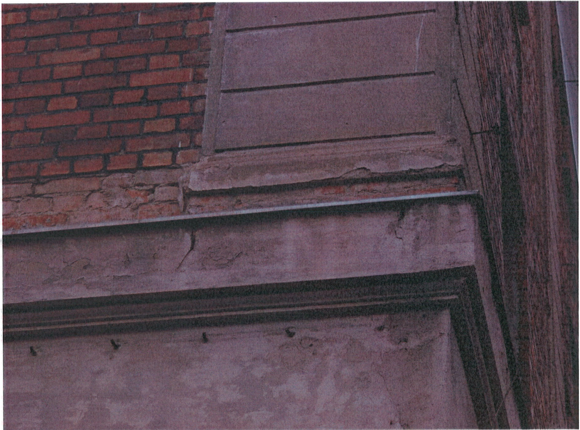
Naroże Ubytek wypraw sztukatorskich i dyble po mocowaniu instalacji
