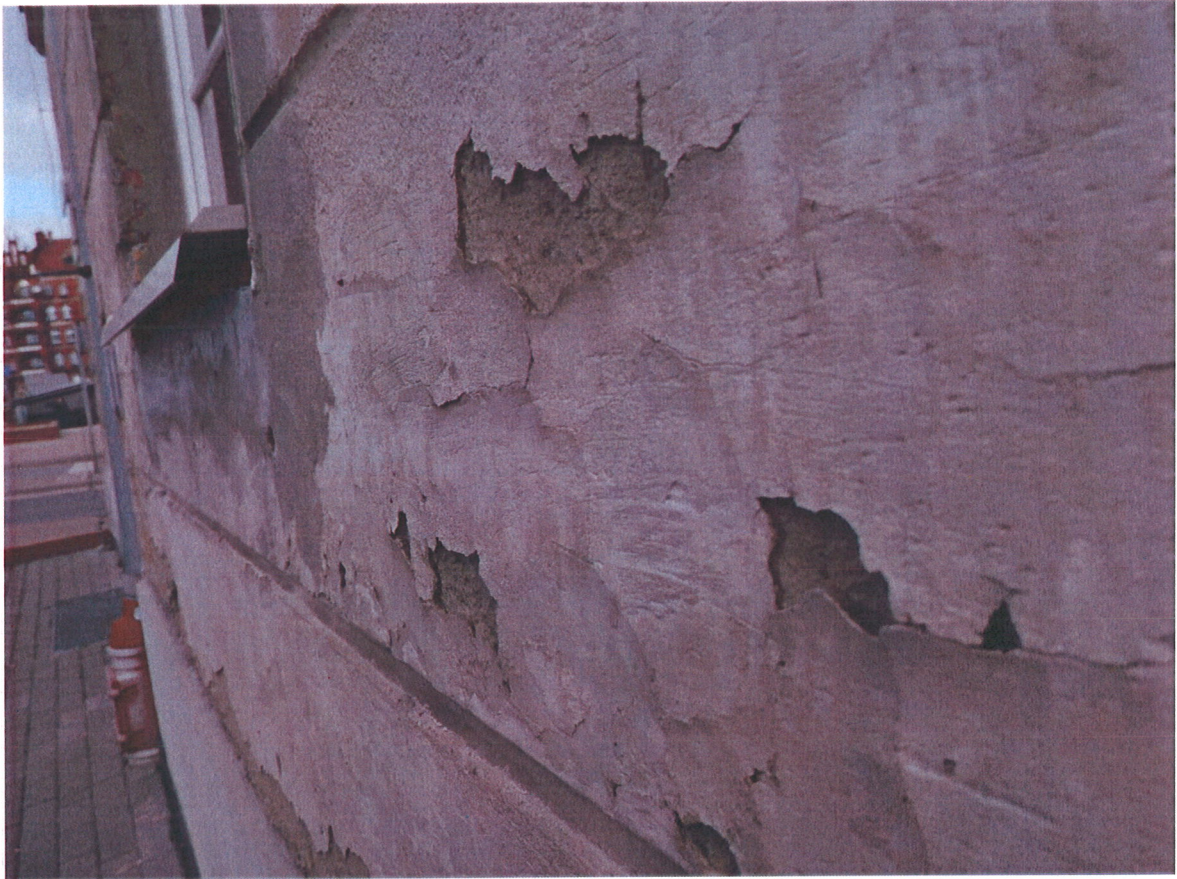
Stan zachowania wypraw parteru
