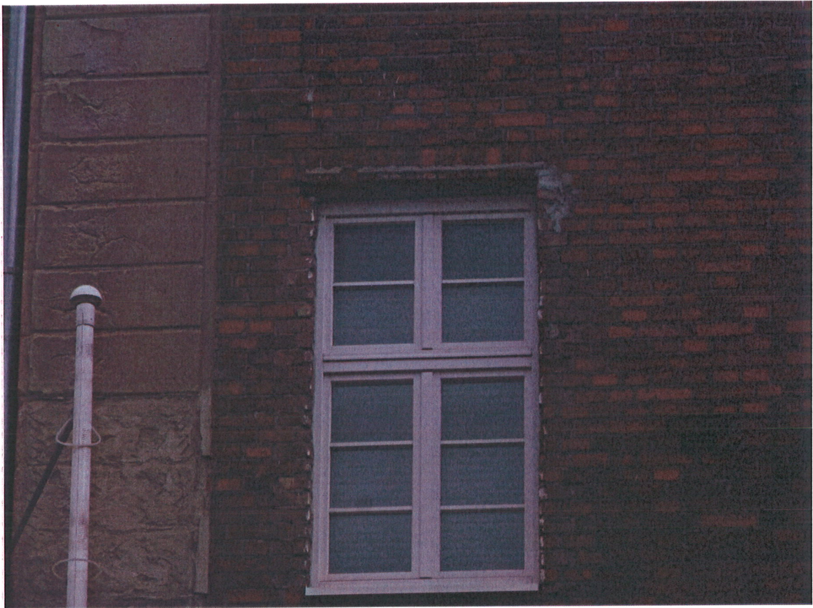
Stan zachowania ościeża kity cementowe i klawiszujące cegły
