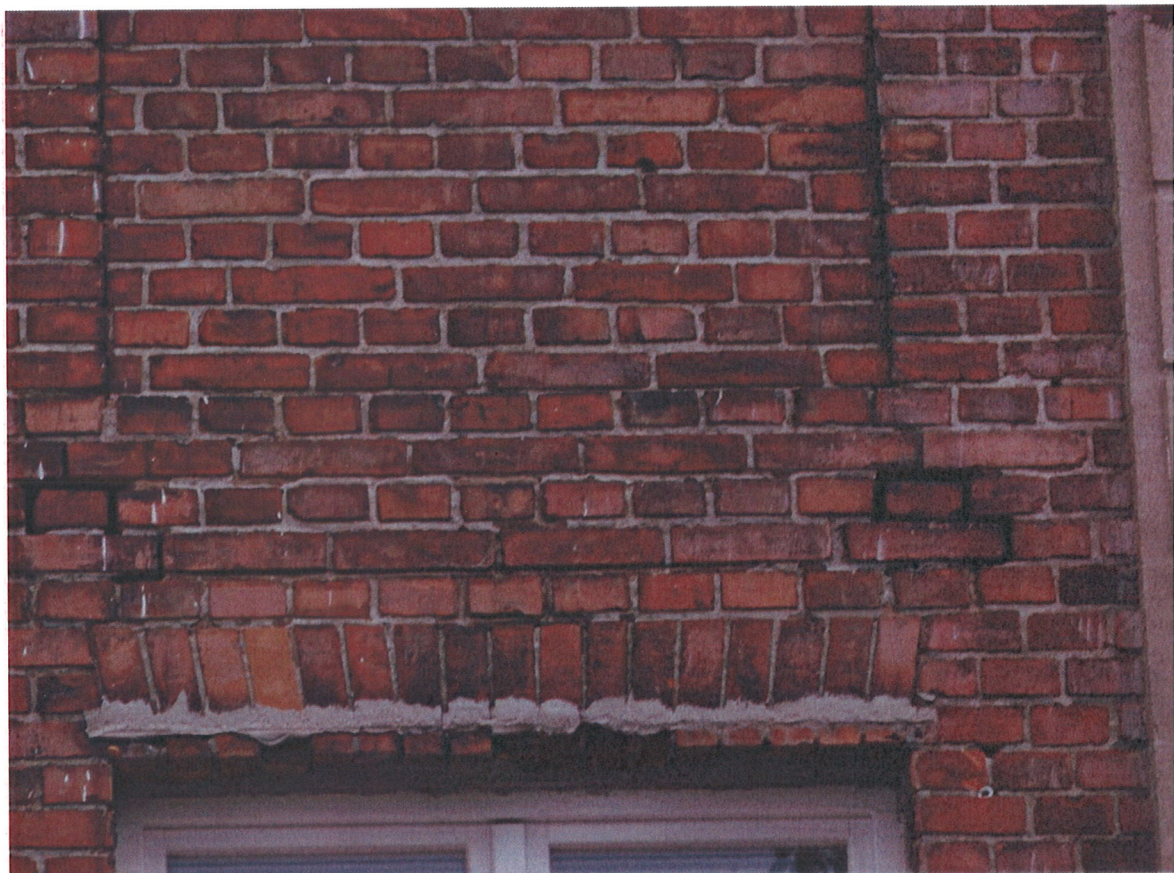
Przecięte nadproże z kitami cementowymi i klawiszujące cegły
