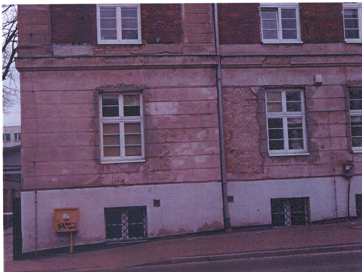
Stan zachowania przyziemia
