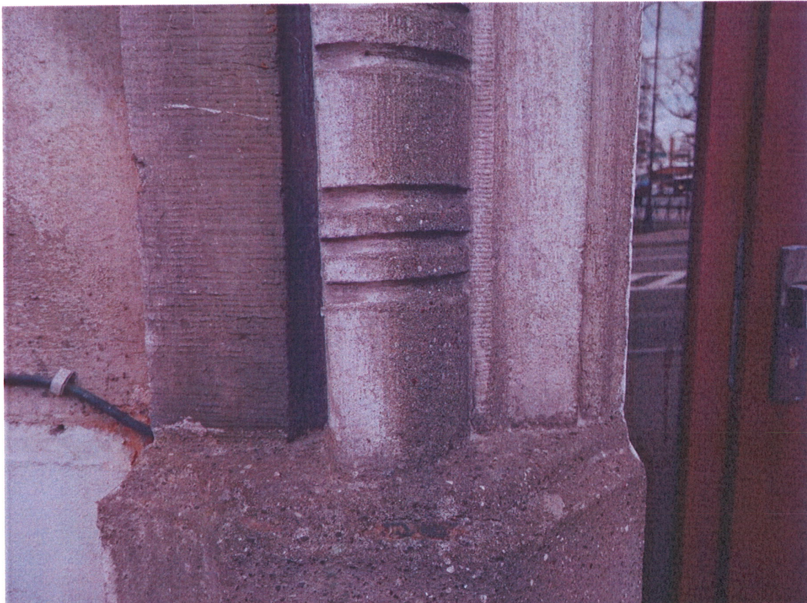
Detal portalu widoczna erozja części cokołowej
