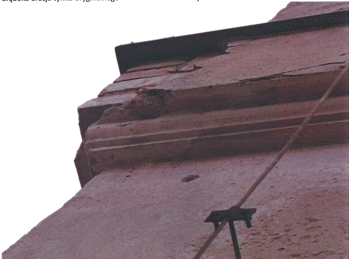
Gzyms nad parterem stan zachowania i przykład profilu do zachowania
