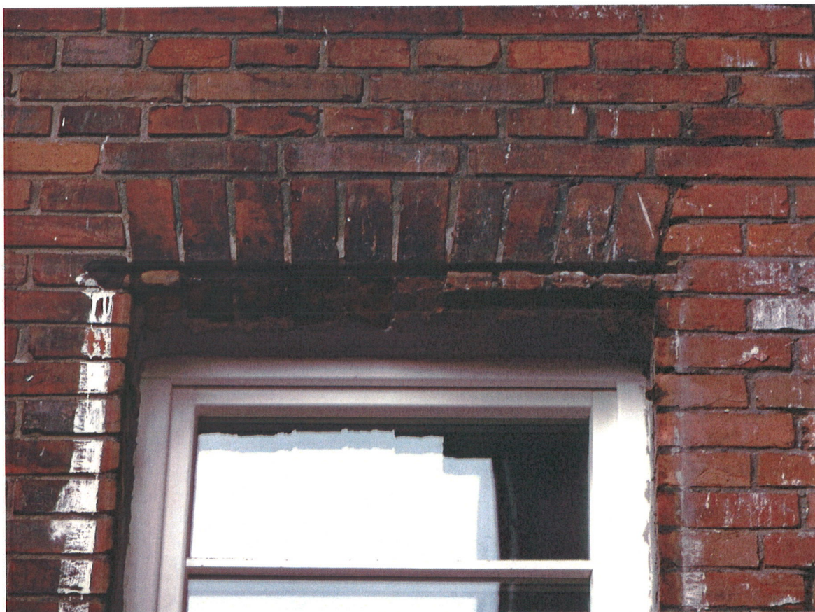
Pierwsze piętro Reprezentatywne zniszczenia wokół ościeża- cementowe kity, resztki kleju i zdewastowane nadproże
