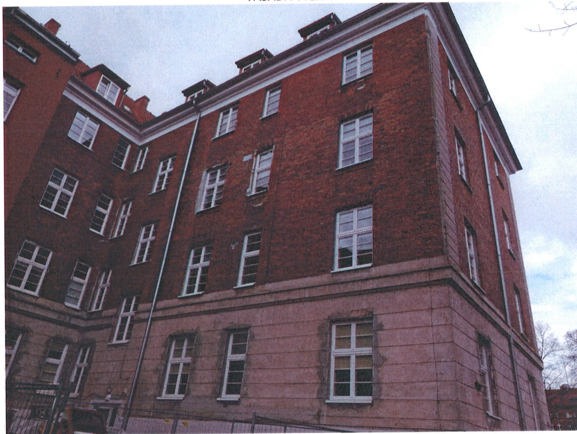
Fasad widok ogólny – Widoczne liczne kity cementowe i uszkodzenia lica ceramicznego
