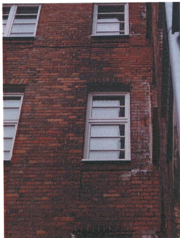
Erozja lica wątku ceramicznego wywołana zawilgoceniem i solami
