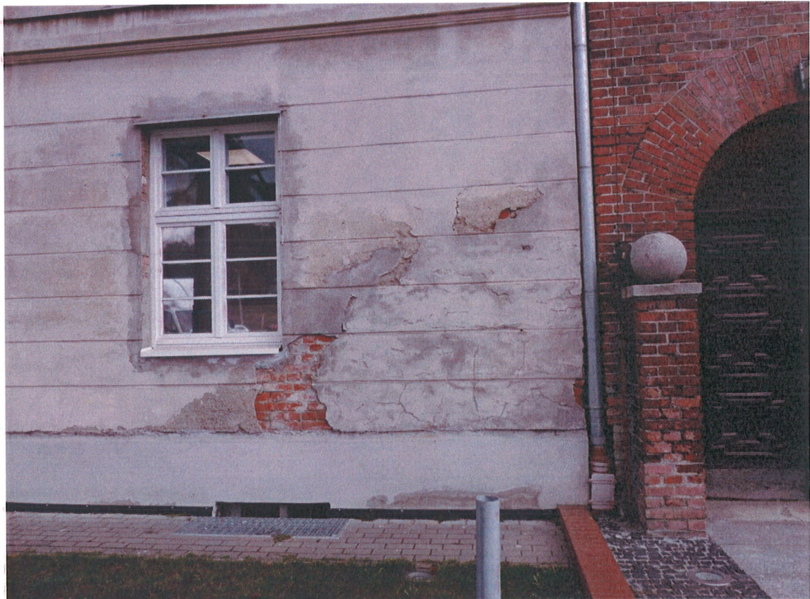
Parter stan zachowania boniowania widoczne rozległe współczesne kity i uzupełnienia
