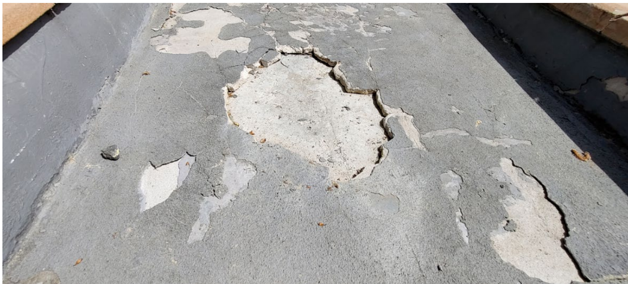
Fot. 30 Odspojenia okładziny szpachlowej w korycie rzeczki
