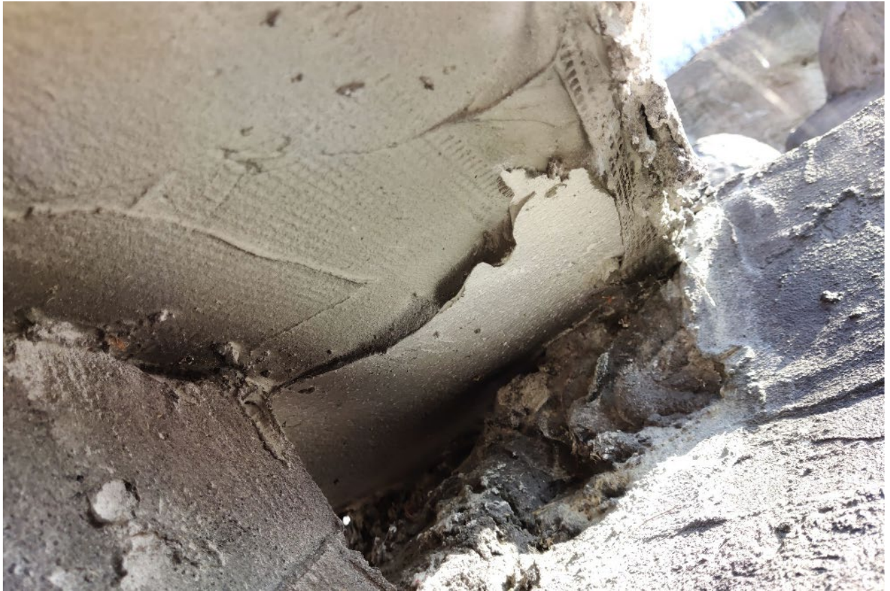
Fot. 21 Wadliwe i niechlujne wykonanie warstw szpachlowych
