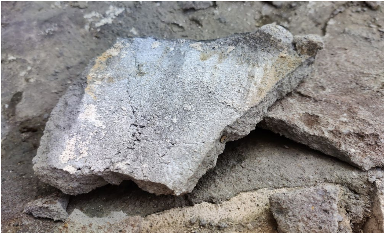
Fot. 17 Zniszczona i odspojona okładzina szpachlowa
