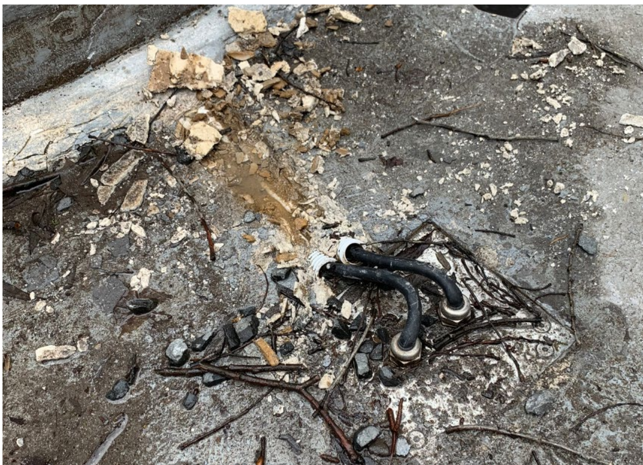
Fot. 3 Instalacje elektryczne wodospadu niskiego
