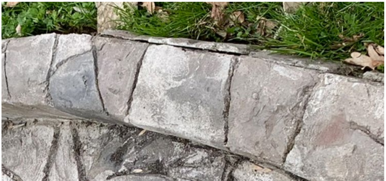
Fot. 34 Destrukcja okładzin rzeczki z atrakcjami
