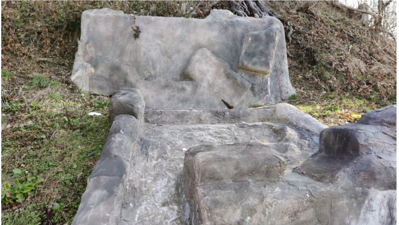
Fot. 9 Widok ogólny przyczółka górnego - widoczny biały osad na dnie
