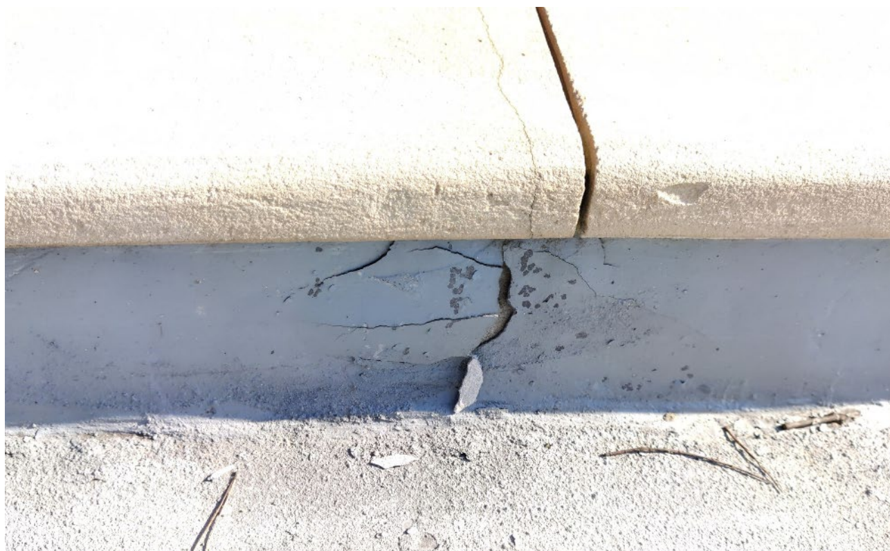
Fot. 27 Destrukcja okładzin. Pęknięcie konstrukcji koryta
