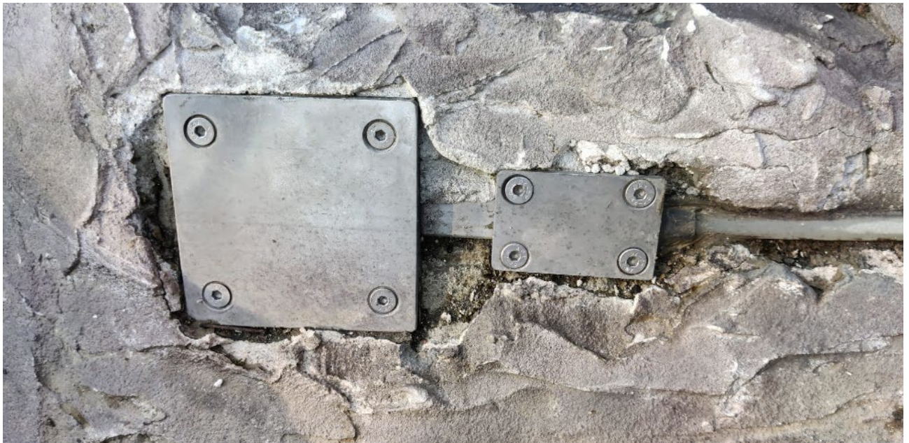
Fot. 22 Wadliwe osadzenie elementów wyposażenia
