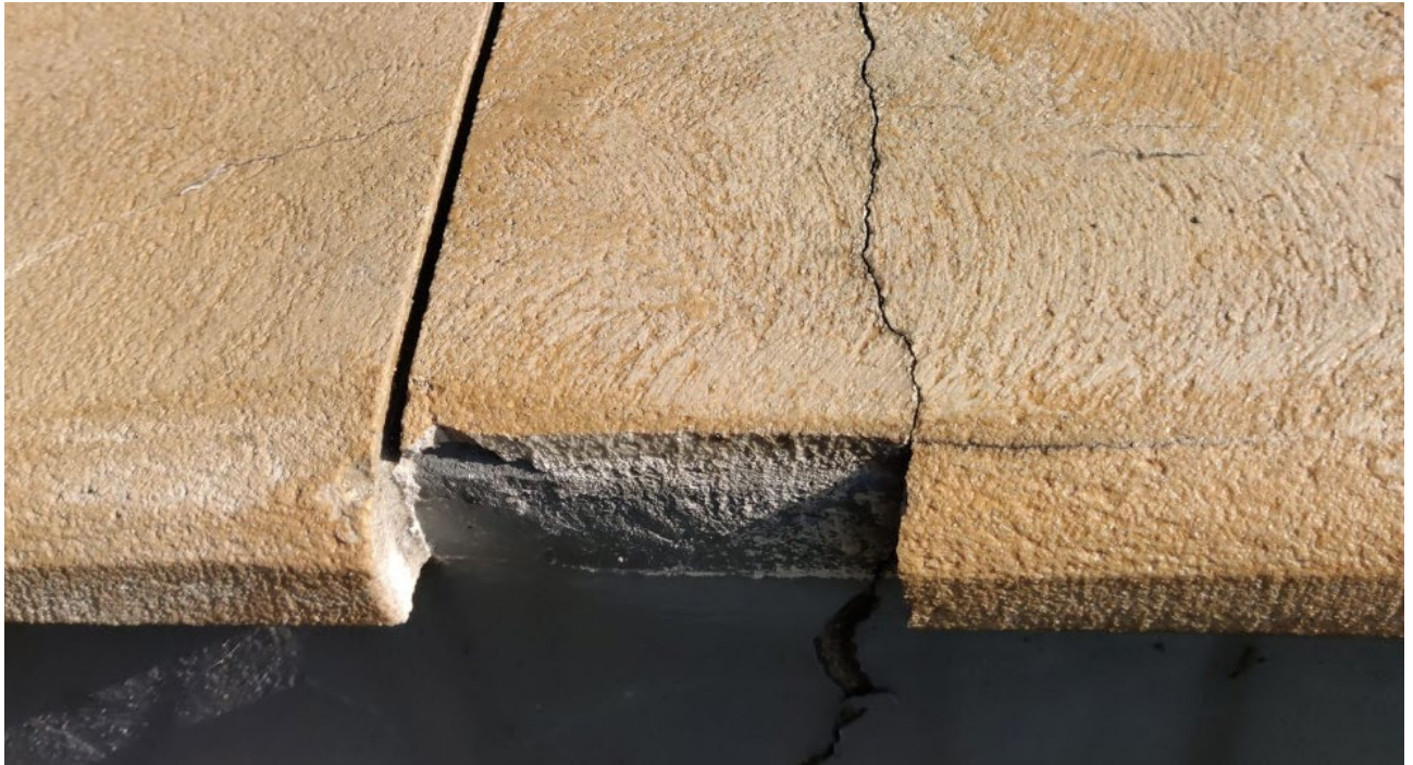
Fot. 28 Destrukcja okładzin zespołu oczek wodnych
