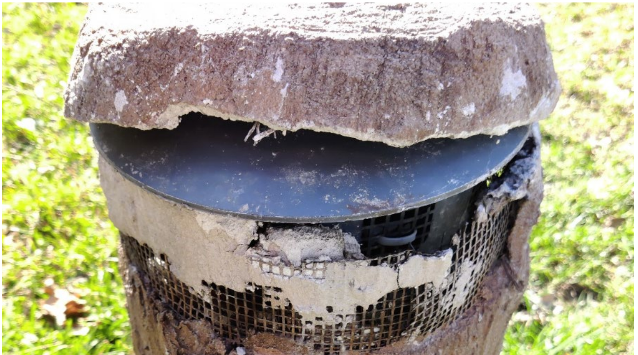
Fot. 7 Destrakcja okładziny kominków wentylacyjnych
