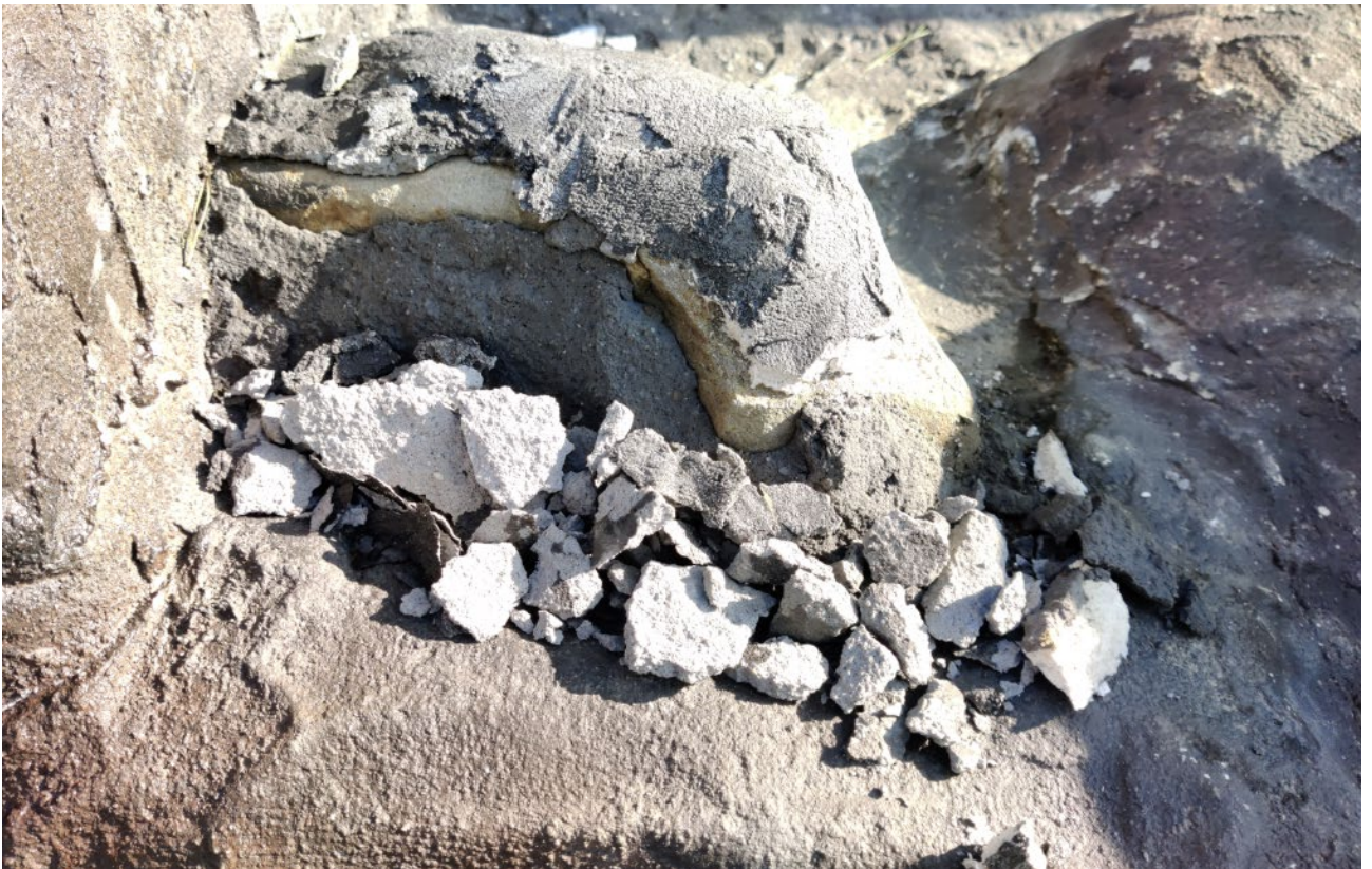
Fot. 14 Koryto "kamienne" wodospadu wysokiego - destrukcja masy szpachlowej, gruz z gazobetonu
