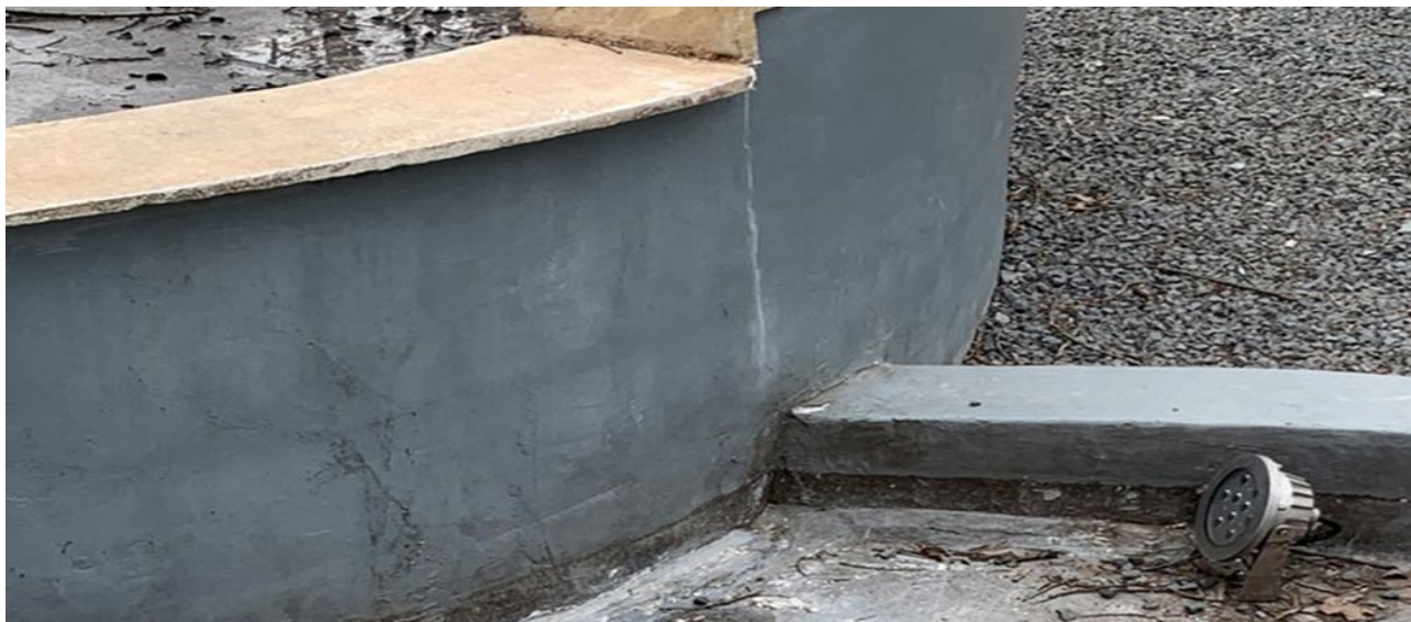
Fot. 4 Karbonatyzacja konstrukcji betonowej niecek
