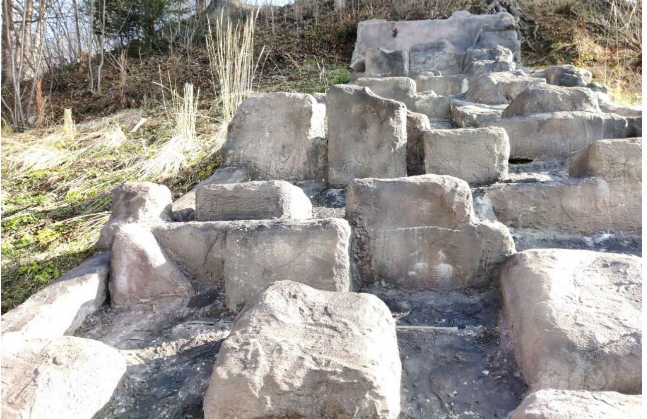
Fot. 13 Koryto "kamienne" wodospadu wysokiego - pęknięcia okładziny szpachlowej, wykwity węgla wapnia
