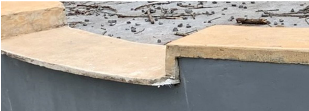
Fot. 2 Uszkodzenia nakryw wodospadu niskiego
