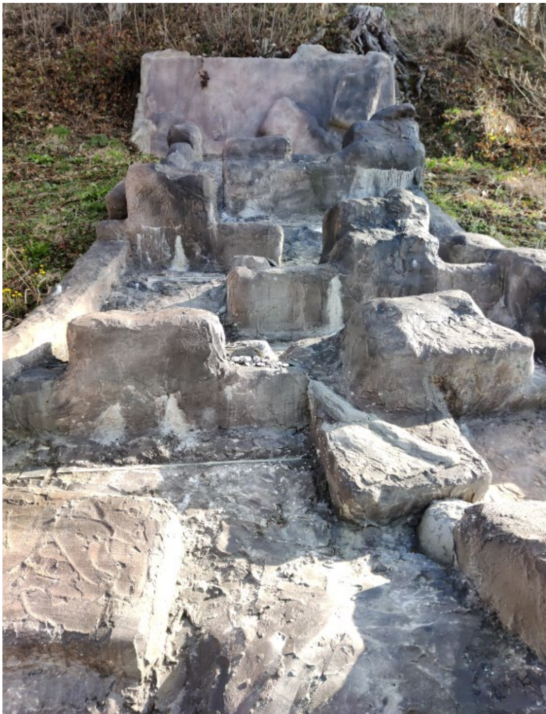
Fot. 15 Wodospad wysoki - wykwyty i wycieki węgla wapnia spod warstw szpachlowych
