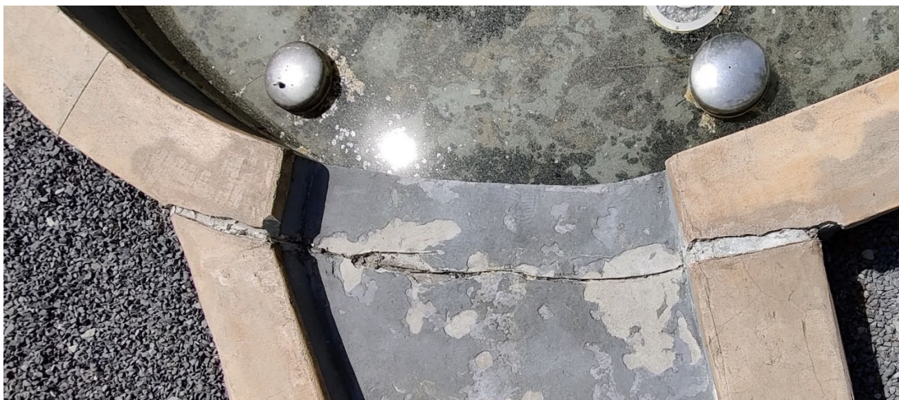
Fot. 25 Destrukcja okładzin w obszarze dylatacji
