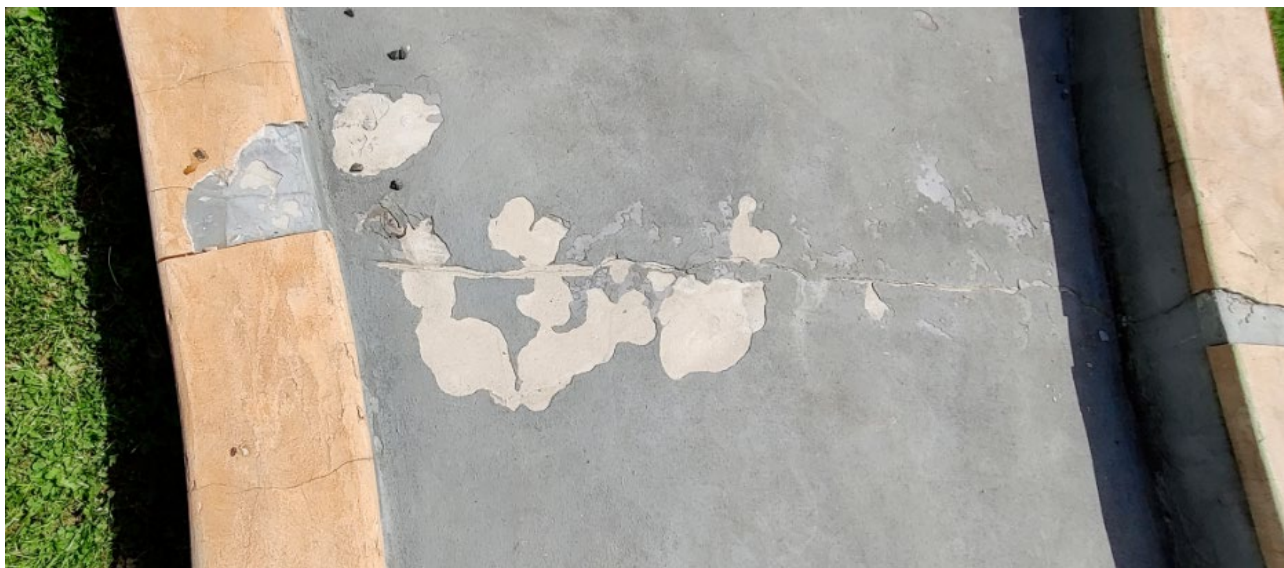
Fot. 31 Pęknięcie koryta rzeczki z destrukcją okładzin
