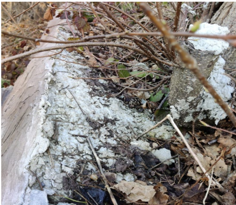
Fot. 10 Wady wykonawcze wykończenia górnej krawędzi przyczółka górnego - wadliwy materiał wadliwe wykonanie
