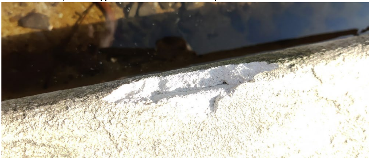
Fot. 6 Uszkodzenia okładziny niecki "Placu wodnego"
