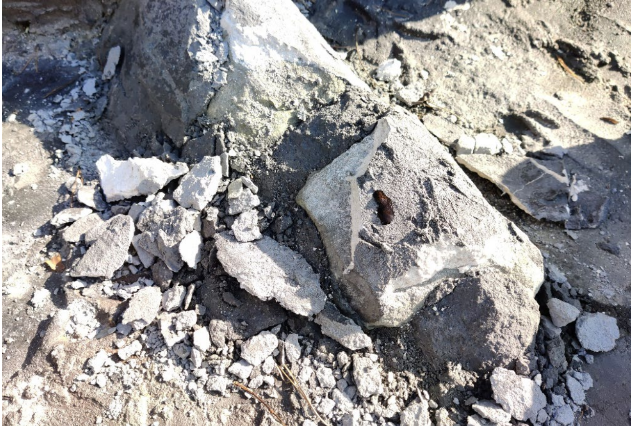
Fot. 16 Destrukcja materiału w korycie wodospadu
