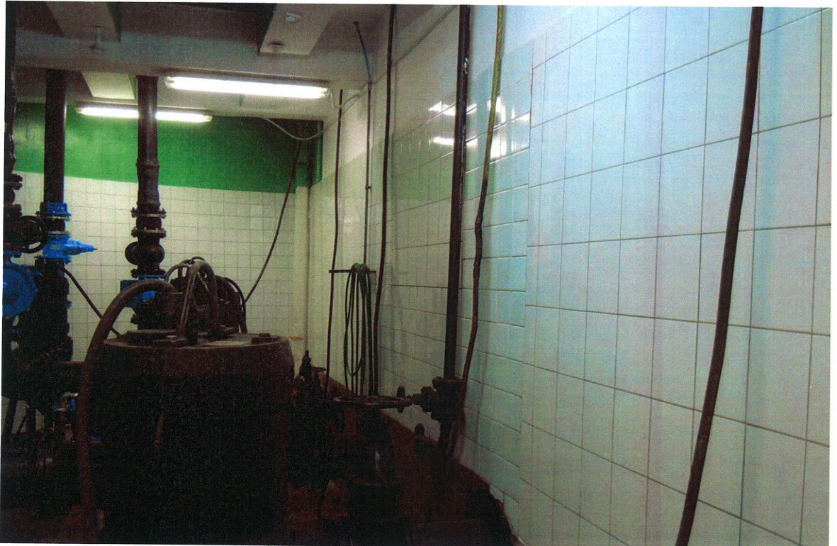
Pompownia centralna - komora pomp
