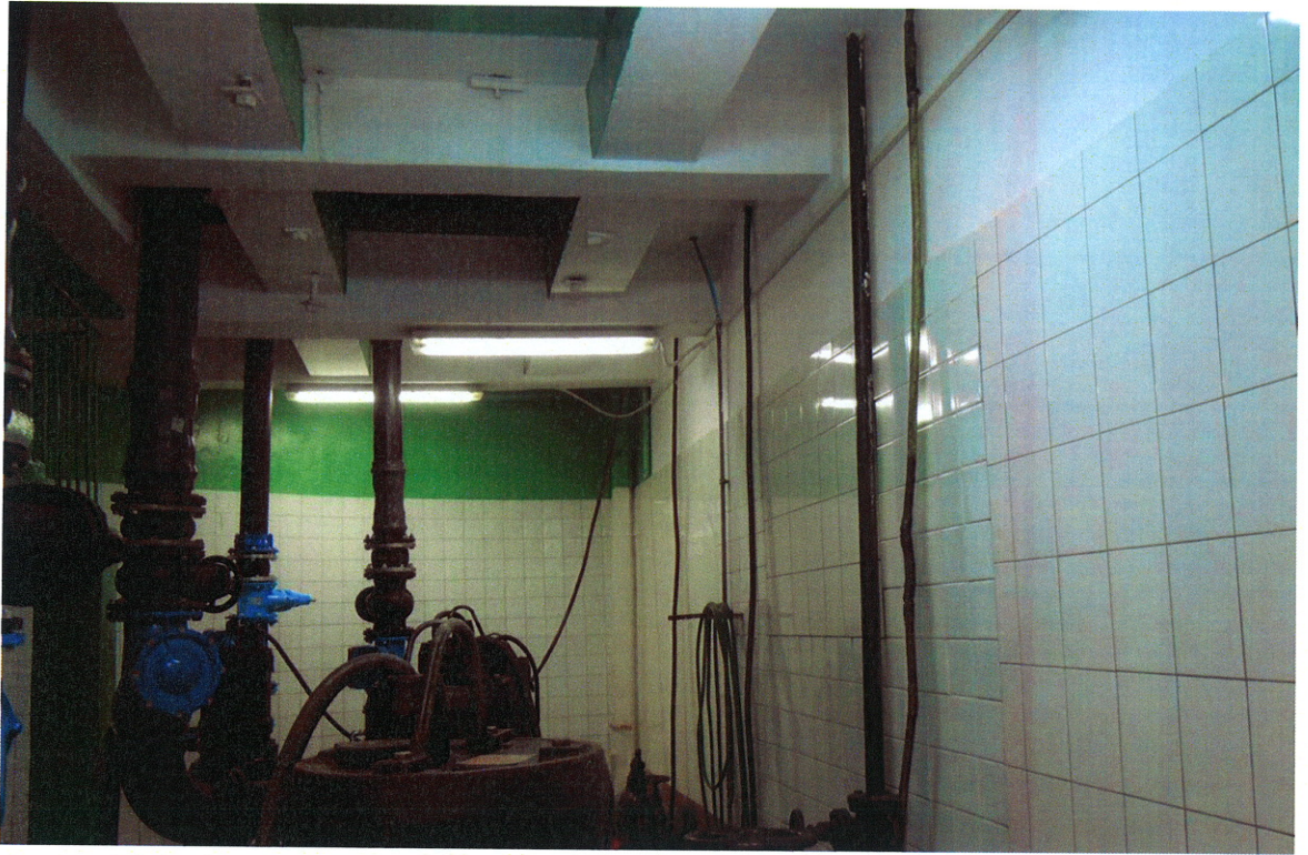
Pompownia centralna – komora pomp
