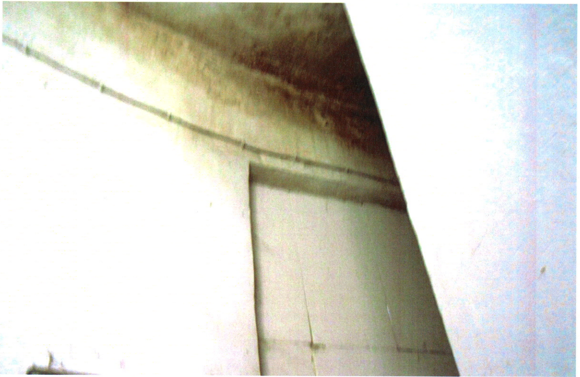
Pompownia centralna – ślad po kondensacji pary /zła izolacyjność stropu/
