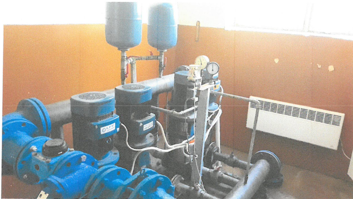
Zestaw hydroforowy wody na sieć
