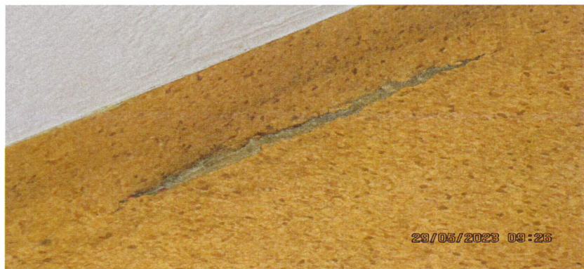
Fot.nr 01.Popękane łączenie cokolika z posadzką.
