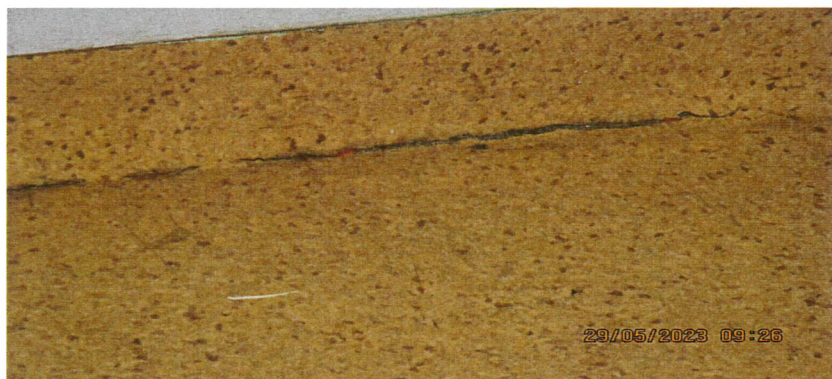
Fot. nr 02. Popękane łączenie cokolika z posadzką.
