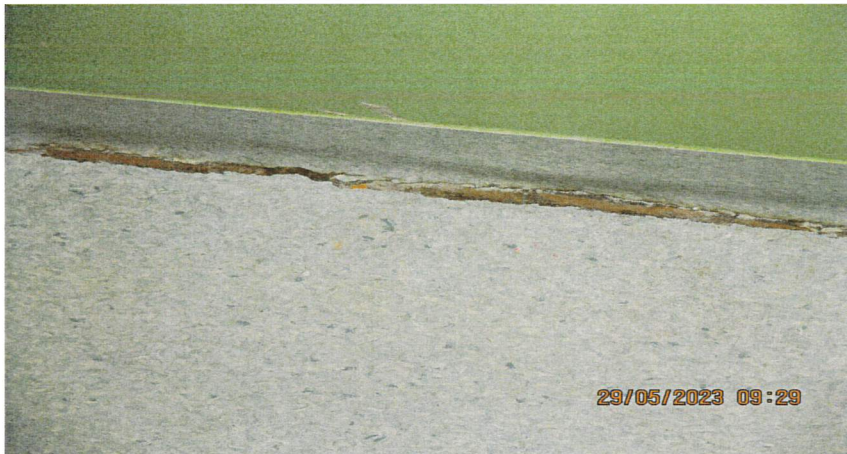
Fot. Nr 3. Popękane łączenie cokolika z posadzką.
